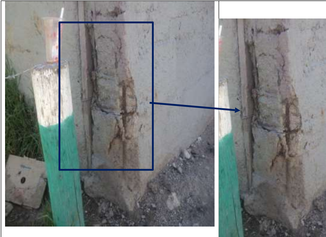
Fotografía 01: Corrosión en acero de la columna del cerco perimétrico de la institución educativa inicial Simón Bolívar.
