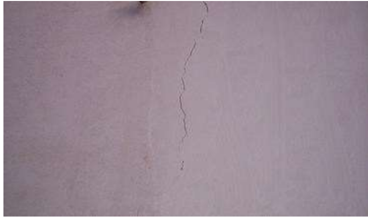
Figura 11. Fisura en muro.
