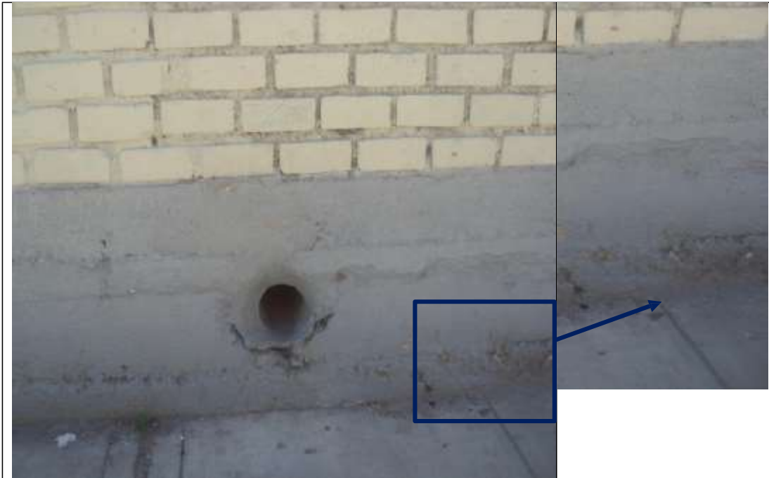
Fotografía 06: Erosión en sobrecimiento del cerco perimétrico de la institución educativa inicial Simón Bolívar.
