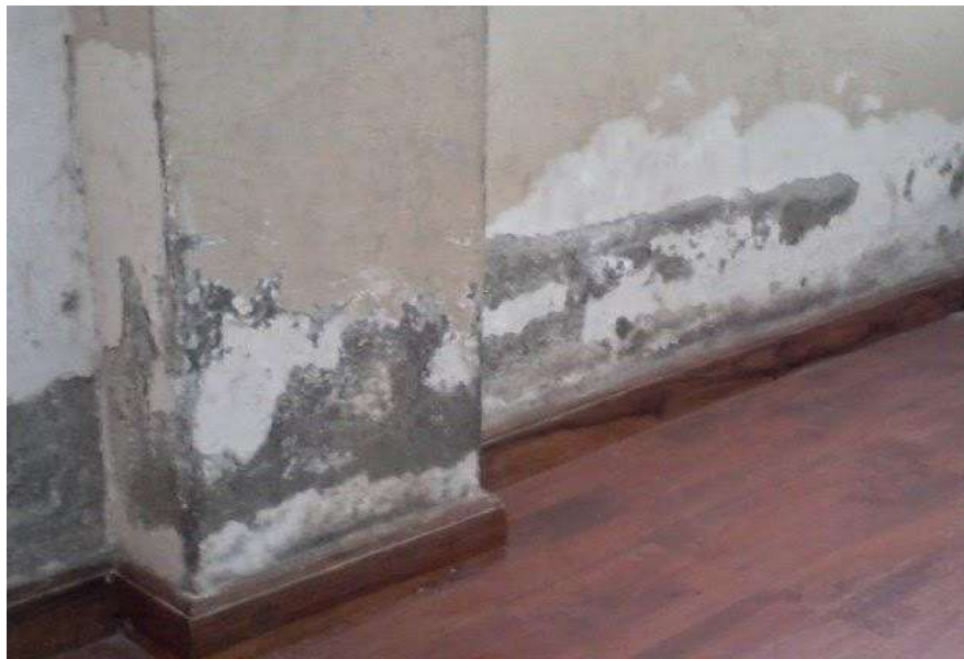
Figura 14. Eflorescencia en muro y columna.
