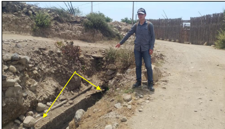
Figura 10: Línea de conducción del caserío de Virahuanca
