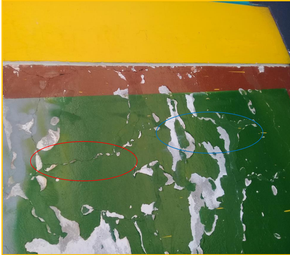
Se muestra las siguientes patologías: fisura , descascamiento
