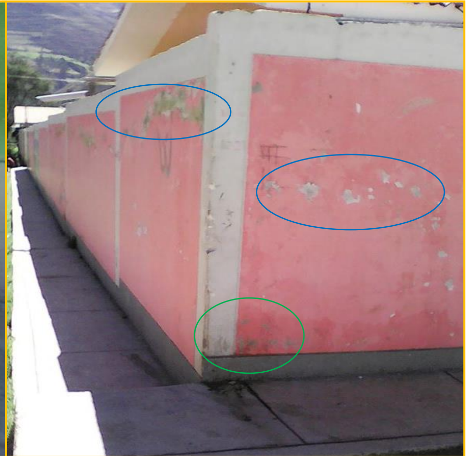
Se muestra las siguientes patologías: descascamiento , suciedad
