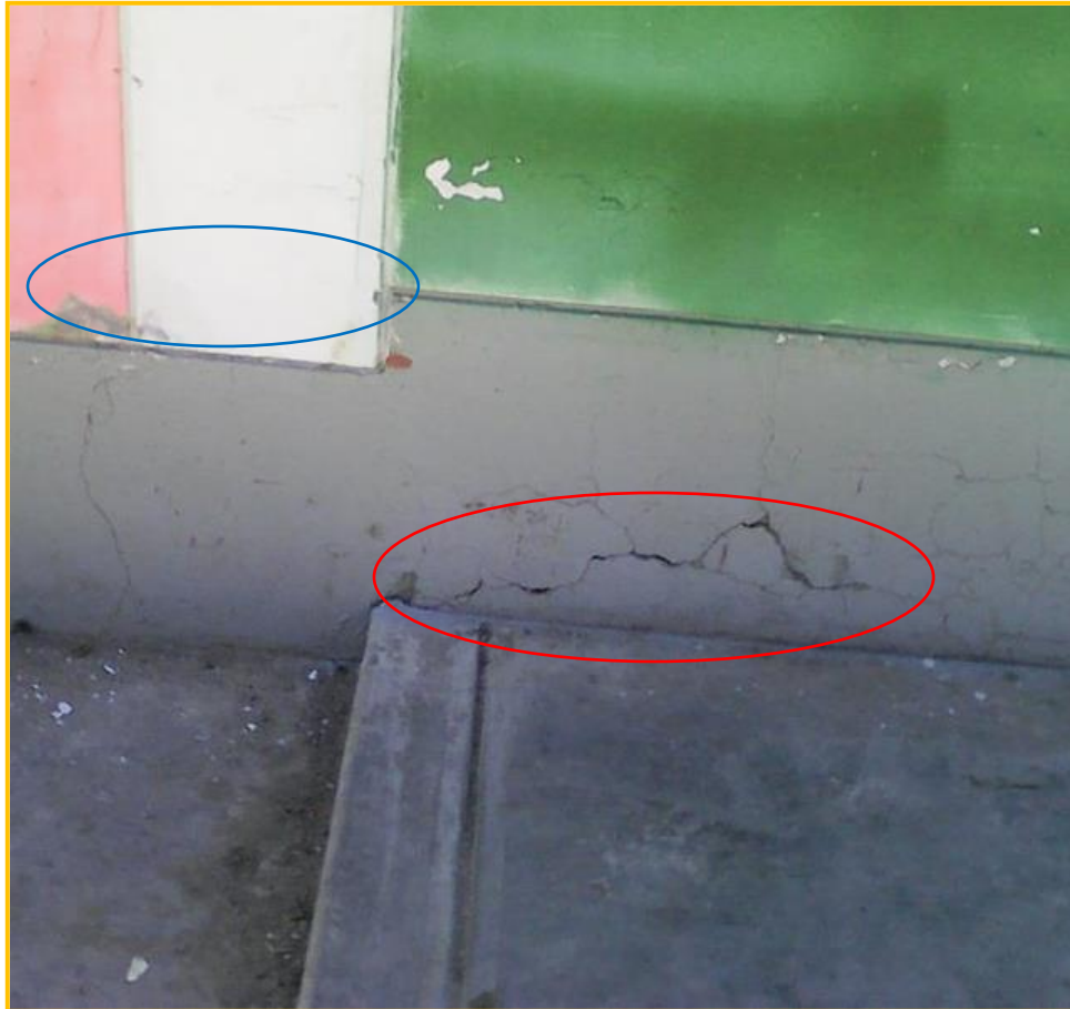
Se muestra las siguientes patologías: fisura , descascamiento
