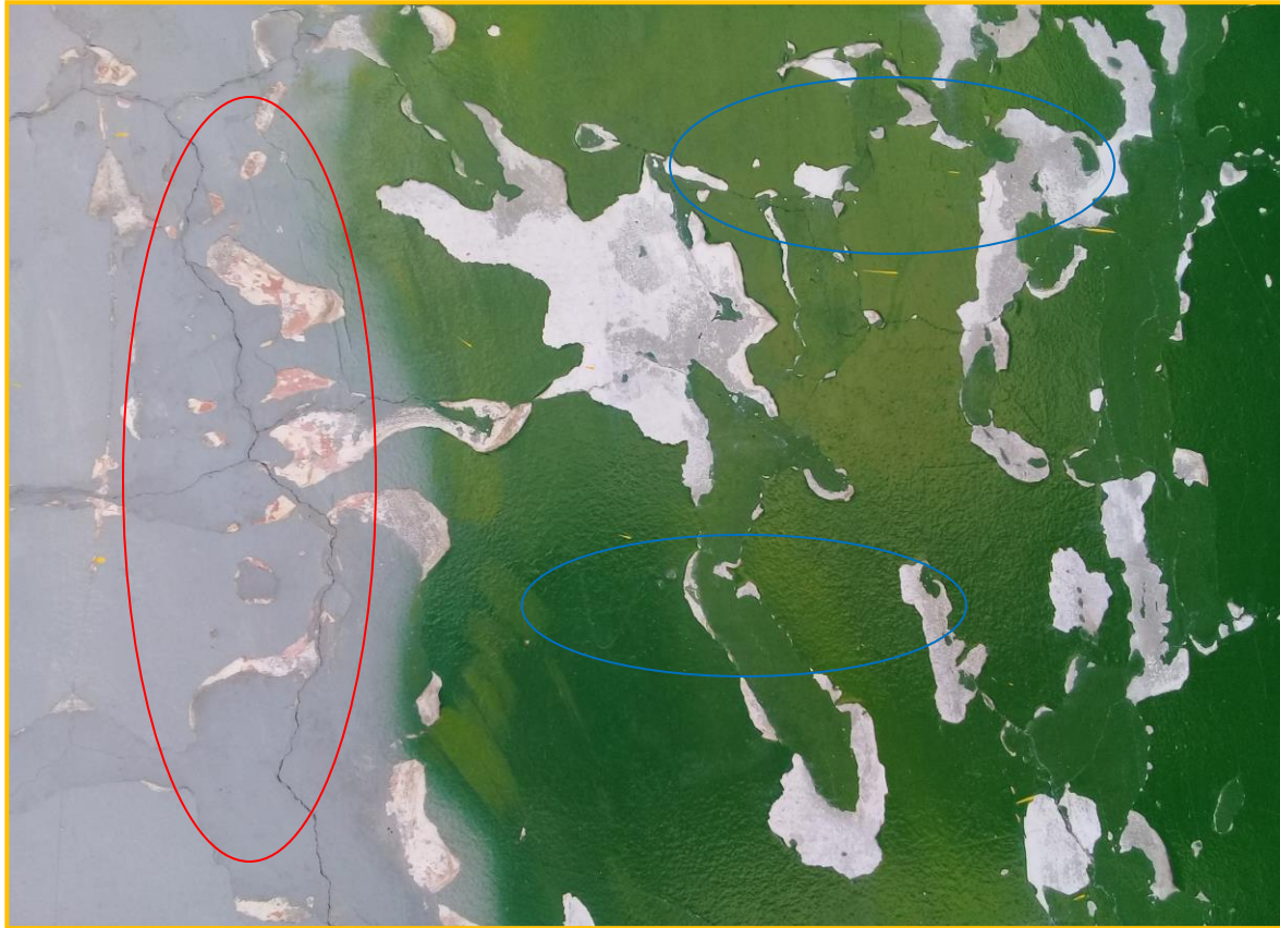
Se muestra las siguientes patologías: fisura , descaramien
