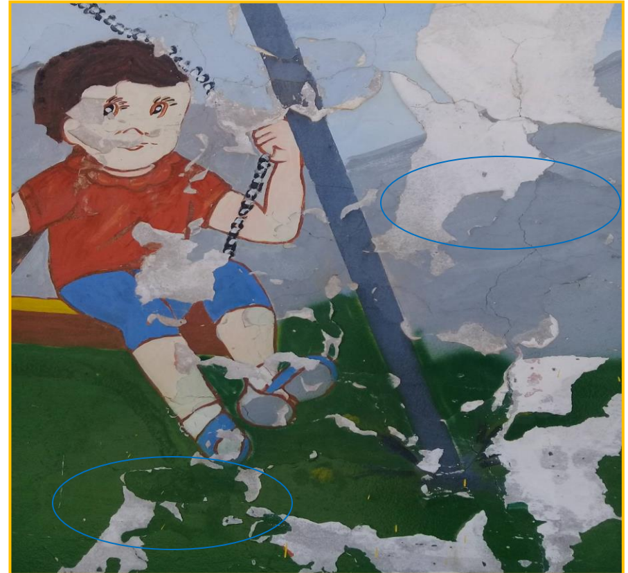
se muestra las siguientes patologías: descascamiento
