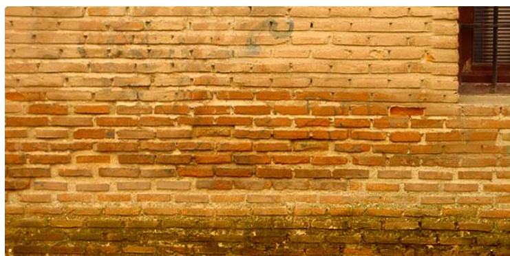
Imagen 04: Humedad por capilaridad en muro de ladrillo
