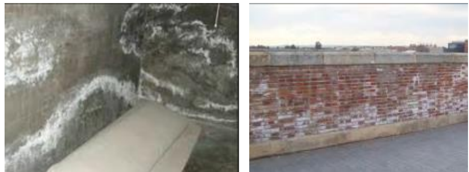
Imagen 09: Eflorescencias en muros perimétricos
