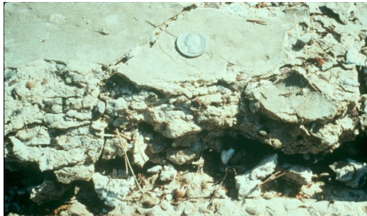
Imagen 12: Desintegración en concreto armado
