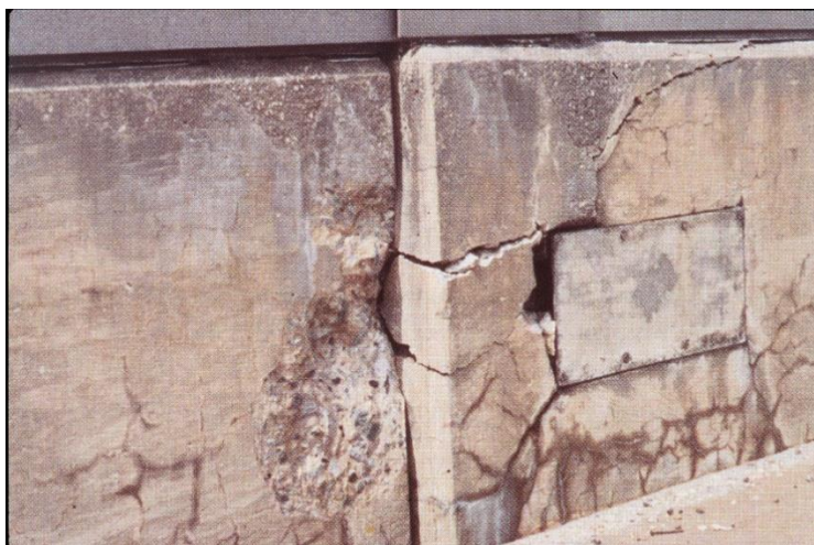
Imagen 13: Distorsión en estructuras de cimentación
