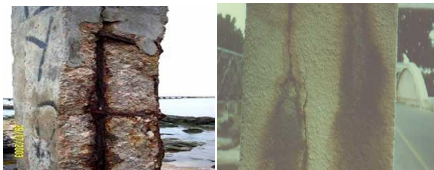
Imagen 01 y 02: Síntomas ó efectos de corrosión en concreto armado
