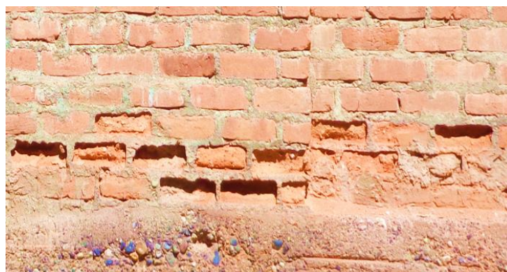
Imagen 17: Heladicidad en muros de ladrillo
