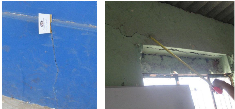
Imagen 11: Asentamiento diferencial reflejados en elementos estructurales (vigas)
