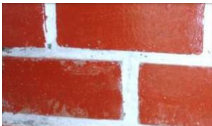
Imagen 15: Desconchamiento en muros de ladrillo
