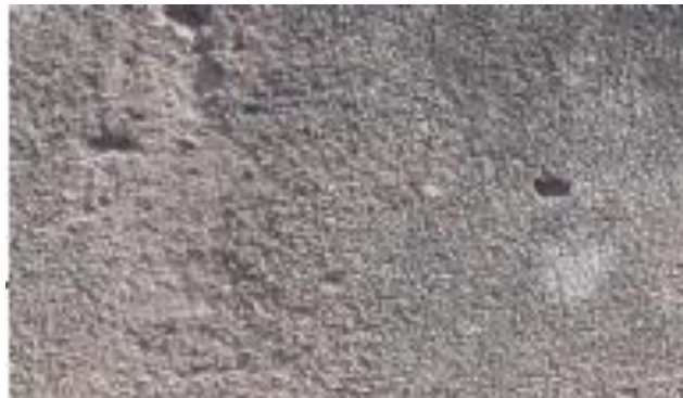
Imagen 06: Daños por picaduras en revoques
