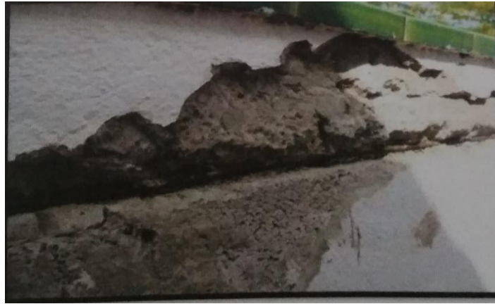
Imagen 16: Desprendimiento en vigas
