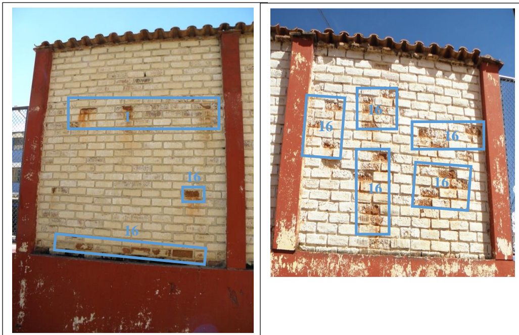
Fotografía 04: Heladicidad en muros de albañilería.
