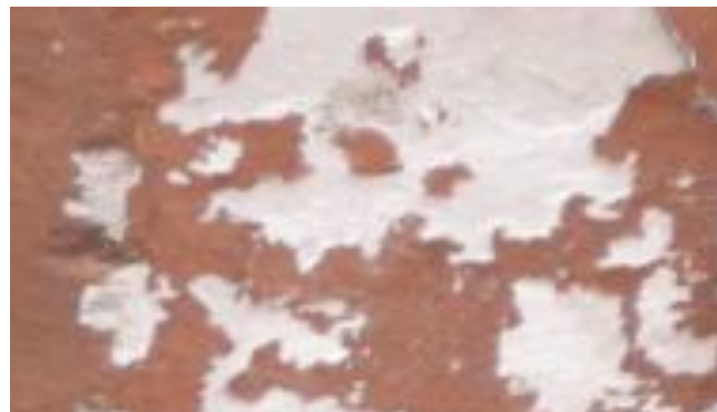
Imagen 08: Abultamientos y descascaramientos en revoques.
