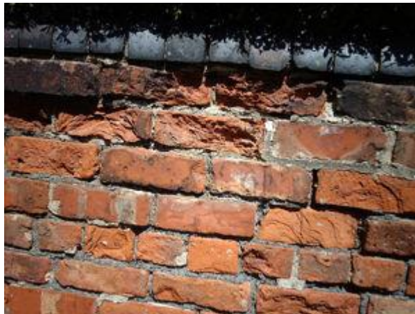
Imagen 10: Erosión en muros perimétricos
