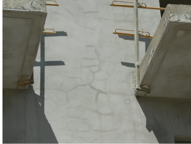
Imagen 03: Fisuras de retracción en mortero
