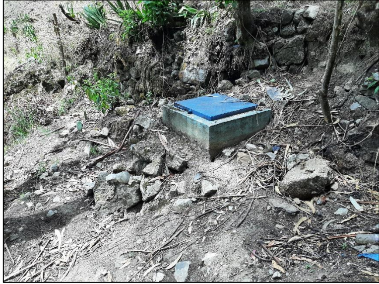
Fotografía N° 3 Vista de la cámara rompe presión tipo 6
