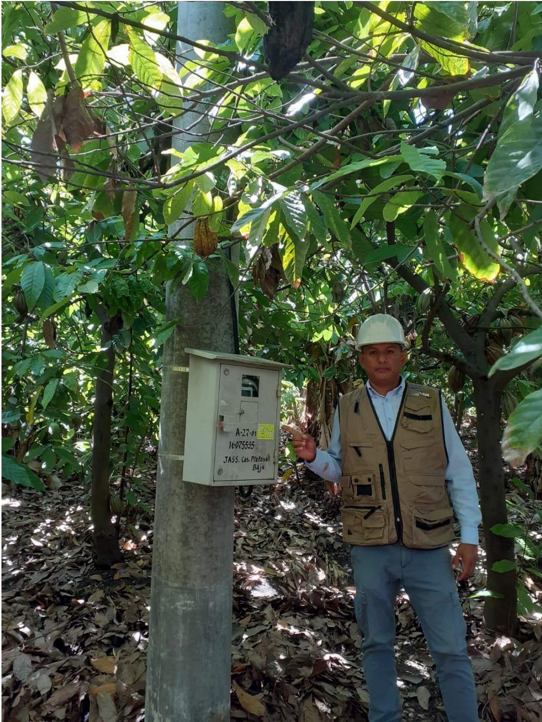
Imagen 15: Tablero de presión y caudal
