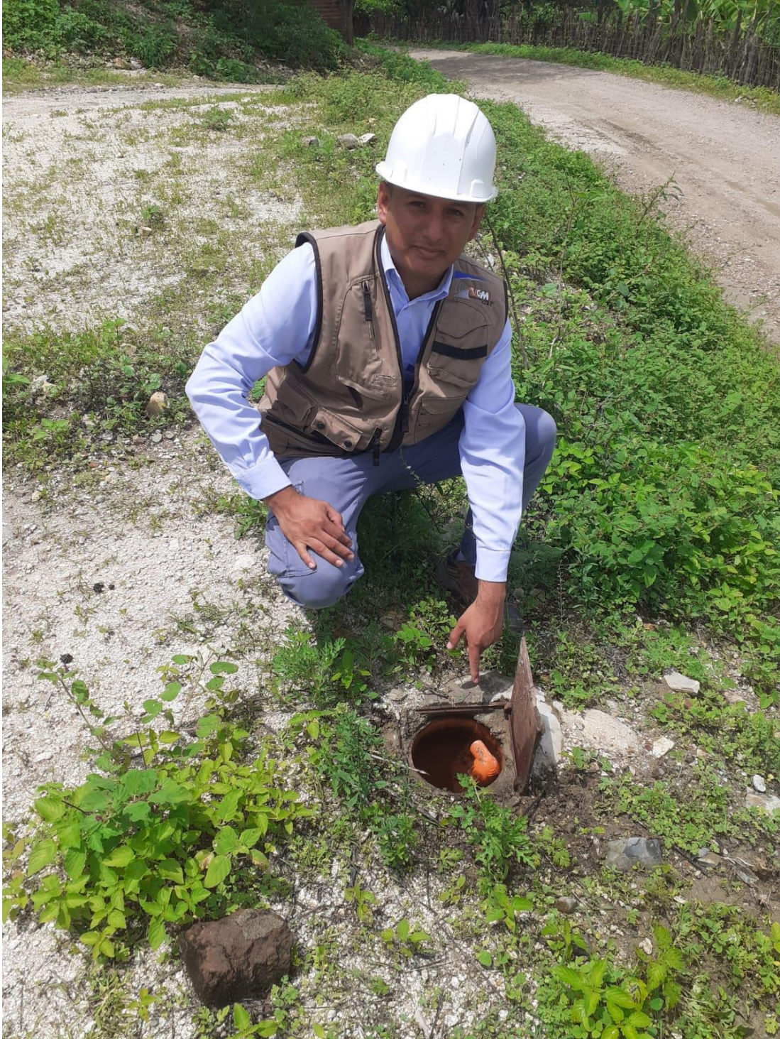
Imagen 11: Válvula de purga
