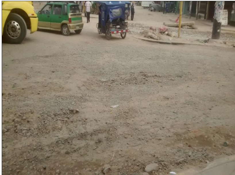
Imagen 18. Se observa el tipo de patología denominada Desprendimiento de agregados, Exudación.
