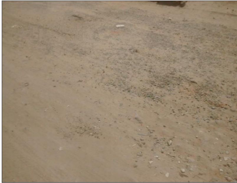
Imagen 22. Se observa el tipo de patología denominada Desprendimientos de agregados.
