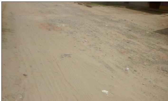
Imagen 7. Pulimento y desprendimiento del agregado.
