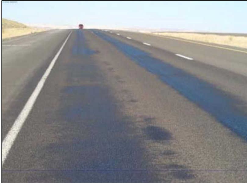
Imagen 2. Manchas en pavimentos flexibles (Exudación)
