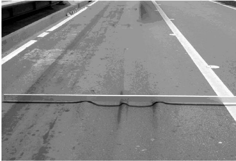
Imagen 4. Ahuellamiento en pavimento flexible.
