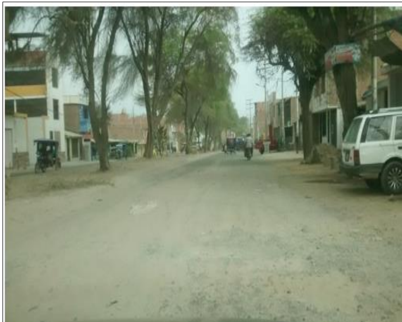
Imagen 17. Se observa el tipo de patología denominada Huecos, Baches.
