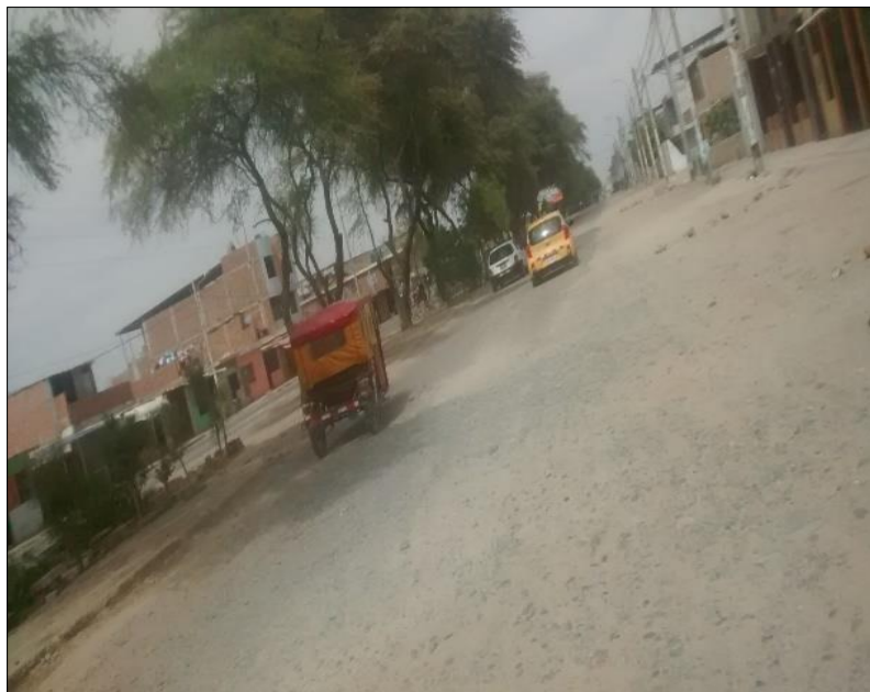
Imagen 19. Se observa el tipo de patología denominada Huecos.
