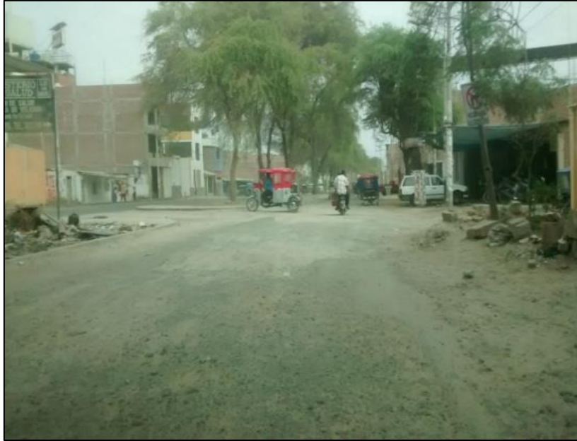
Imagen 14. Se observa el tipo de patología denominada Baches, Depresión en la AV. Don Bosco.
