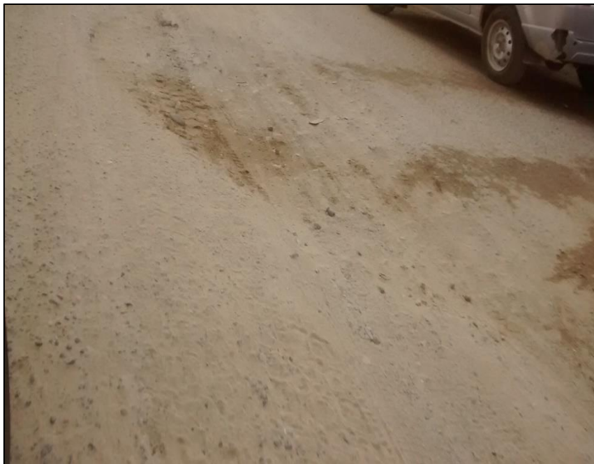
Imagen 23. Se observa el tipo de patología denominada Baches, Exudación, Desprendimiento de agregados.
