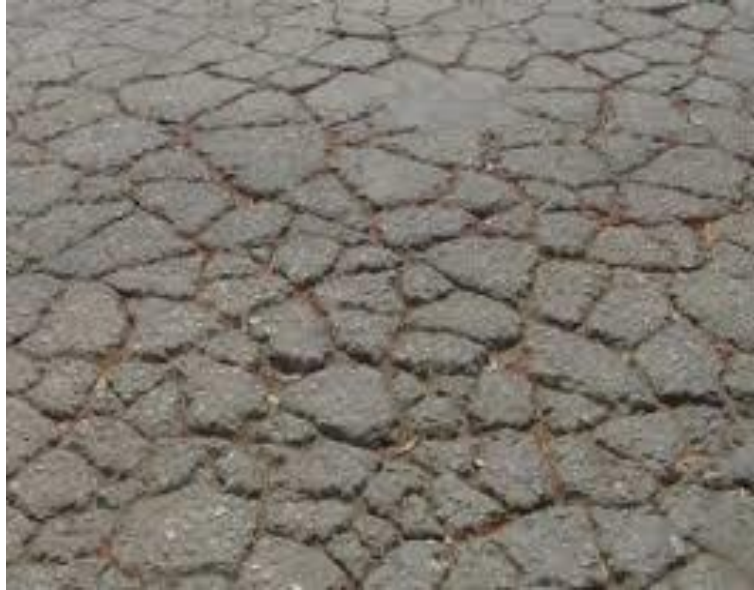
Imagen 1: Piel de cocodrilo en pavimento flexible.
