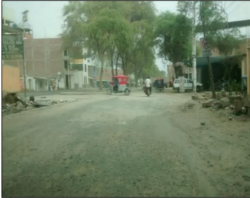
Imagen 16. Se observa el tipo de patología denominada Peladuras, Desprendimientos de agregados y Exudación.
