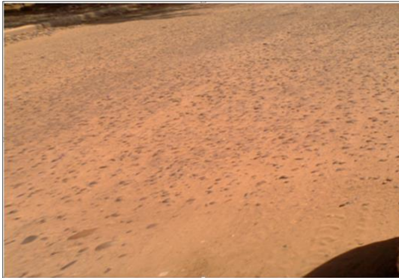
Imagen 15. Se observa el tipo de patología denominada Piel de Cocodrilo.
