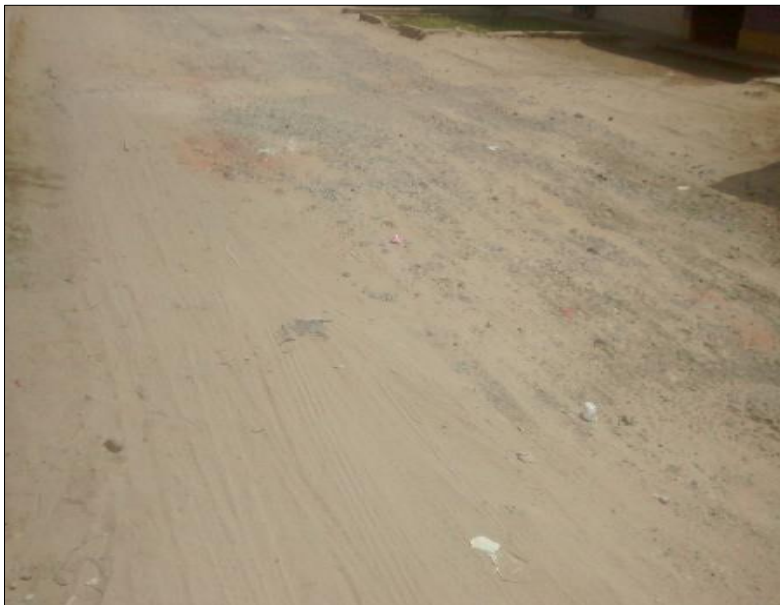
Imagen 21. Se observa el tipo de patología denominada Pulimiento de agregados, desprendimiento de agregados.
