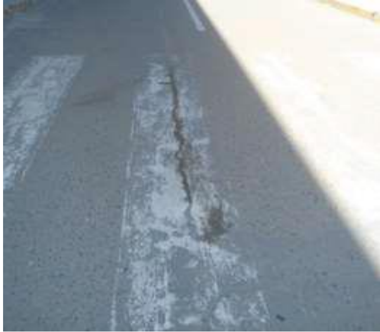
Imagen 3. Grietas de bloque o contracción.
