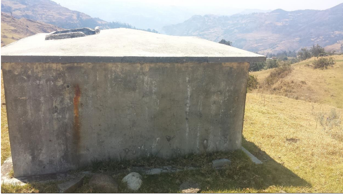
Fotografía 02: vista del reservorio de almacenamiento de agua potable
