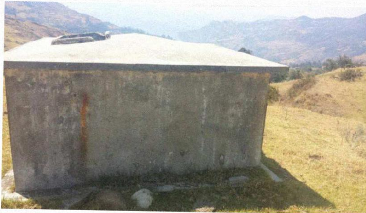
Foto N°01: Punto donde se encuentra el reservorio
