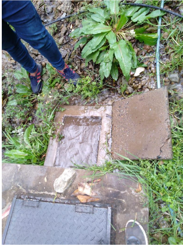
Fotografía 06: Cámara de captación del caserío Ninabamba
