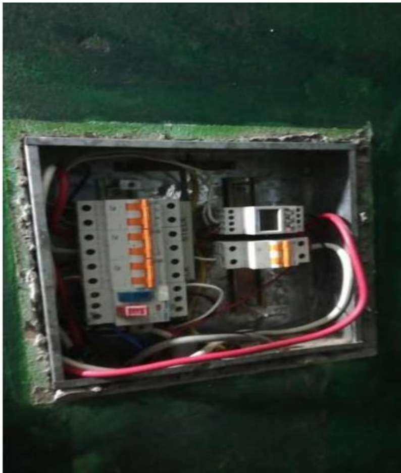
Imagen 9: Tablero eléctrico sin tapa
