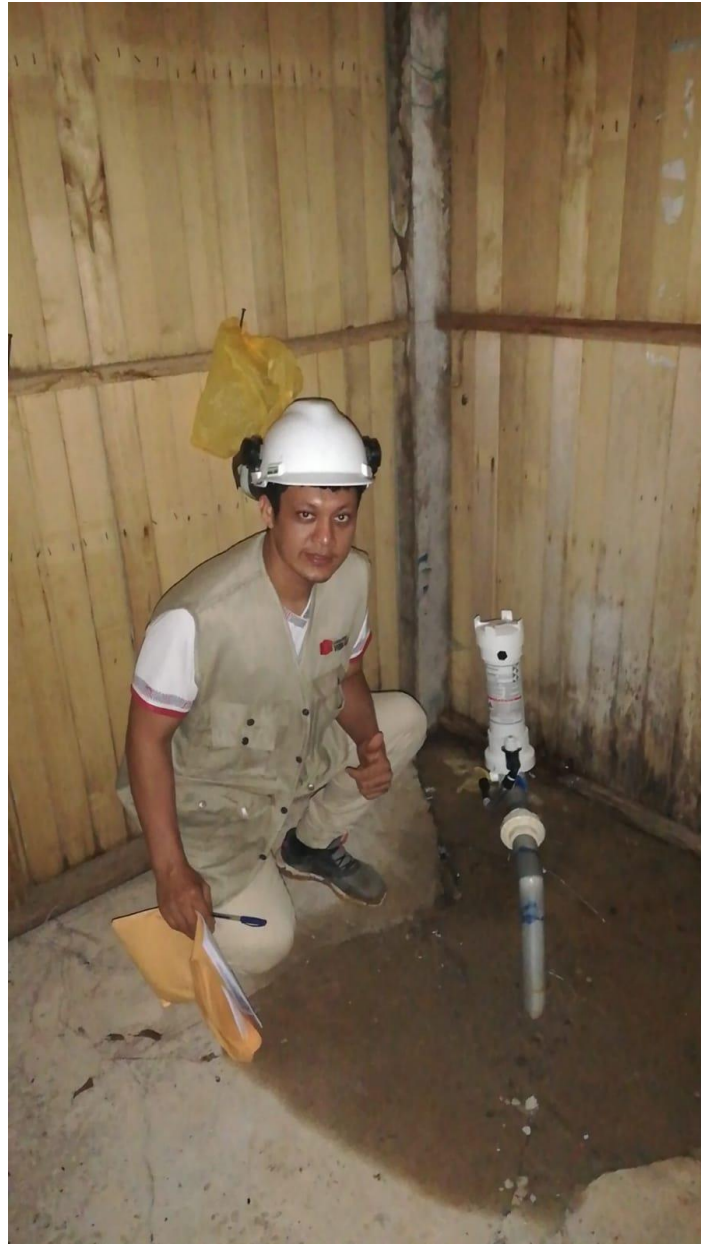
Imagen 4: Caseta de cloración
