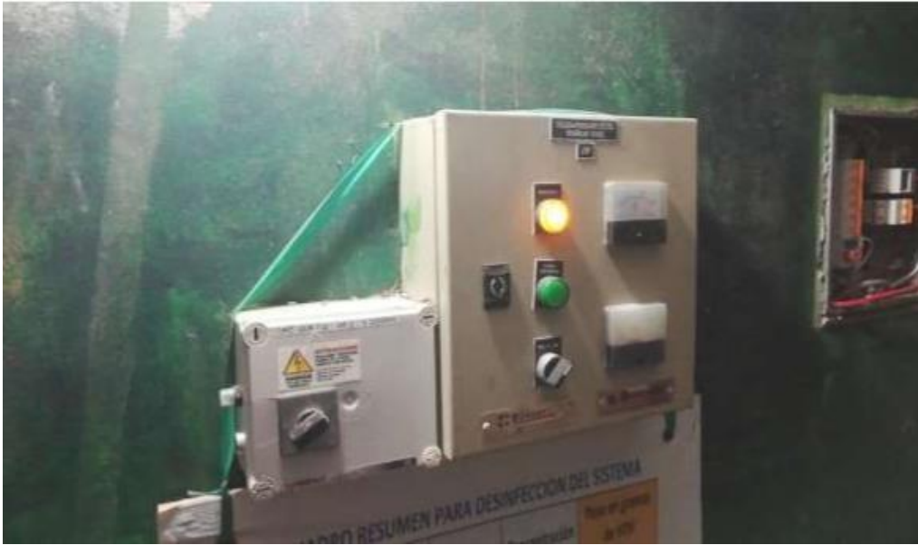
Imagen 8: Tablero de control de caudales
