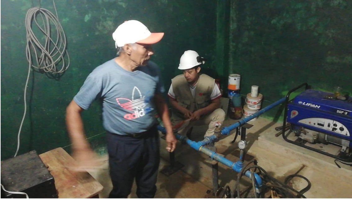
Imagen 6: Electrobomba y línea de aducción
