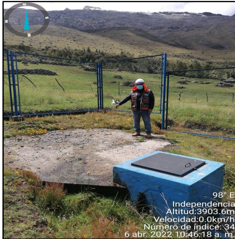
Imagen 16: Cámara de captación del centro poblado Chavín
