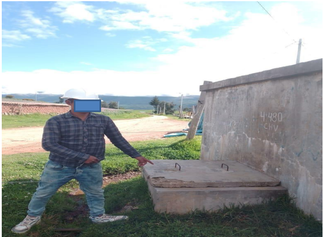
Foto 6. : Reservorio caja de válvulas de manejo .
