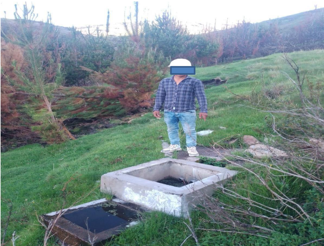
Foto 3. : Captación con deficiencias. Fuente: Producción propia
