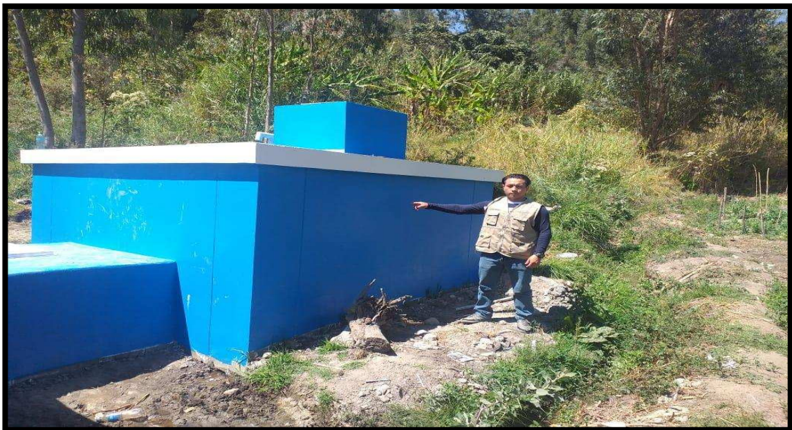
Imagen 04: Reservorio de almacenamiento del sistema de abastecimiento de agua potable del Barrio Allauca, distrito de Caraz, provincia de Huaylas, región Áncash – 2023.
