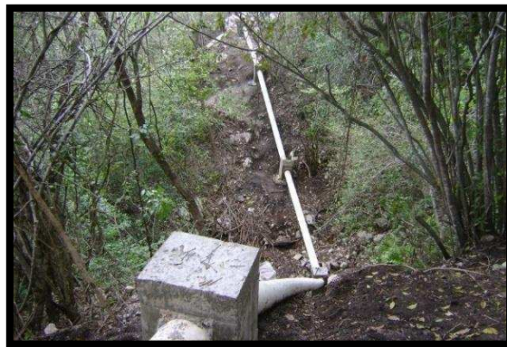
Figura 13: Línea de conducción.
