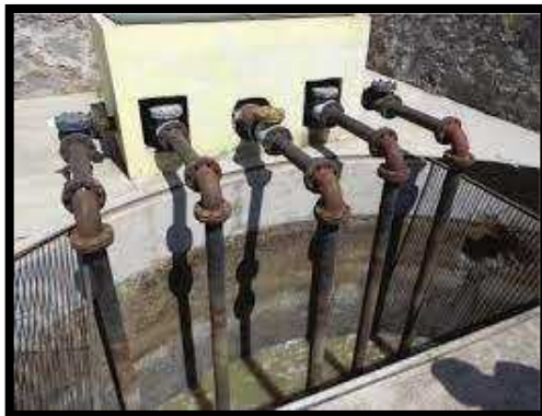
Figura 9: Tubería de fierro galvanizado.
