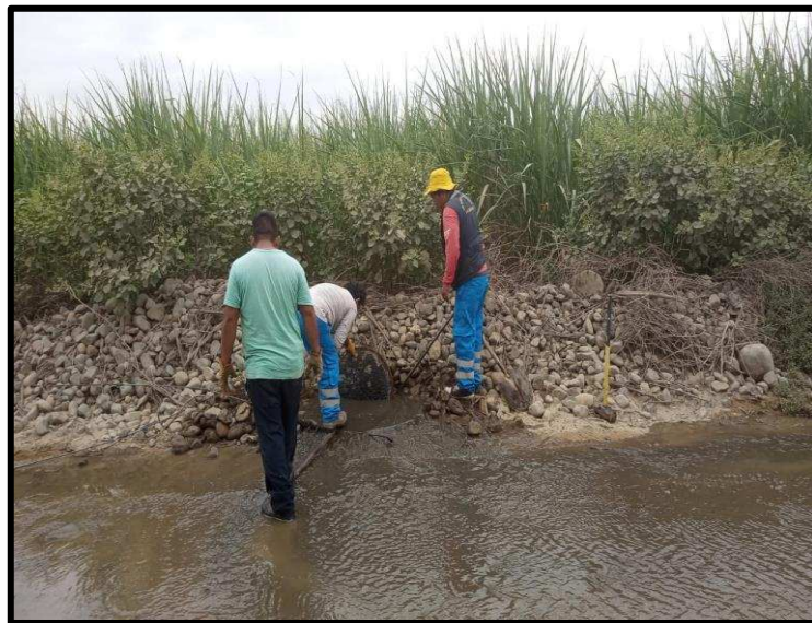
Figura 63: Caja de inspección de la poza de oxidación actualmente presentando atoros
