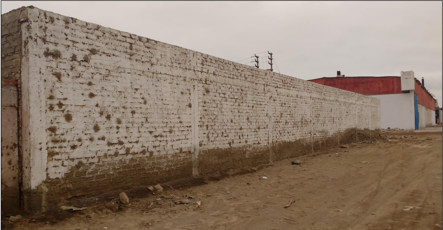
Fotografía 2. Vista panorámica del tramo A - B, se aprecia la presencia de erosión en muro y columnas.
