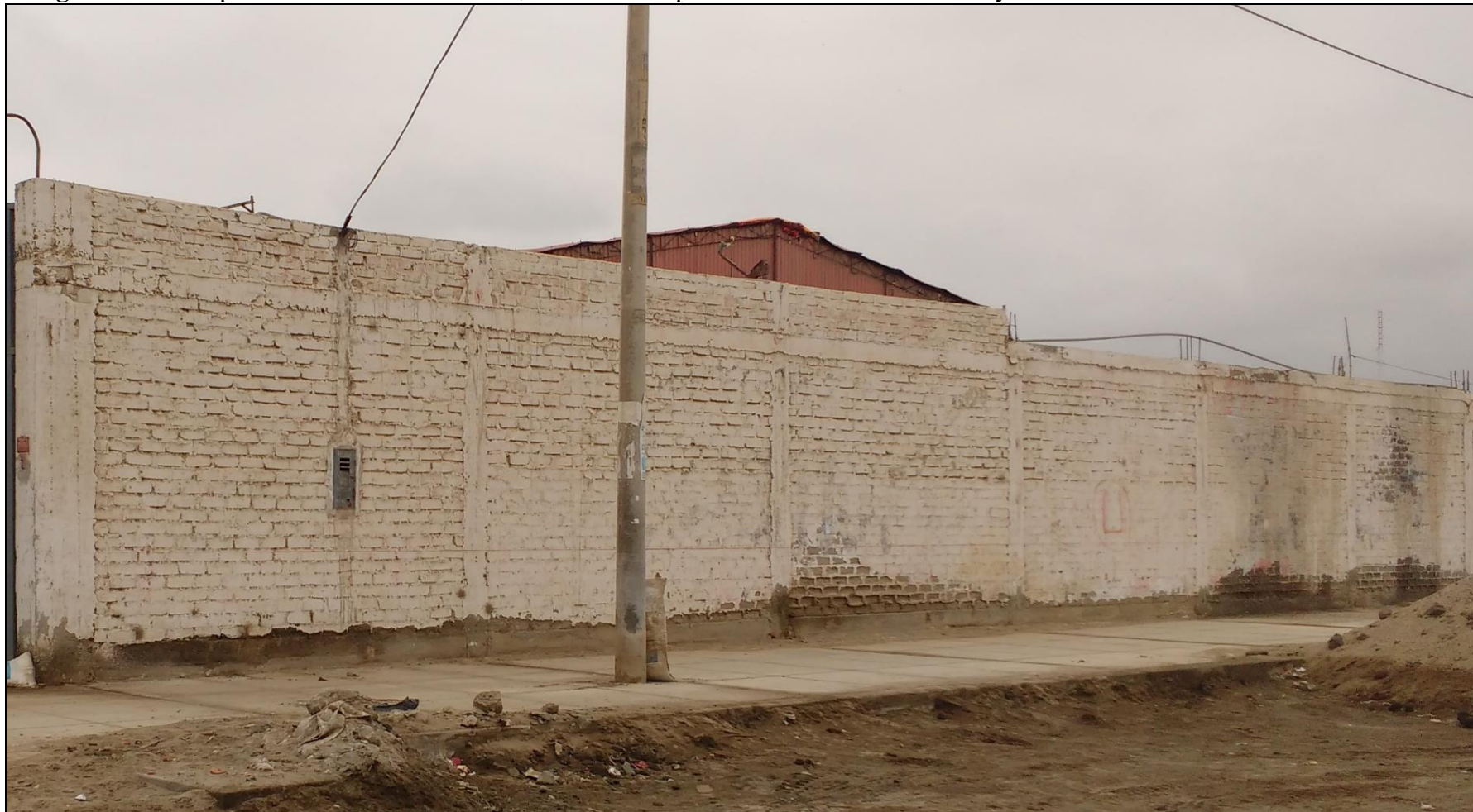
Fotografía 5. Vista panorámica del tramo D – E, se observa la presencia de erosión en Muro y Sobrecimiento.
