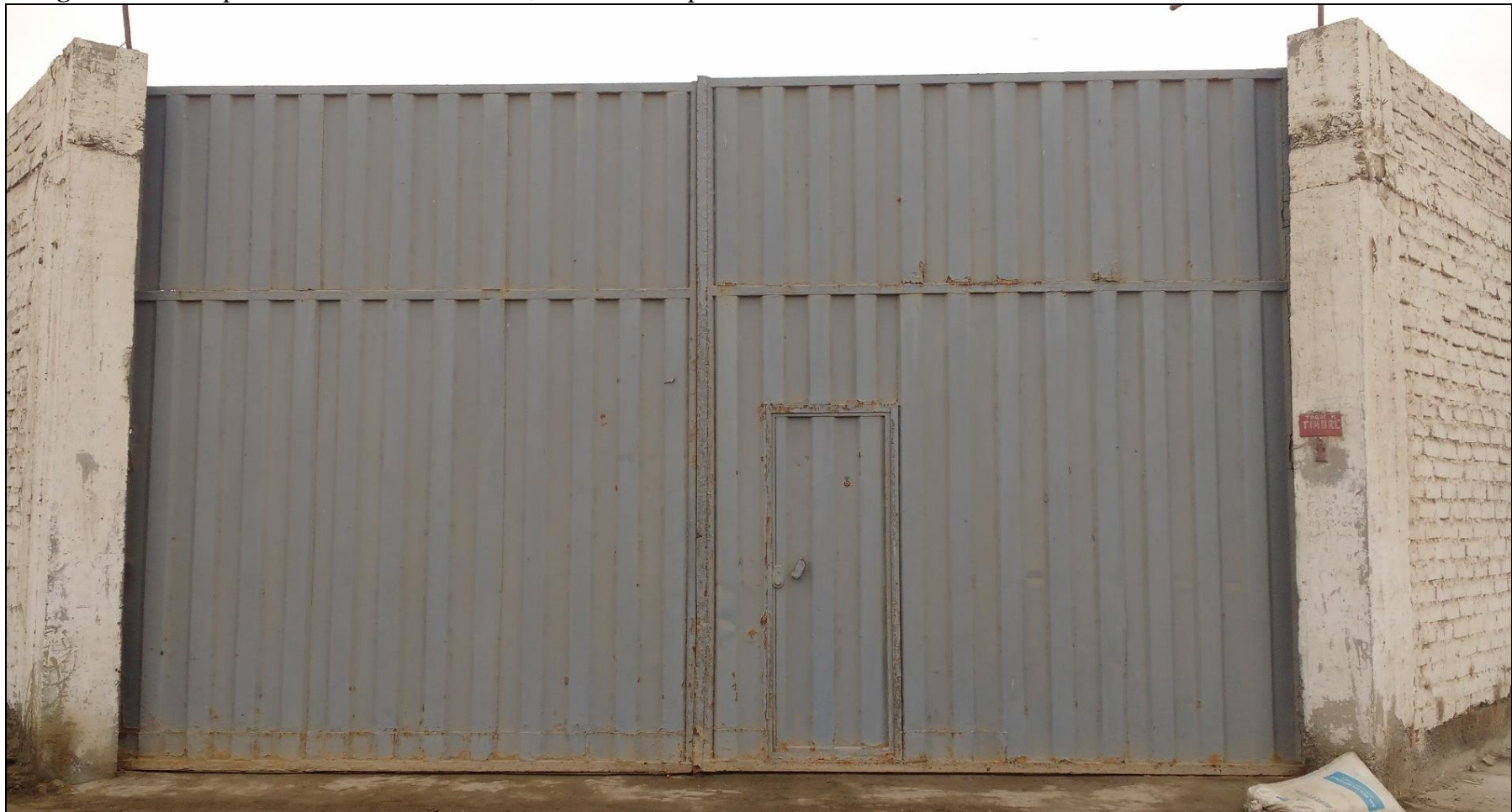
Fotografía 4. Vista panorámica del tramo C – D, se observa la presencia de erosión en Columnas.
