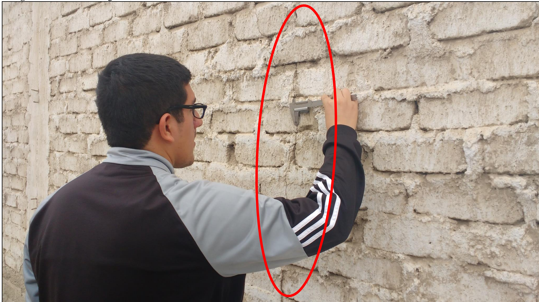
Fotografía 7. Medición de grieta, utilizando un vernier, en el muro de albañilería de la unidad muestral 5.
