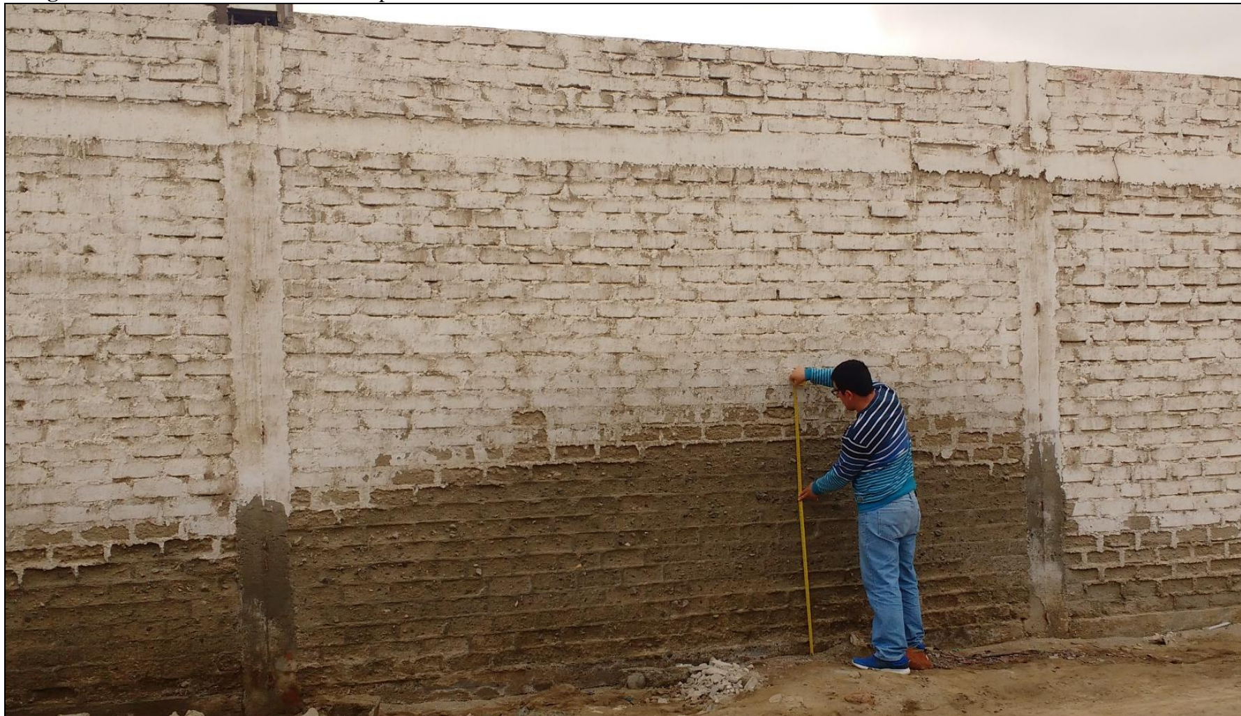
Fotografía 9. Medición del área afectada por erosión del muro de albañilería en la unidad muestral 12.
