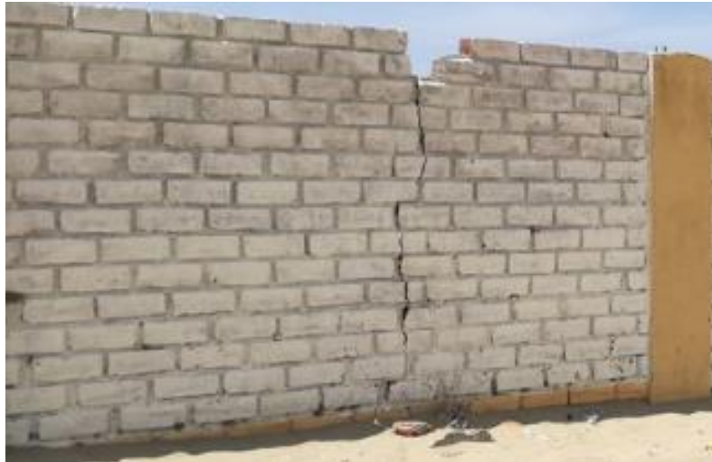
Figura 11. Agrietamiento vertical en muro de albañilería. Nota. Fuente: Suarez, E. (2016)
