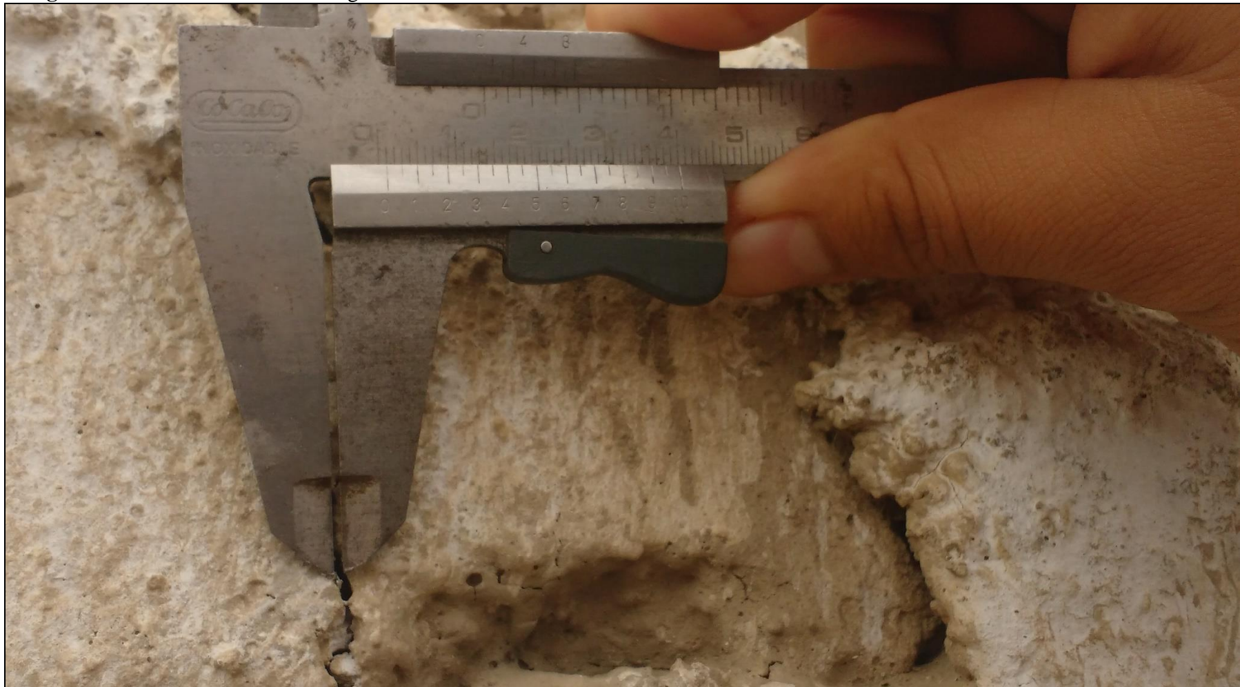
Fotografía 8. Muro de albañilería con grieta de 1.1mm de abertura en unidad muestral 5.
