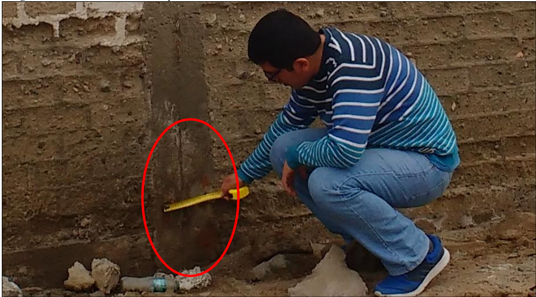
Fotografía 10. Medición del área afectada por manchas de herrumbre en el concreto de la columna en la unidad muestral 12.
