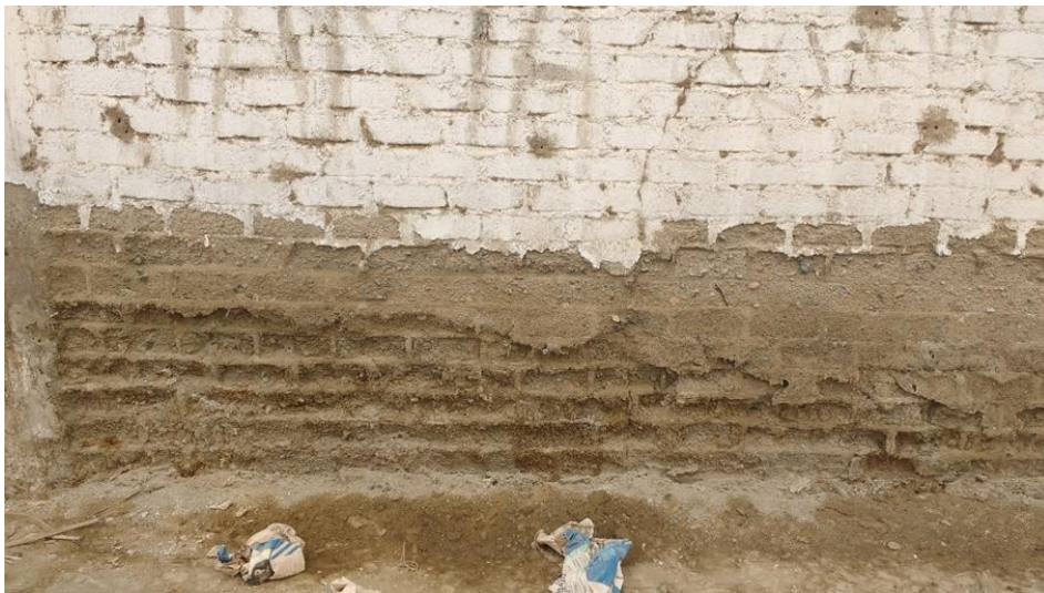
Figura 12. Erosión en un nivel alto en muro de albañilería. Nota. Fuente: Elaboración propia (2017).
