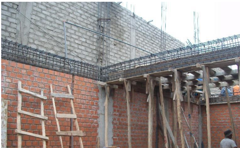
Figura 5. Armadura y encofrado de vigas de concreto armado. Nota. Fuente: Yraitá, A. (2016).
