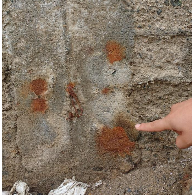
Figura 14. Manchas de herrumbre en concreto. Nota. Fuente: Elaboración propia (2017).
