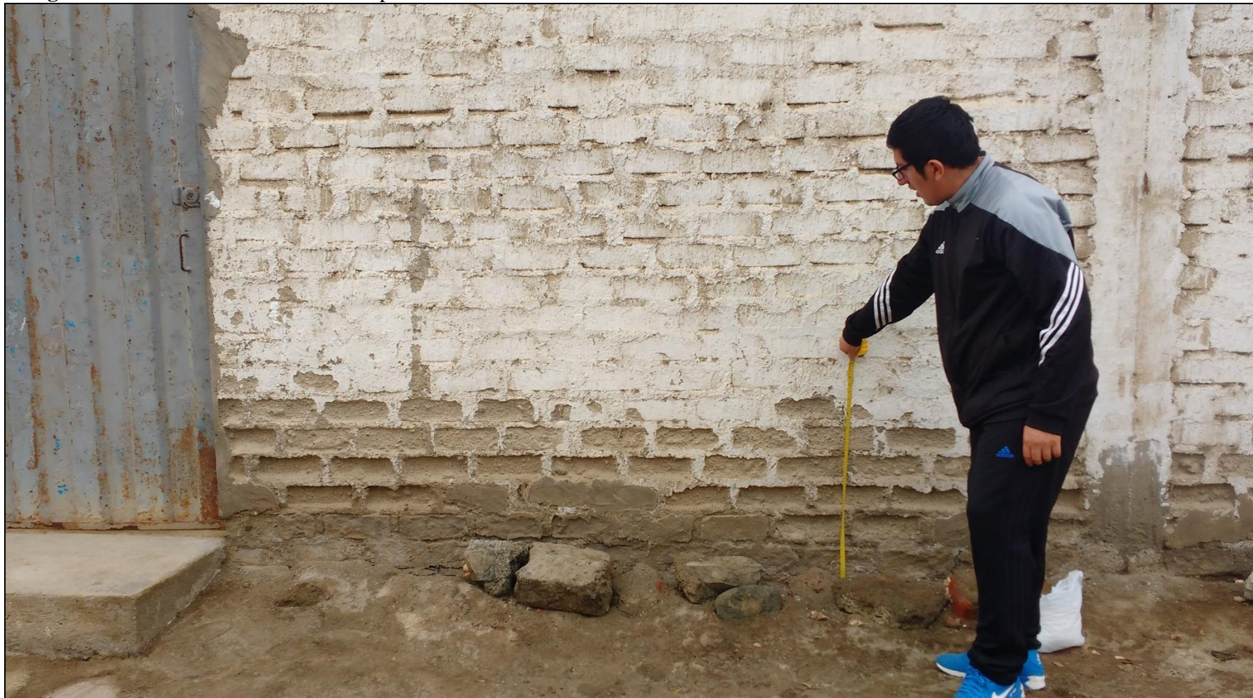
Fotografía 6. Medición del área afectada por erosión del muro de albañilería en la unidad muestral 14.
