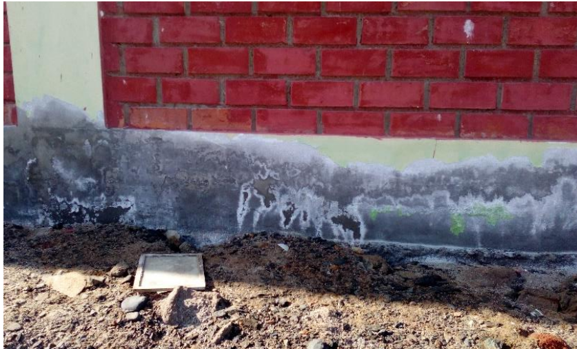
Figura 13. Sobrecimiento de muro con afectado por la eflorescencia. Nota. Fuente: Miranda, J. (2017).
