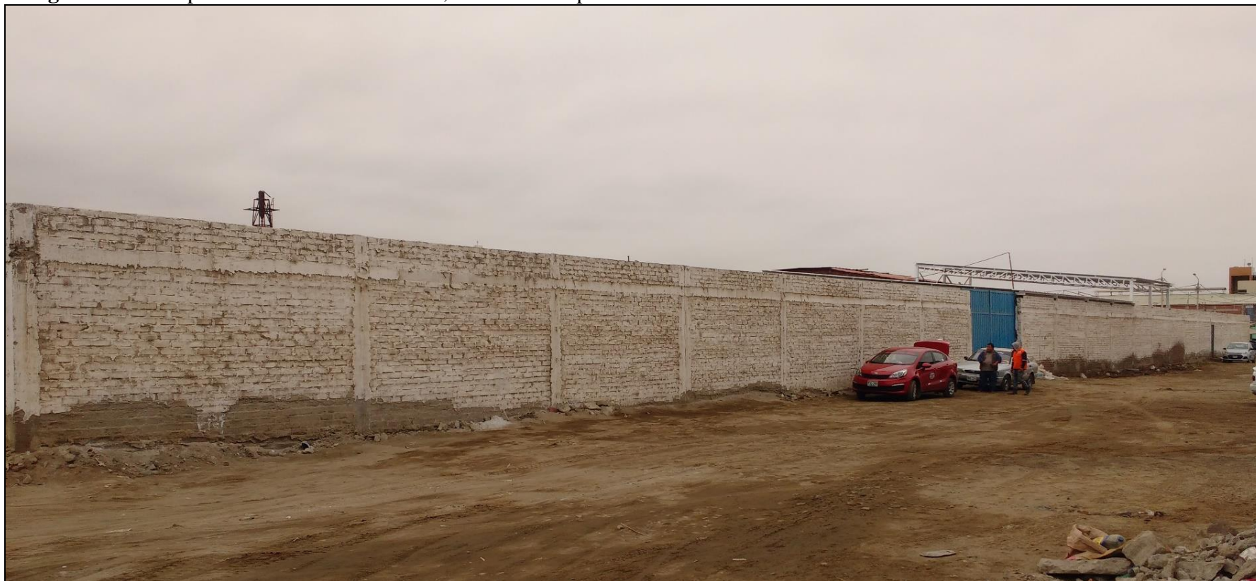
Fotografía 3. Vista panorámica del tramo B – C, se observa la presencia de erosión en muro.
