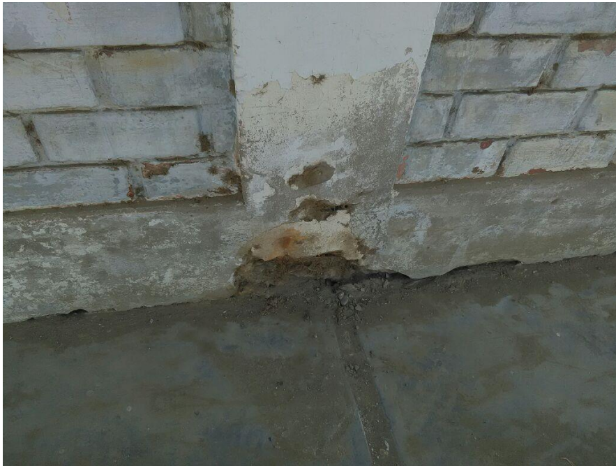
Gráfico 45: Desprendimiento en la parte inferior de la columna
