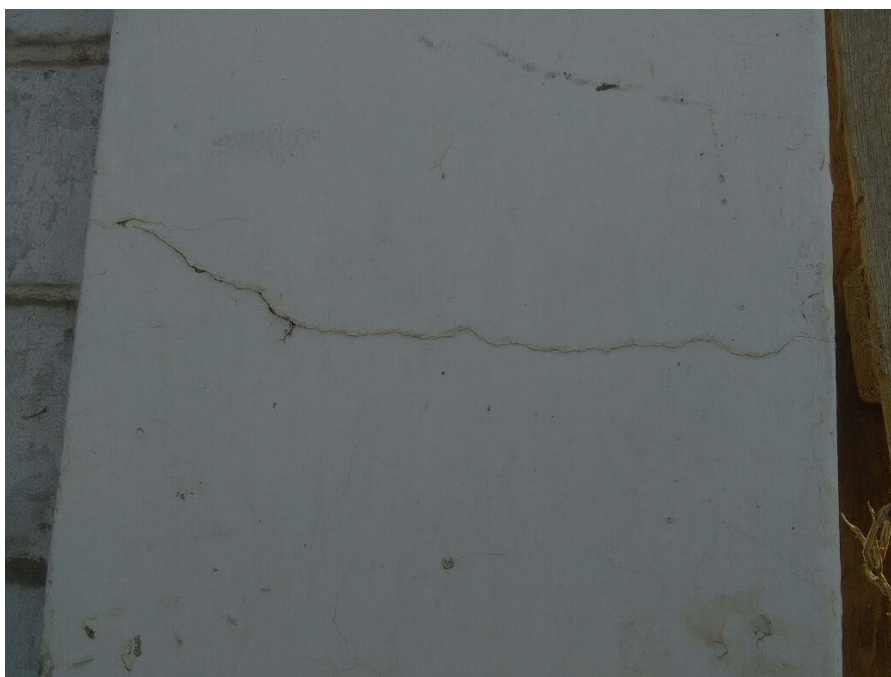
Gráfico 47: Presencia de fisuras en la columna.
