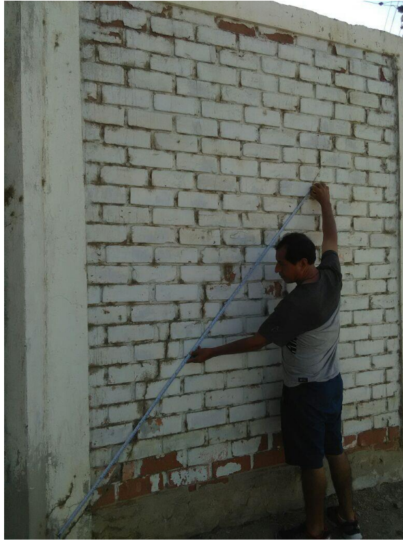
Gráfico 48: Agrietamiento en el muro.
