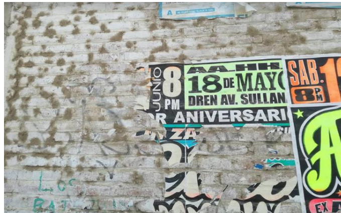
Gráfico 10: Suciedad afectando al muro.
