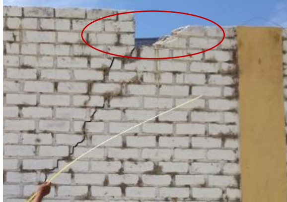
Gráfico 14: Desprendimiento en parte superior de muro
