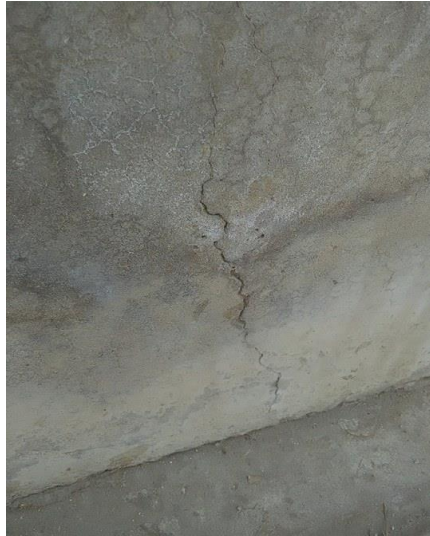
Gráfico 13: Fisura en el sobrecimiento.
