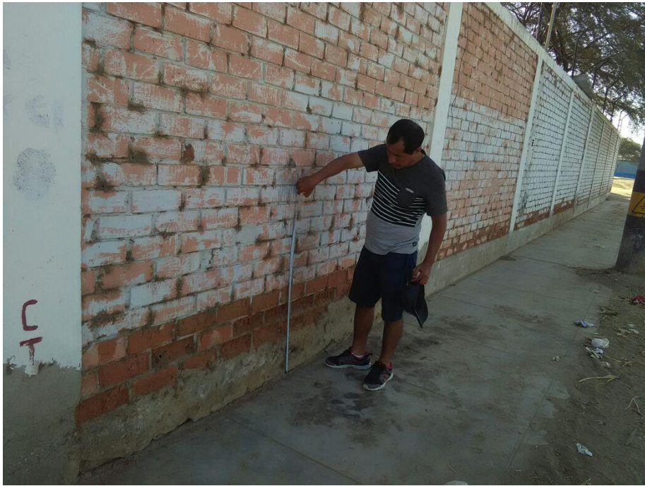
Gráfico 42: Presencia de erosión en la parte inferior del muro y en el sobrecimiento
