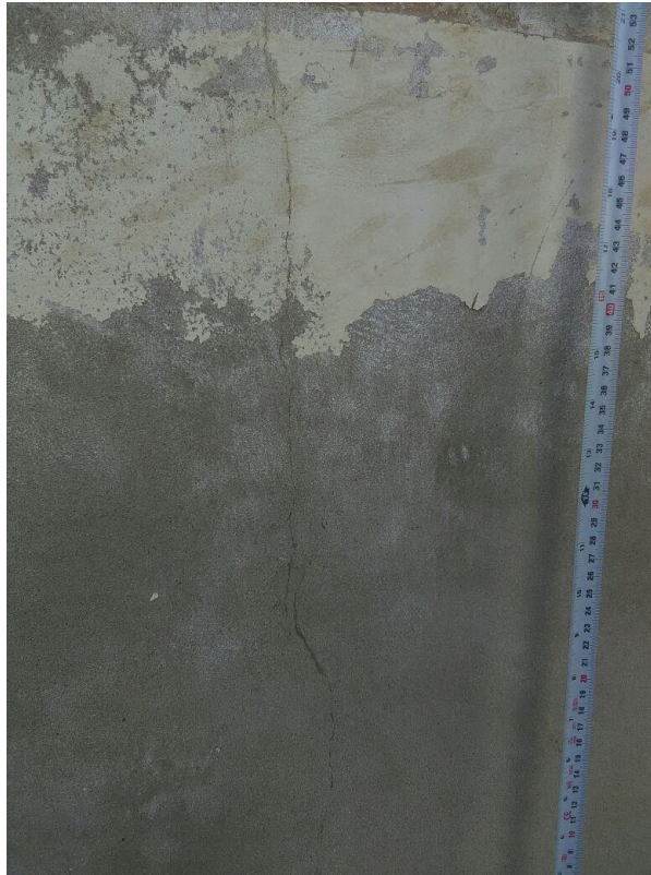
Gráfico 44: Fisuración en el sobrecimiento.
