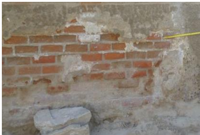
Gráfico 7: Patologías en el concreto.
