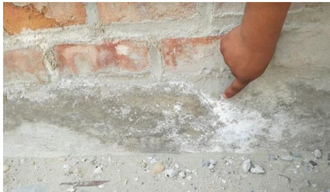
Gráfico 16: Eflorescencia en el sobrecimiento
