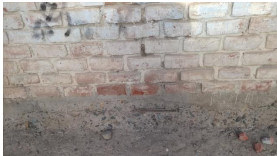
Gráfico 11: Erosión en el sobrecimiento.
