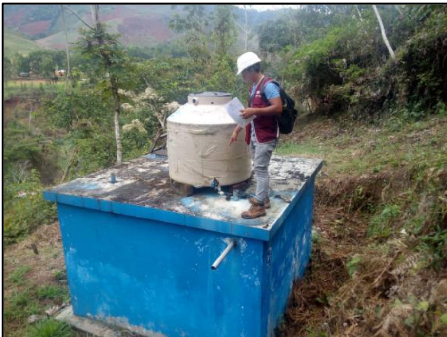
Foto 6: Evaluando la caseta de cloración del reservorio existente del centro Poblado Huantinini
