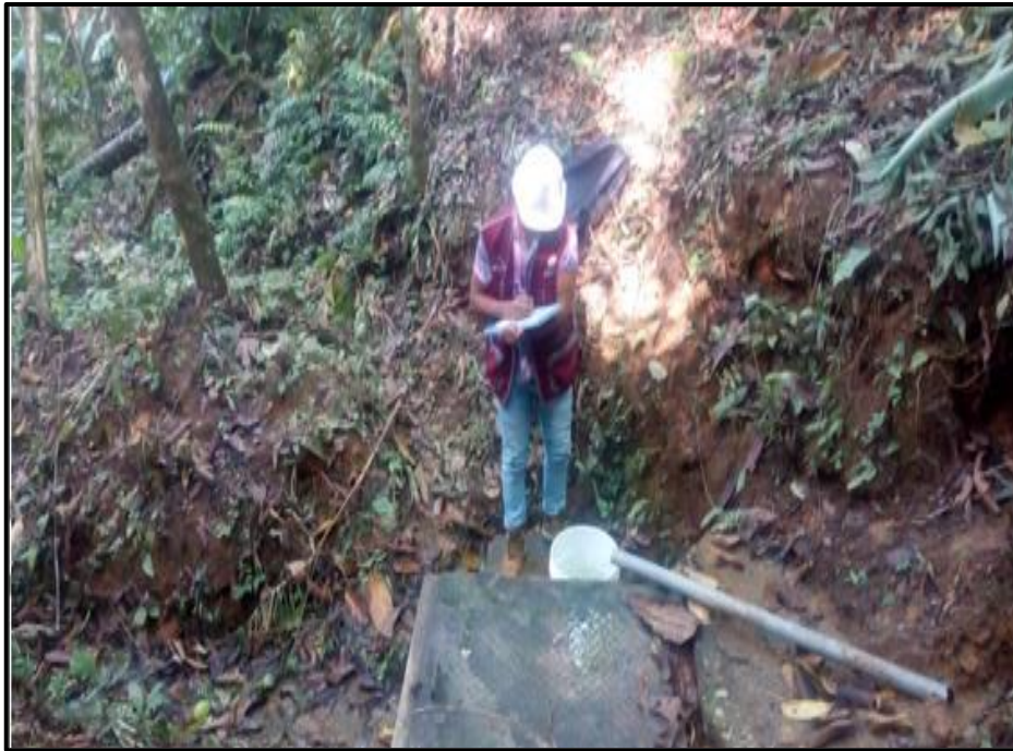
Foto 3: Evaluando la cámara seca de la Captación existente del centro Poblado Huantinini
