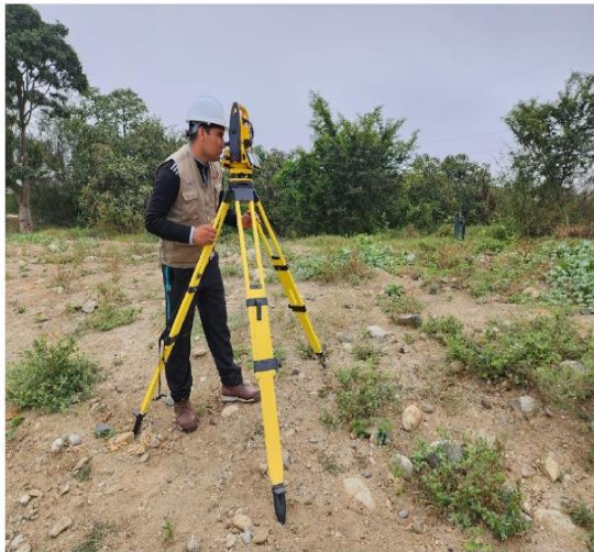
FOTO N° 04: LEVANTAMIENTO TOPOGRAFICO CON LA ESTACION TOTAL MARCA SOUTH N40 EN LA LOCALIDAD DE SAN PEDRO.
