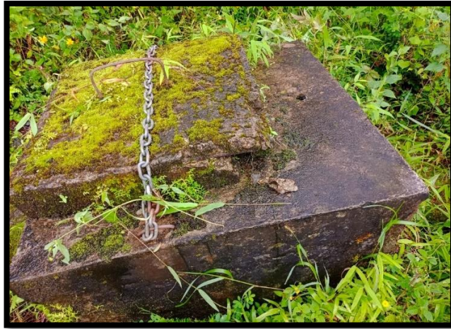
Figura N° 40 Cámara rompe presión en mal estado
