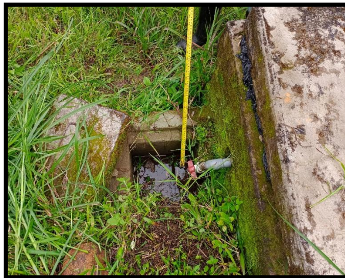
Figura N° 41 Cámaras secas llenas de agua por infiltración.
