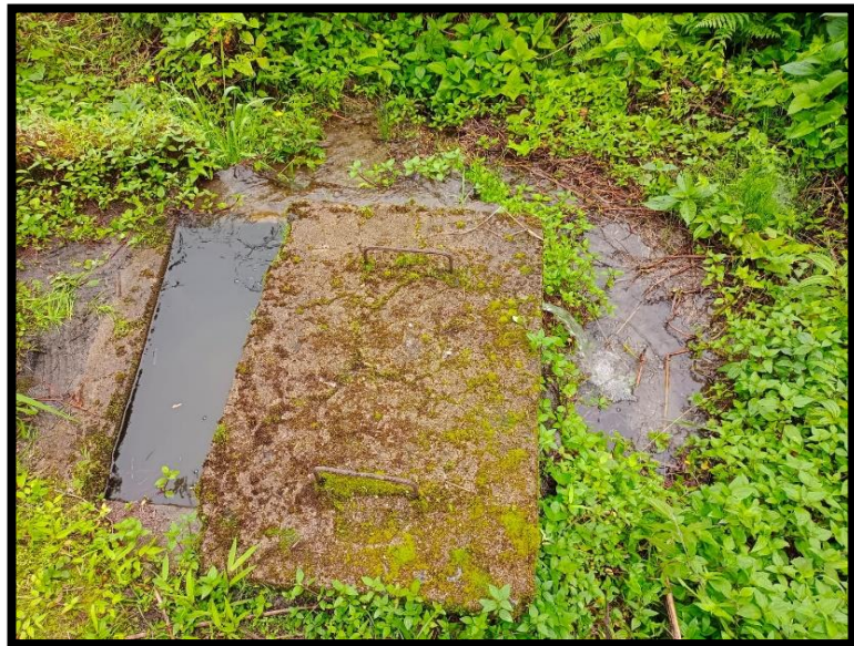
Figura N° 23 Captación citan – manantial de ladera Yumbe
