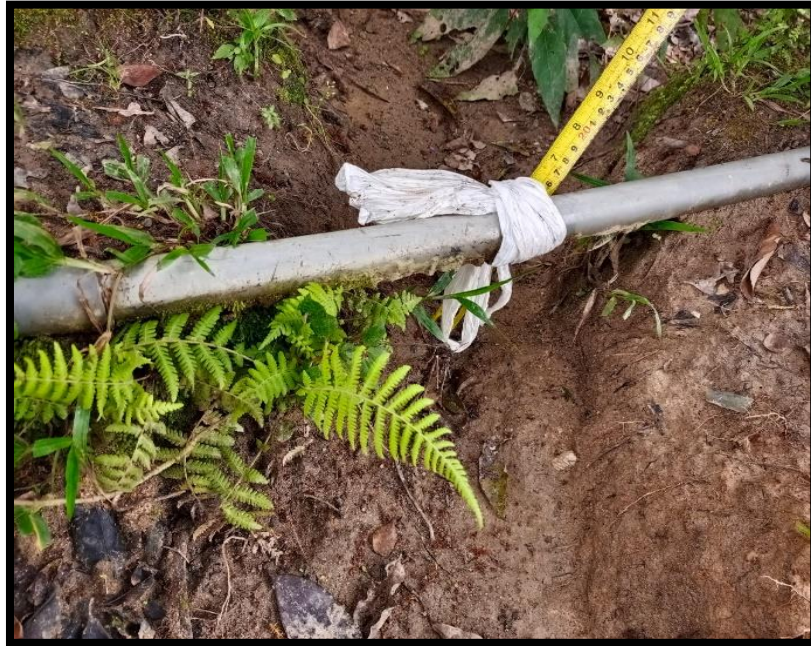
Figura N° 32 La red presenta roturas
