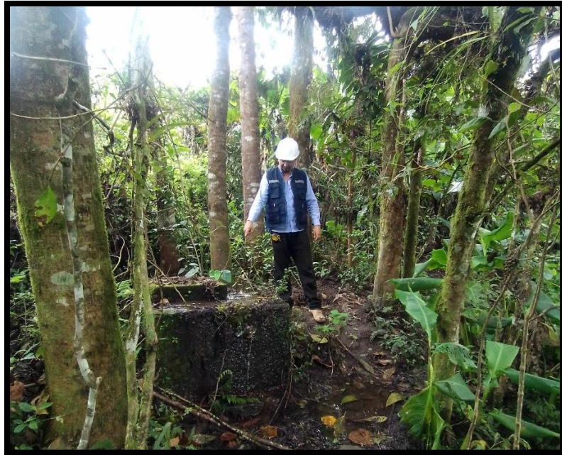
Figura N° 39 Cámara rompe presión cubierta de vegetación
