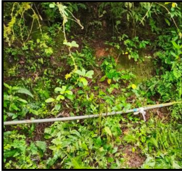
Figura N° 31 Red de conducción presenta roturas
