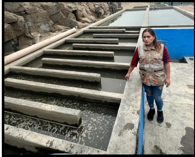
Figura 4: Pre filtro horizontal
