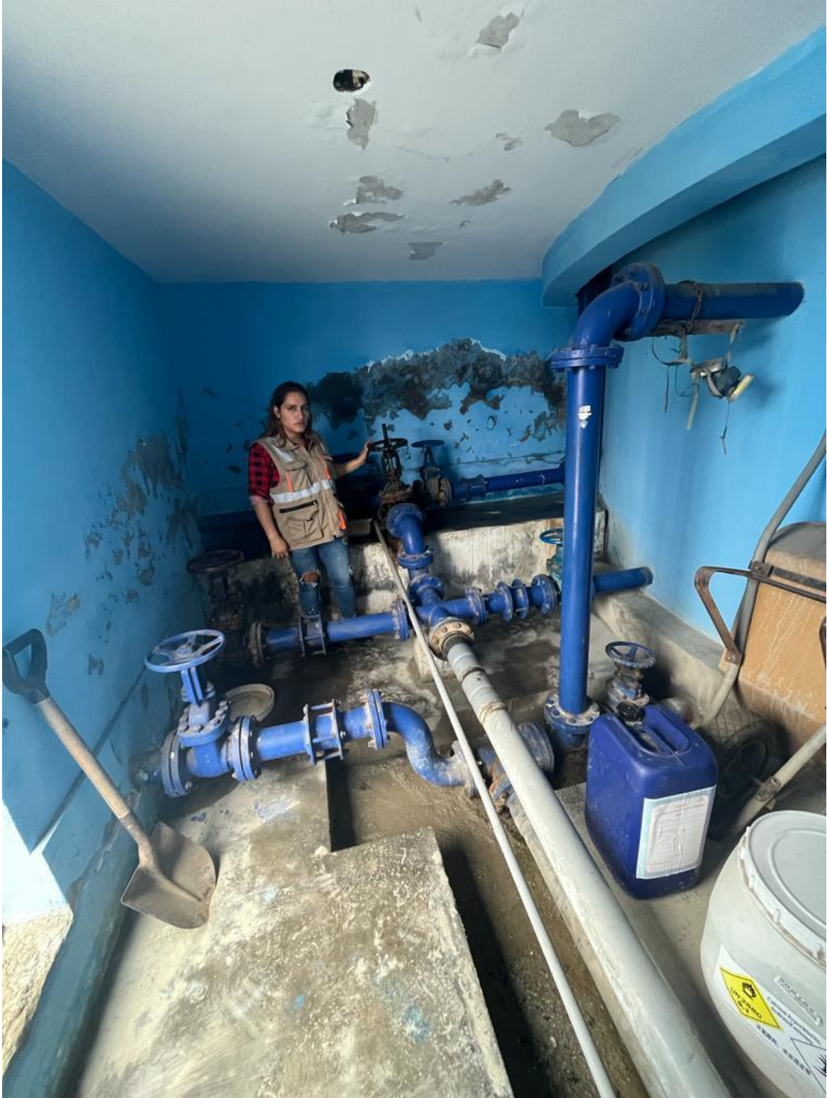
Figura 13: Cuarto de control de válvulas
