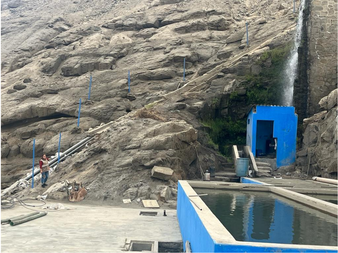
Figura 8: Pozo tubular en el Anexo Ramballay
