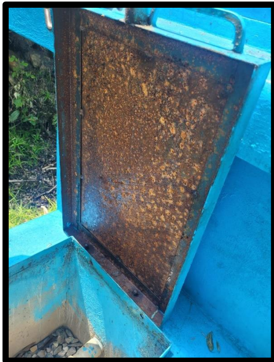
Figura 53: Tapa sanitaria de la captación 2
