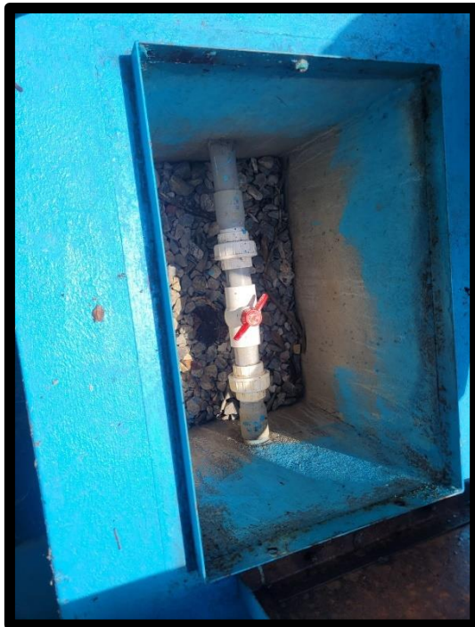
Figura 55: llave de la captación 1
