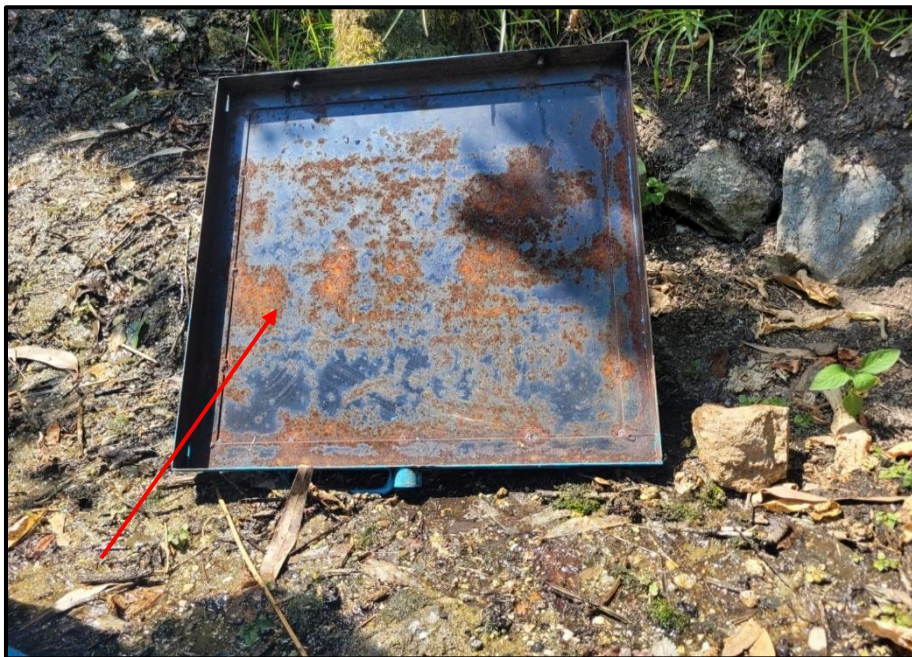
Figura 22: Oxido de la tapa sanitaria del tanque de almacenamiento Fuente: Evidencia de campo
