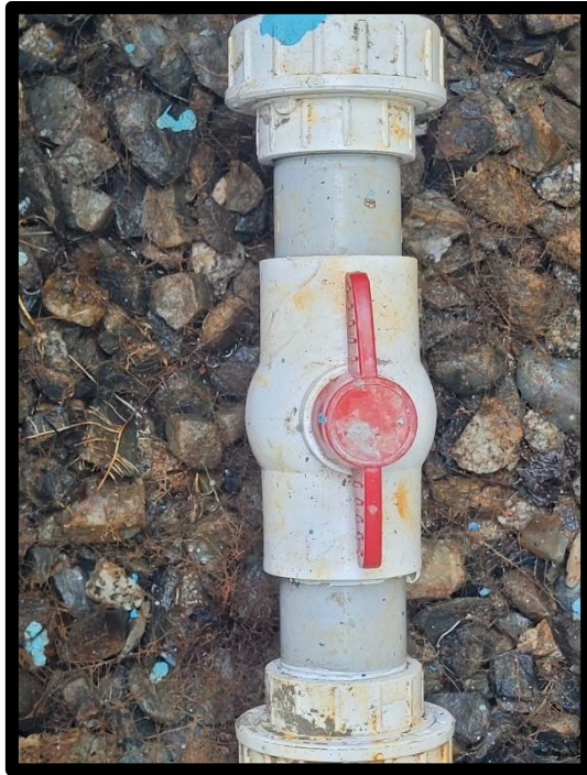
Figura 52: Llave de la captación 2
