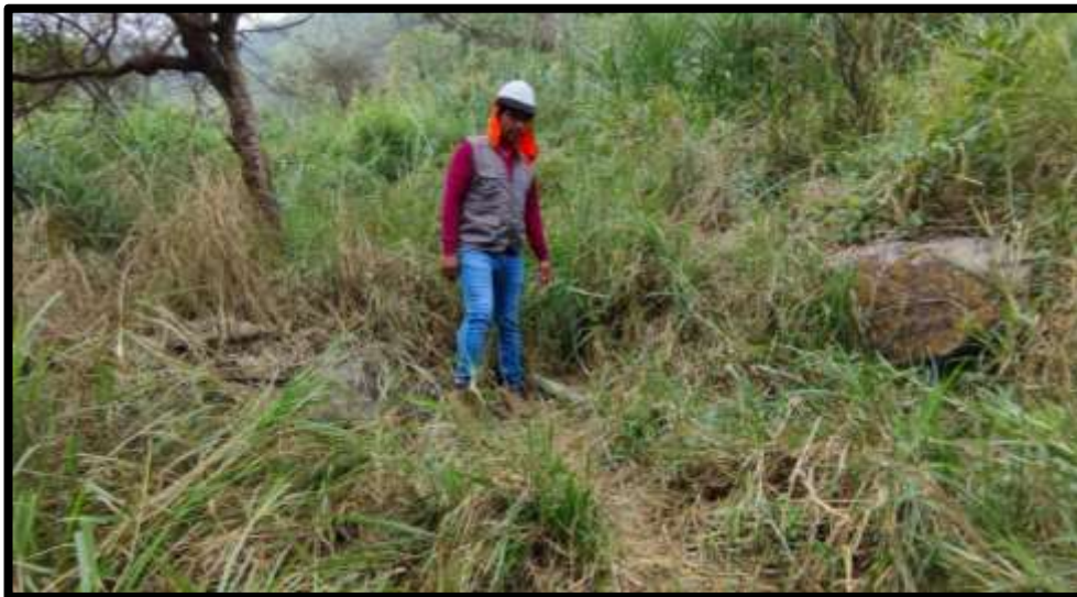
Imagen 6. Línea de aducción de la misma forma que la conducción se muestra expuesta.
