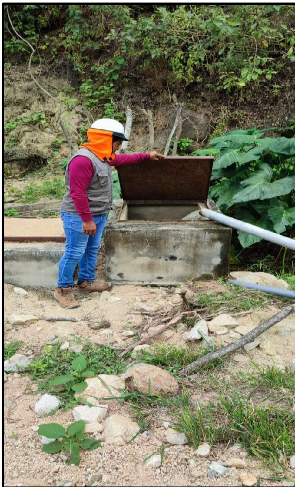
Imagen 1: cámara de captación del caserío de piedra del toro
