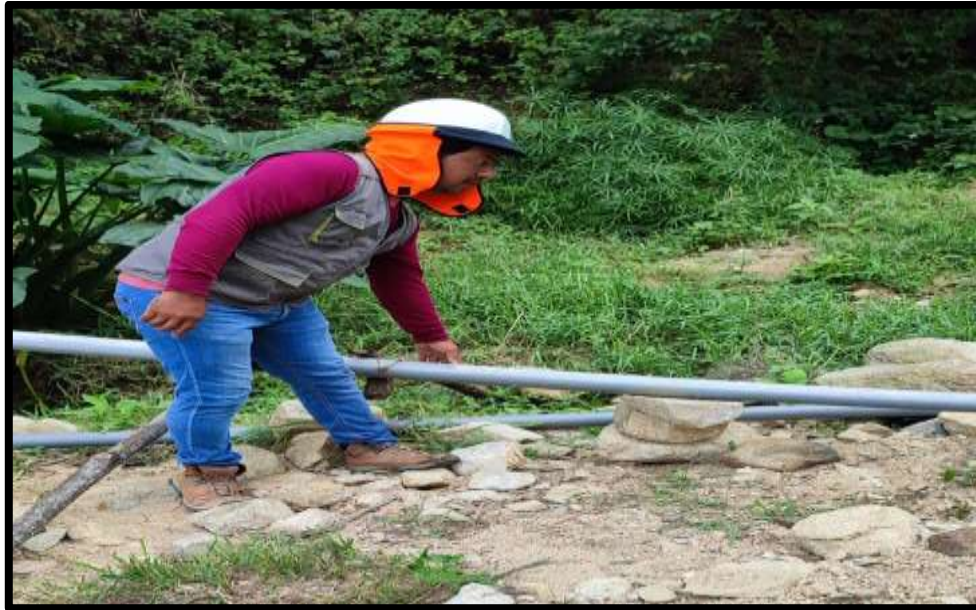
Imagen 5. Línea de conducción se muestra totalmente expuesta a la intemperie la cual puede sufrir daños
