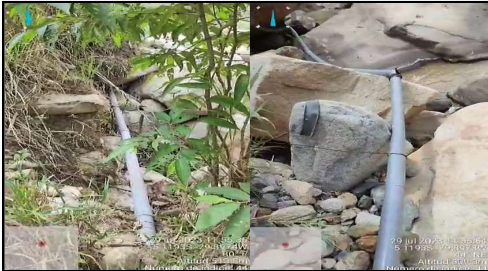
Imagen 2: Línea de conducción
