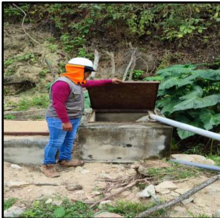
Imagen 2: Captación no cuenta protección de afloramiento, cámara húmeda dañada y seca deteriorada.
