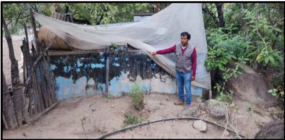
Imagen 4. Reservorio en mal estado, no cuenta con un cerco perimétrico el que proteja este componente
