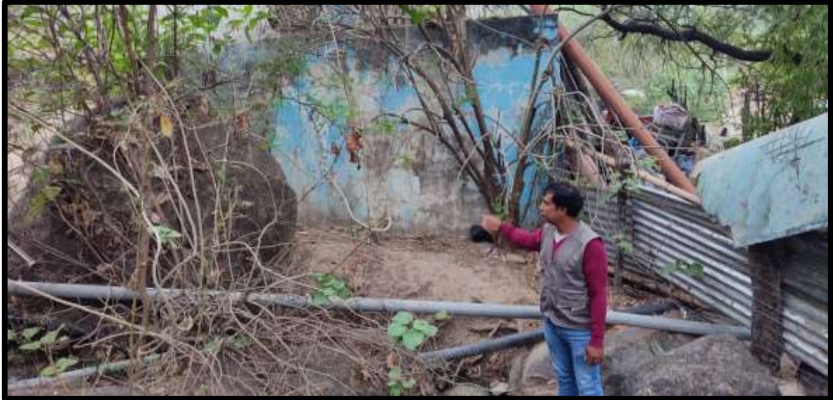
Imagen 3. Reservorio de almacenamiento del caserío de Piedra del Toro totalmente deteriorada y empleada para otros fines.
