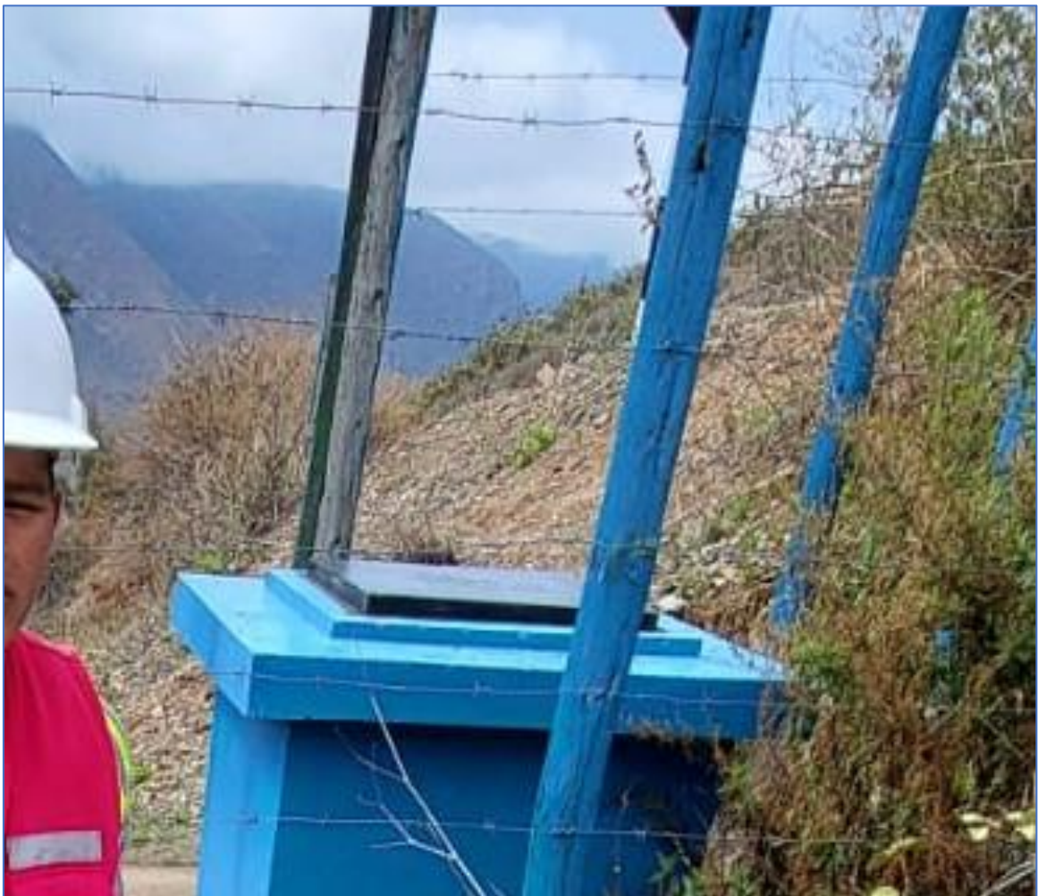
foto 04: cámara rompe presión T- 6
