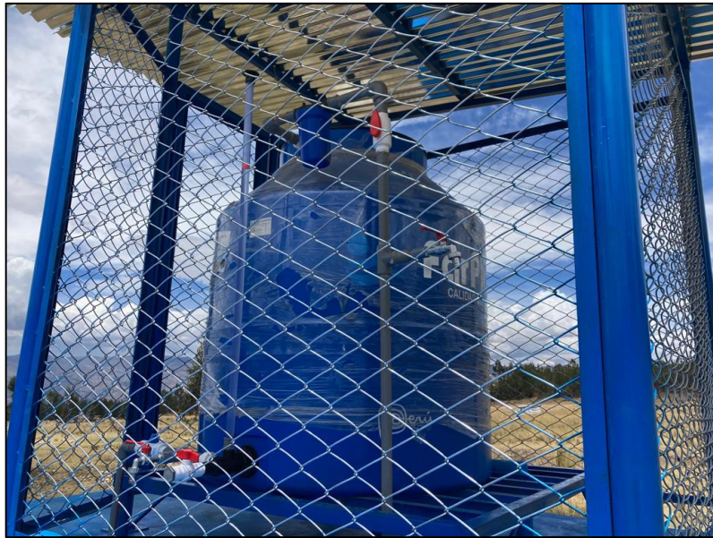
Figura 5: Caseta de cloración
