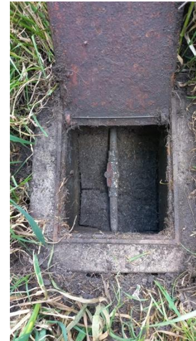
Figura 26. Caja de válvula de control domiciliaria
