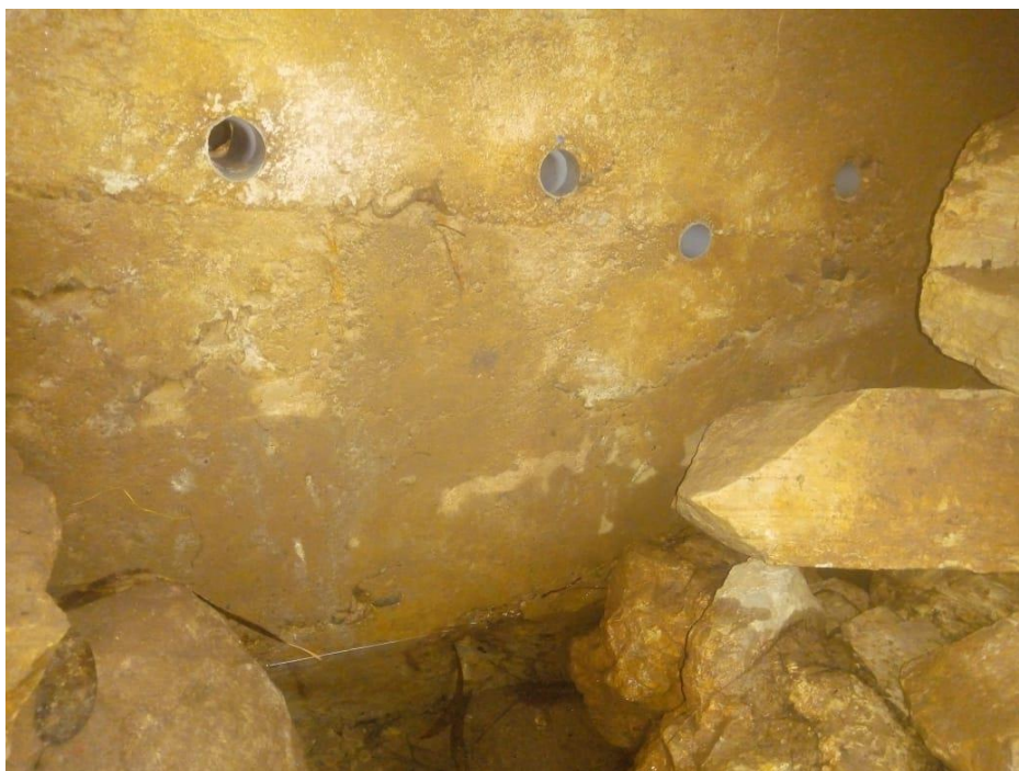
Figura 37. Se aprecia los orificios de entrada que se encuentran muy altas del nivel de agua del manante.
