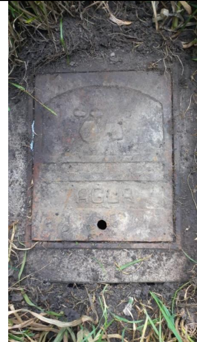
Figura 35. Caja de válvulas de control domiciliaria
