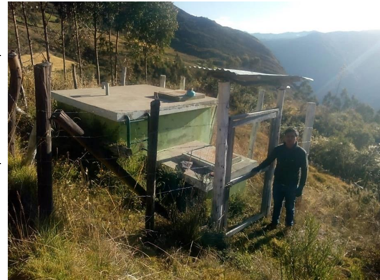
Figura 32. Evaluación estructural del reservorio
