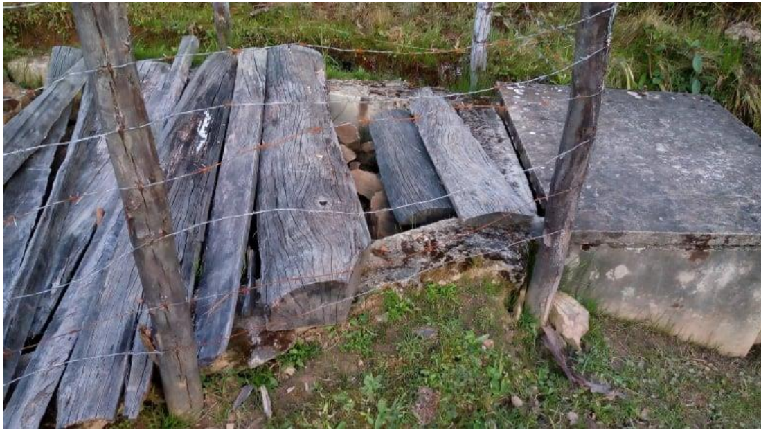
Fotografía 4 Cámara de captación con cerco perimétrico solo en las aletas
