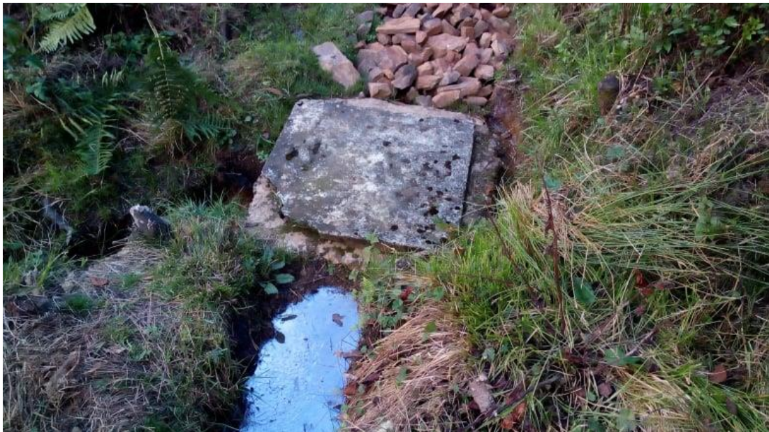
Fotografía 2 Cámara rompe presión en mal estado
