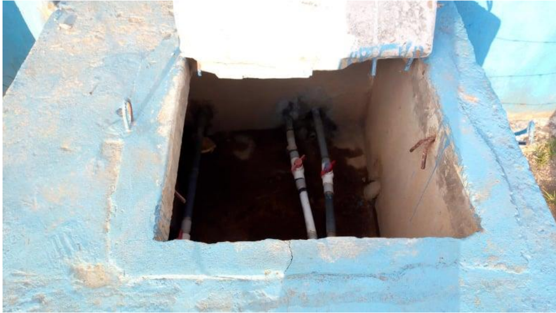
Fotografía 5 cámara de válvulas del reservorio
