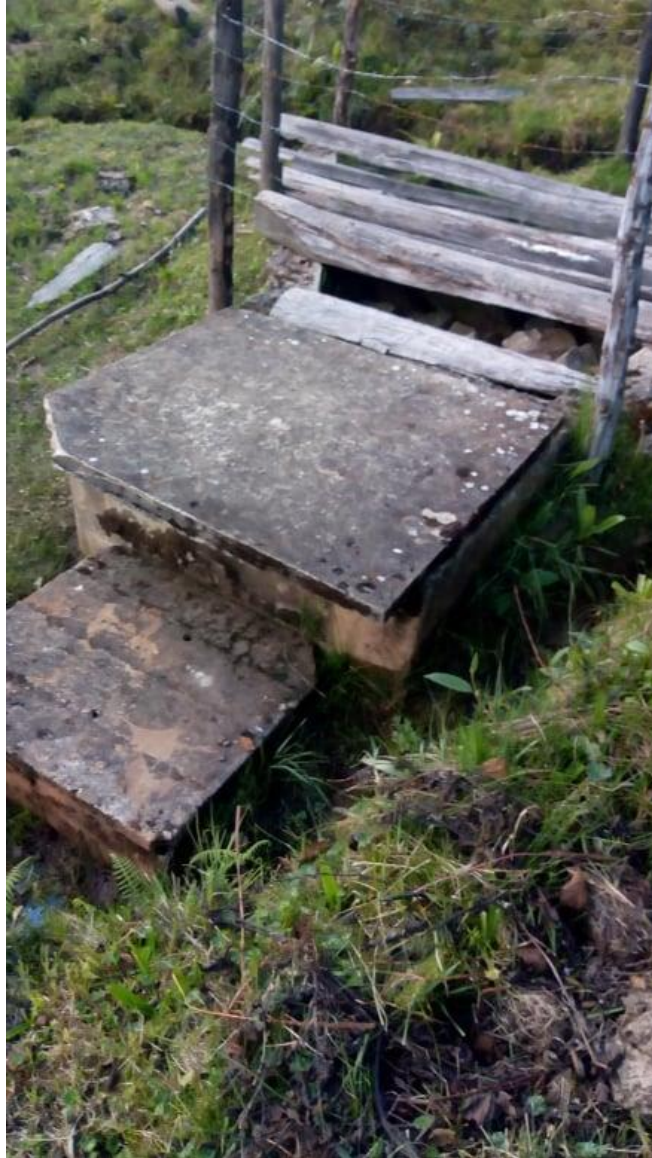
Fotografía 7 cámara de captación en mal estado
