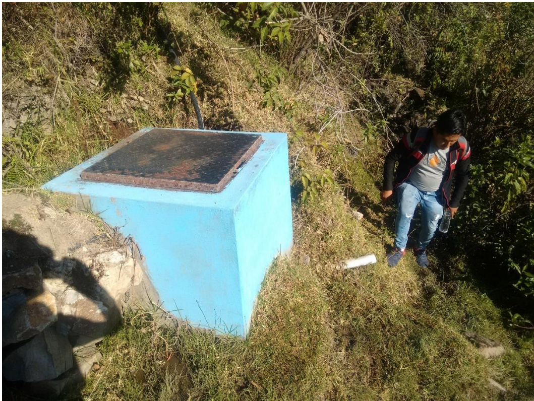
Figura 14: Cámara rompe presión
