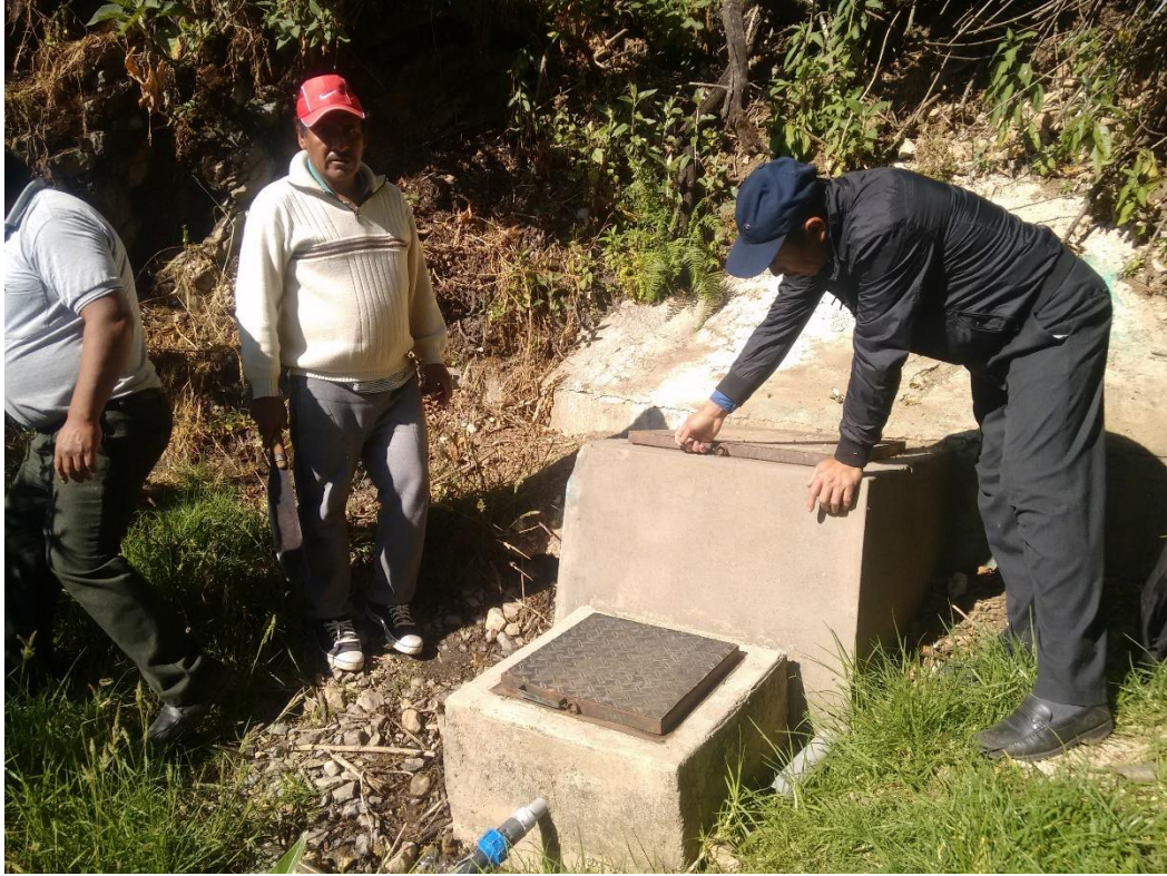
Figura 11: Cámara de captación en la Localidad de Nueva Victoria
