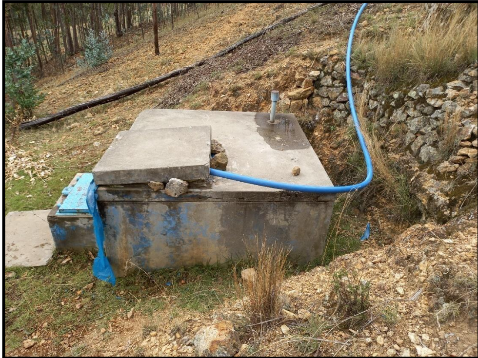
Figura 42: Reservorio de 5.5 m^3 del barrio de Condorpampa.
