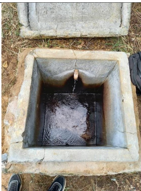
Figura 25: Cámara rompe presión 1
