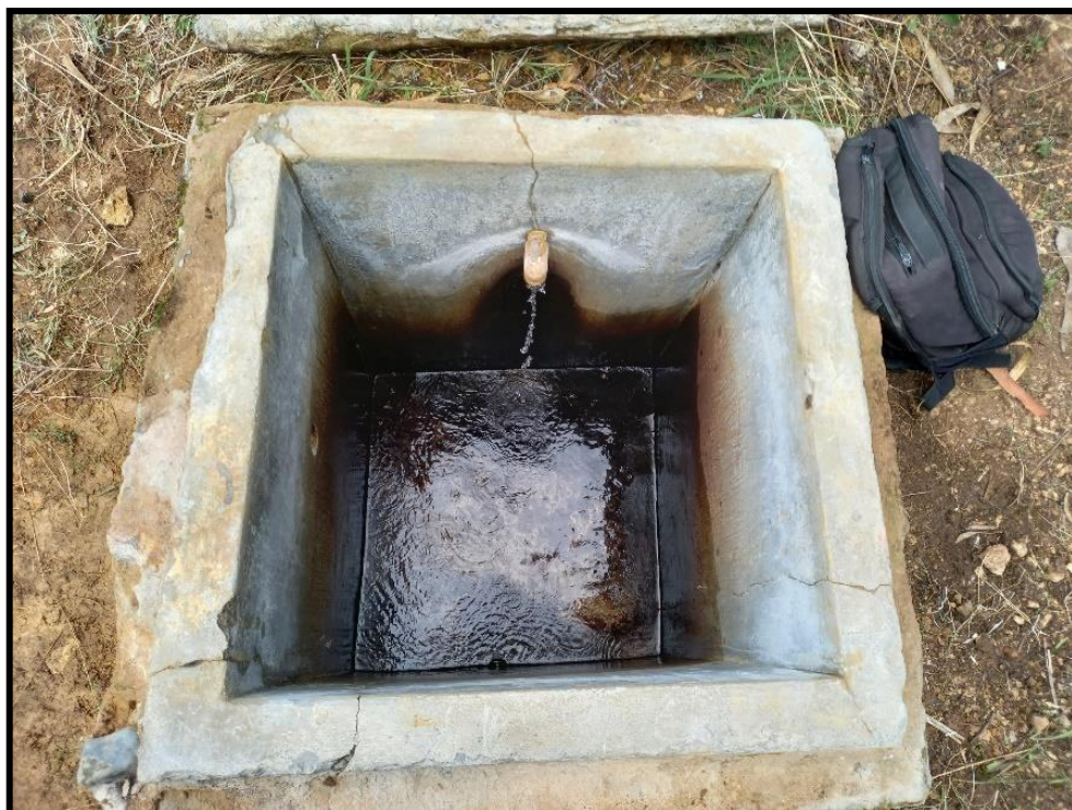
Figura 39: Interior de la primera CRP tipo 6
