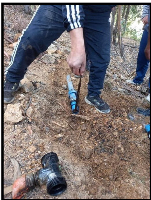
Figura 23: Raíces dentro de la línea de C.
