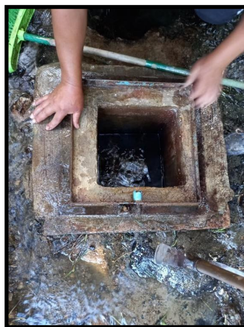
Figura 19: Captación en deterioro.
