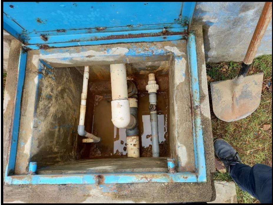
Figura 29: Caseta de válvulas.
