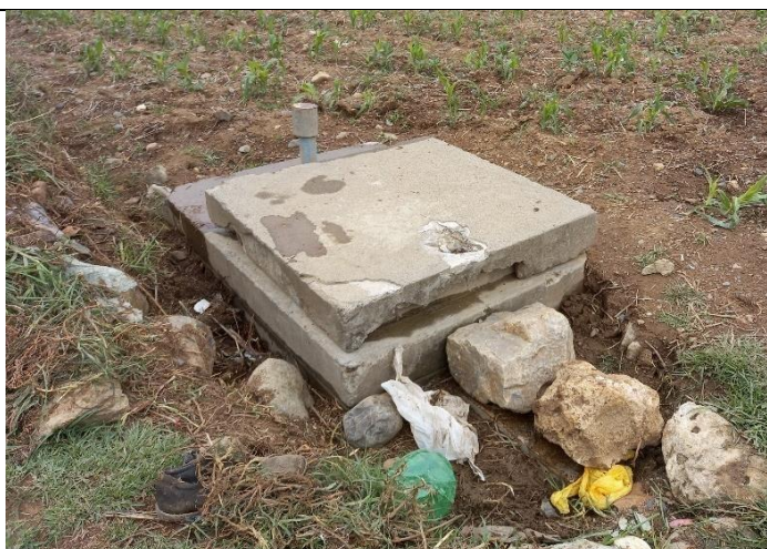
Figura 31: Cámara rompe presión tipo 7 (Distribuidora)
