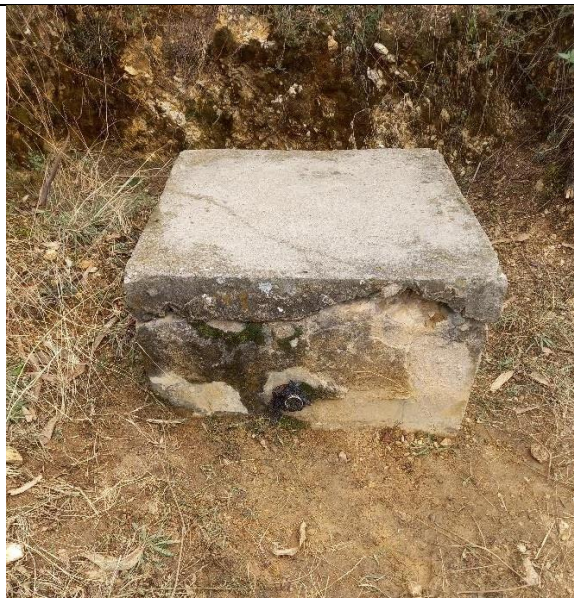
Figura 26: Cámara rompe presión 2
