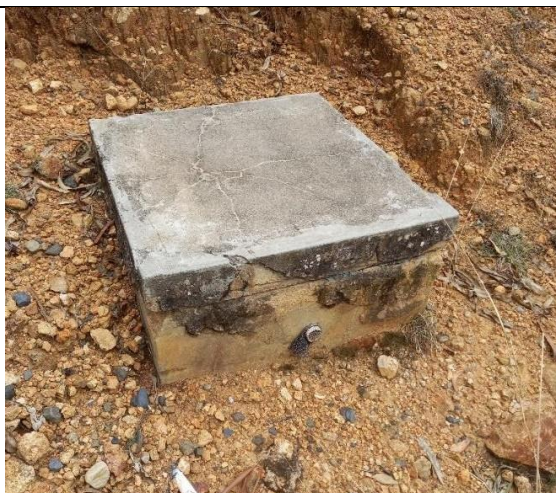
Figura 27: Cámara rompe presión 3
