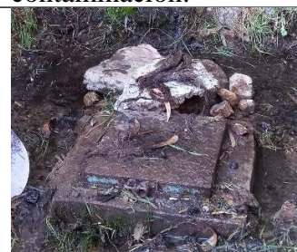
Figura 15: Tapa de captación
