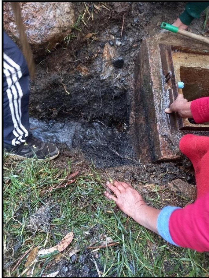
Figura 38: Medición de la tubería de salida de la captación.
