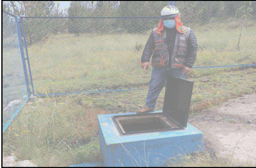
Figura 9: Tapa metálica cámara húmeda
