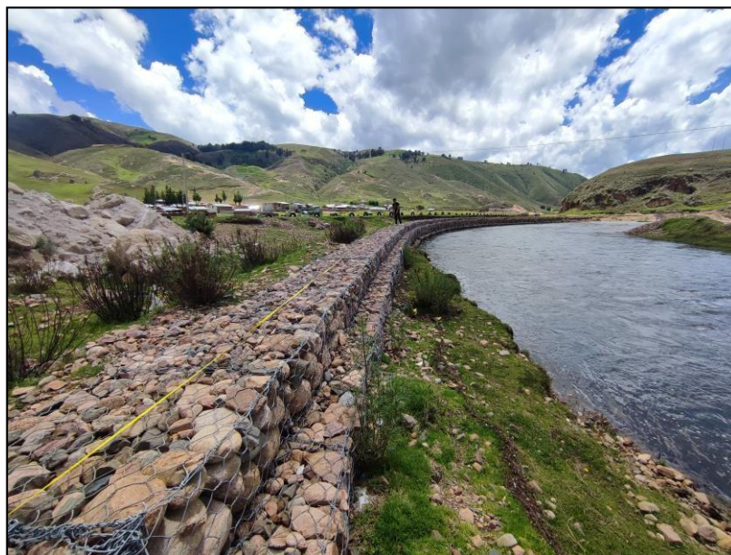
Figura 15: Se visualiza realizando la medida longitudinal del muro de gaviones. Fuente: Ilustración propia
