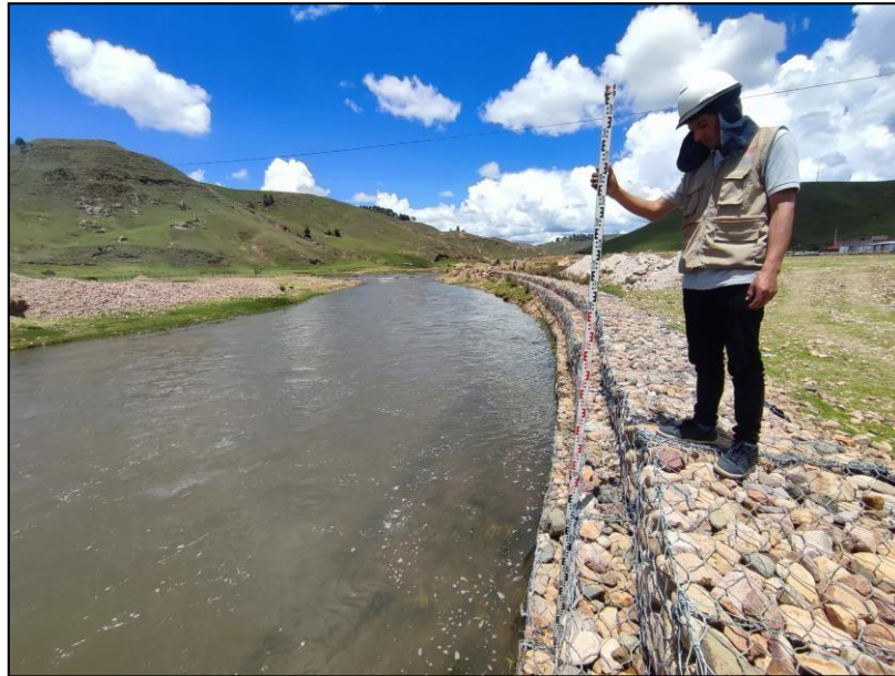
Figura 18: Se visualiza la progresiva 0+040 del muro del muro de gaviones Fuente: Ilustración propia
