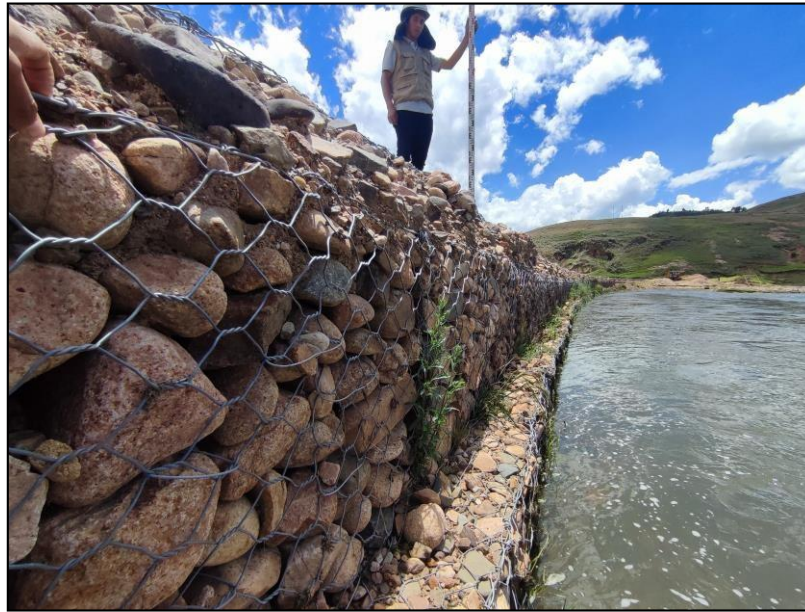
Figura 28: Se visualiza en el tramo 08 fragmentos de piedras y hormigón en la parte superior dando como evidencia el nivel del caudal del río cuando hay presencia de excesiva lluvia.
