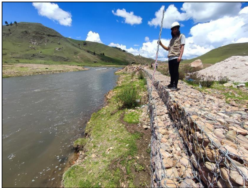
Figura 17: Se visualiza la progresiva 0+020 del muro del muro de gaviones Fuente: Ilustración propia
