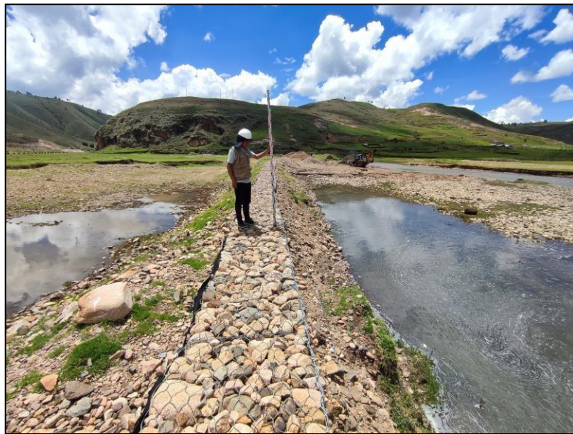
Figura 27: Se visualiza en el tramo 08 la filtración que se ocasiona. Fuente: Ilustración propia
