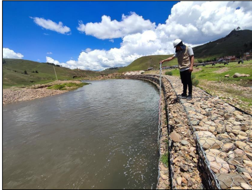
Figura 20: Se visualiza la progresiva 0+080 del muro del muro de gaviones Fuente: Ilustración propia
