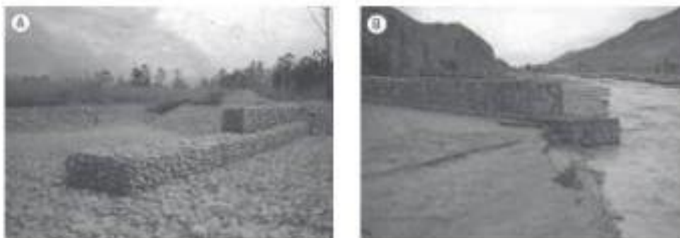
Fig. 9.4 Espigón en gaviones con plataforma contra la erosión en colchones Reno® (A) durante la construcción y (B) después de algunos meses
