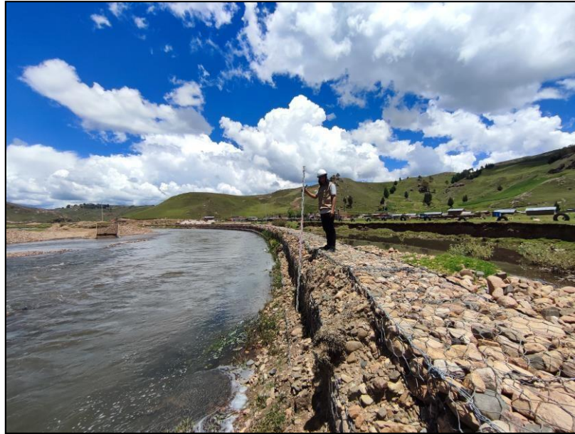
Figura 22: Se visualiza la progresiva 0+120 del muro del muro de gaviones Fuente: Ilustración propia
