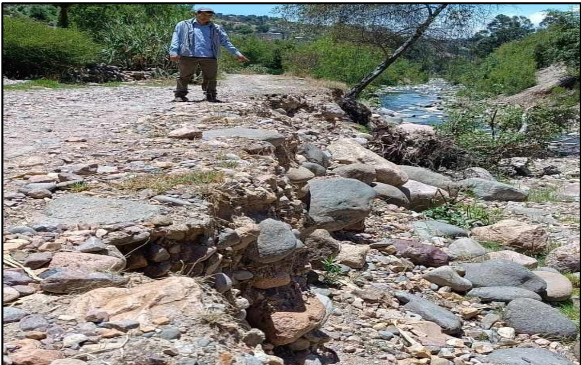
Figura 11: Se aprecia, socavación por la crecida del río afectando a la carretera.
