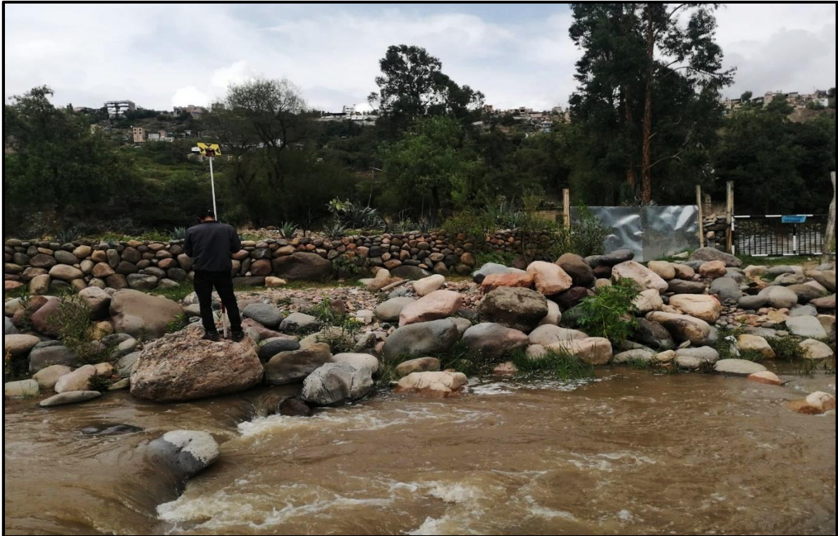
Figura 10: Se aprecia, la zona más vulnerable para la inundación.
