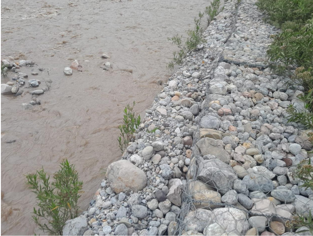
Foto 11: Se observa diferentes diámetros de los materiales empleados en el muro de gavión.
