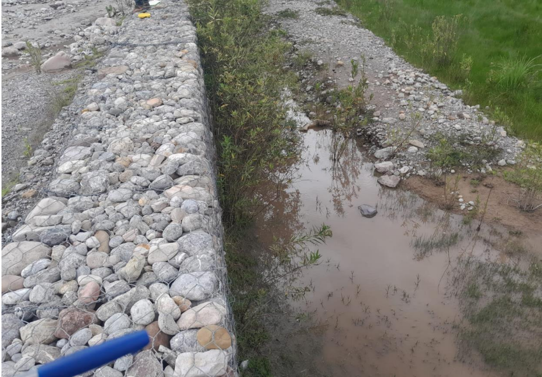
Foto 09: Se observa la filtración en la parte posterior de la estructura
