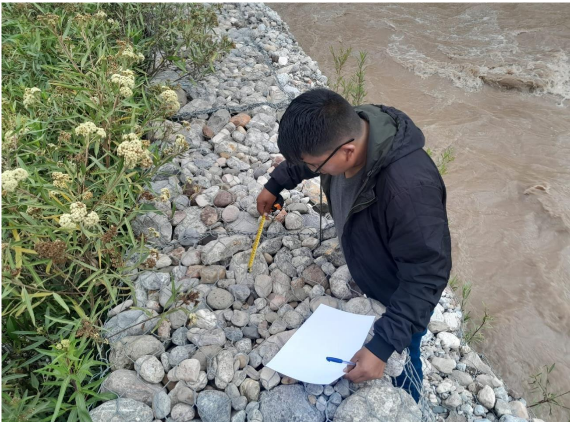
Foto 04: Se observa diferentes diámetros de los materiales empleados en el muro de gavión.
