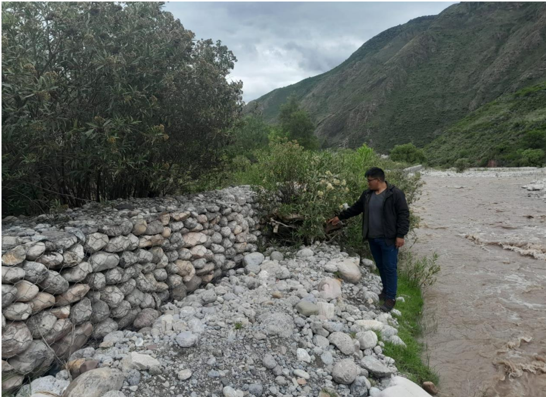
Foto 01: Se observa exceso de vegetación alrededor de la estructura.
