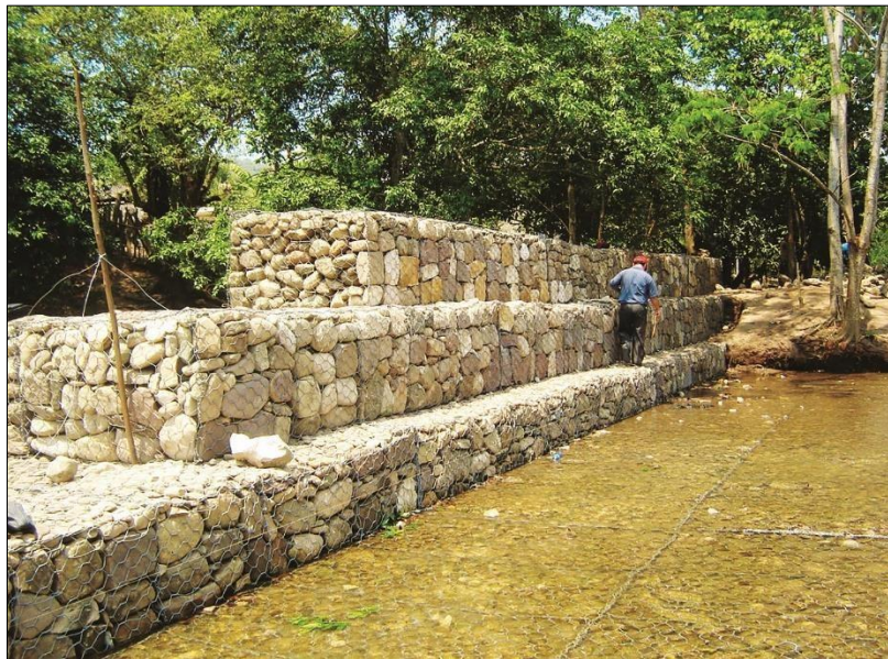
Figura 07: Resistencia de los muros de gaviones.
