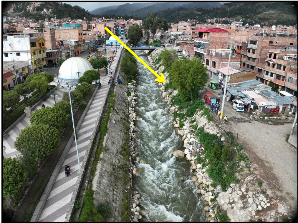
figura 36: Foto Panorámica observando los árboles crecidos y cultivo en el enrocado desplomado Fuente: Elaboración propia.
