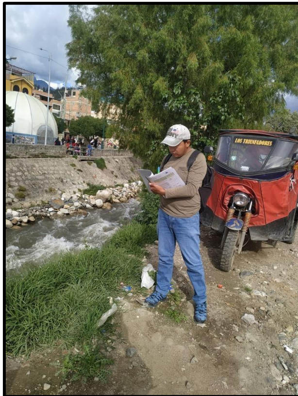
figura 27: Realizando la observación del enrocado en la progresiva 00+83 mts Fuente: Elaboración propia.
