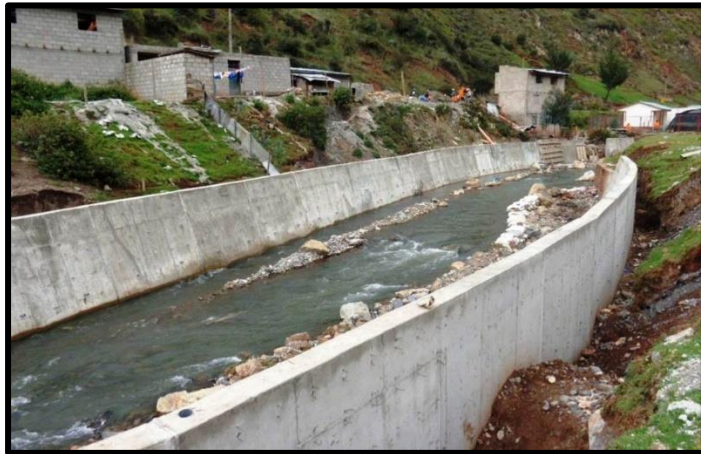
figura 6: Defensa ribereña de concreto armado
