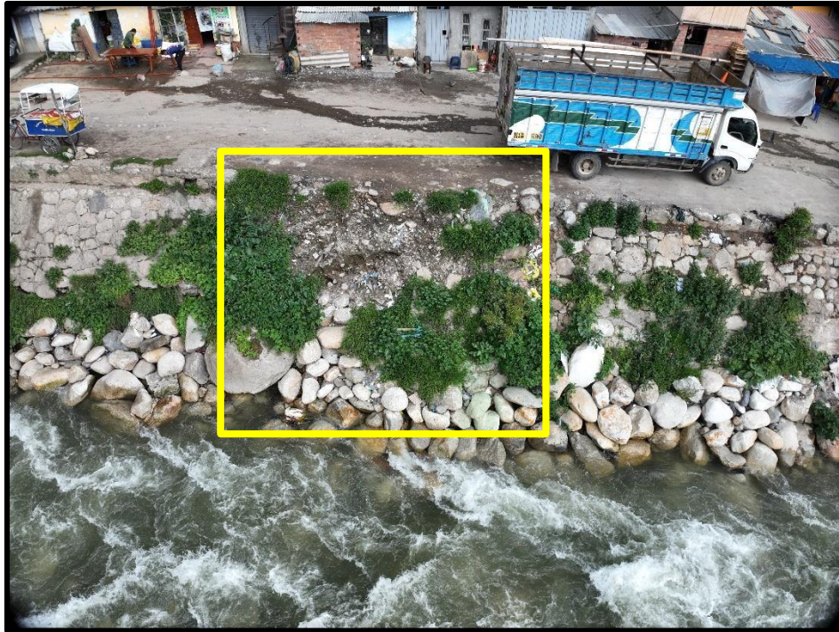
figura 38: Foto del enrocado desplomado Fuente: Elaboración propia.
