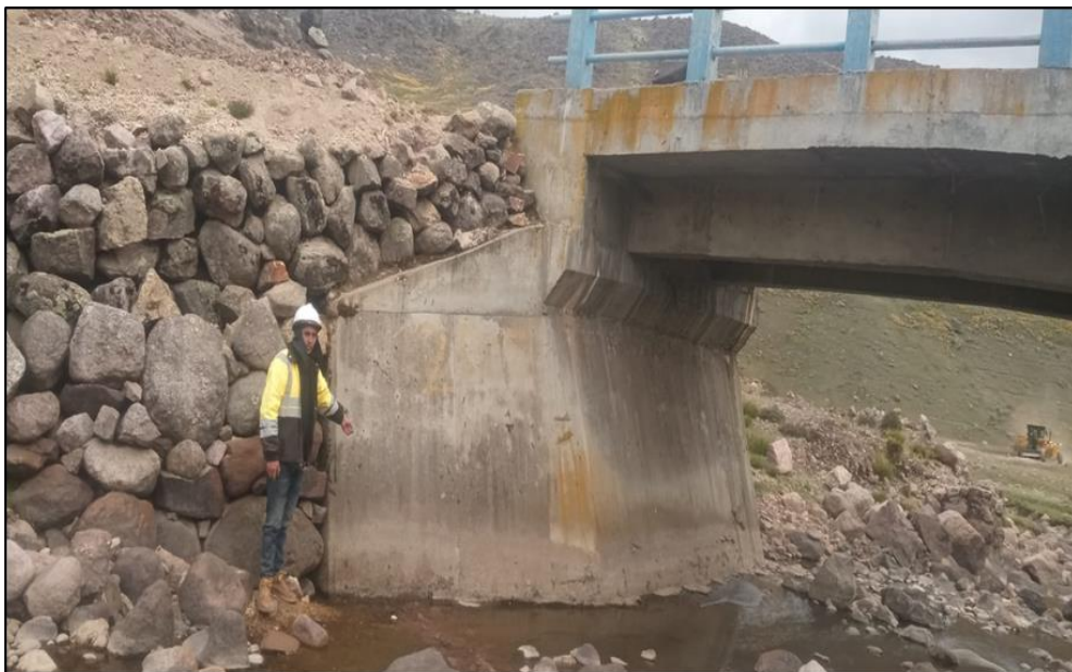
Imagen 04: Socavación de puente Cayramayo estribo izquierdo y derecho.
