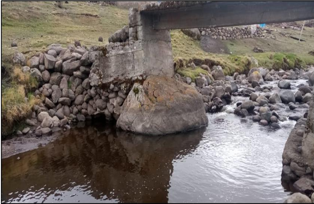
Imagen 07: Muro de protección en socavación.
