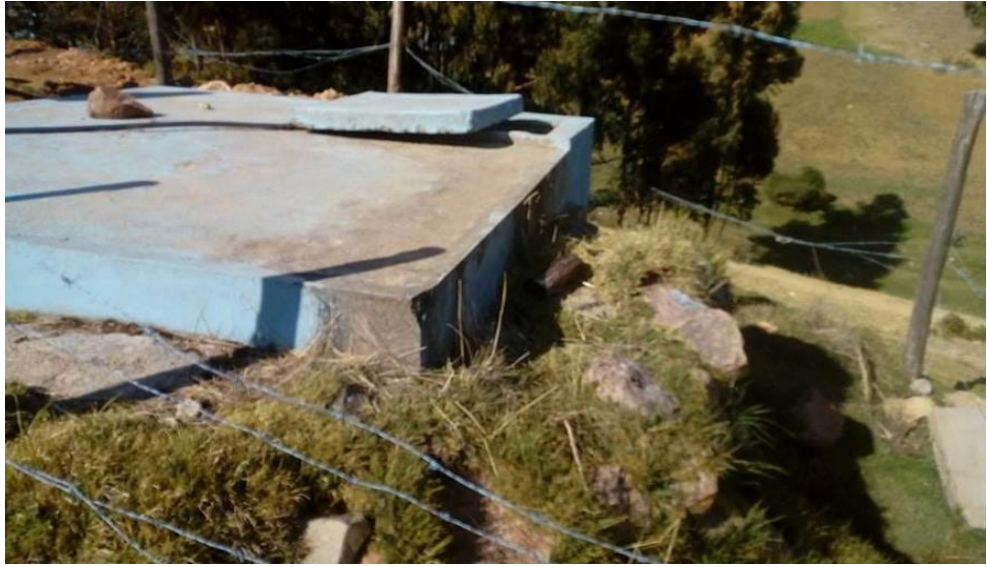
Figura 5: Reservorio de la localidad
