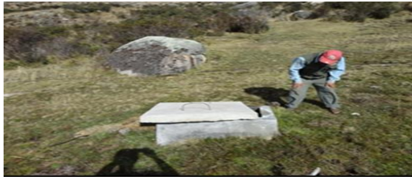
Figura 6: Cámara de rompe presión
