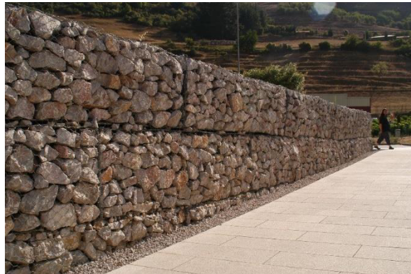
Figura 4 Muro de Gaviones
