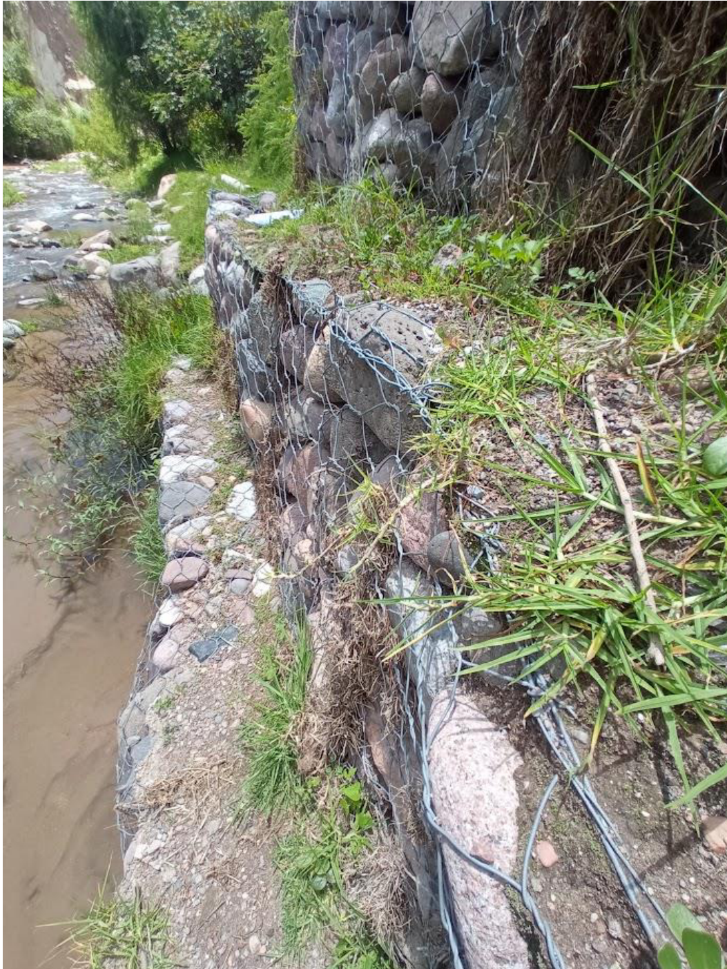
Imagen 24: Se observan ligeras deformaciones en la extensión del primer y segundo nivel del muro de gaviones
