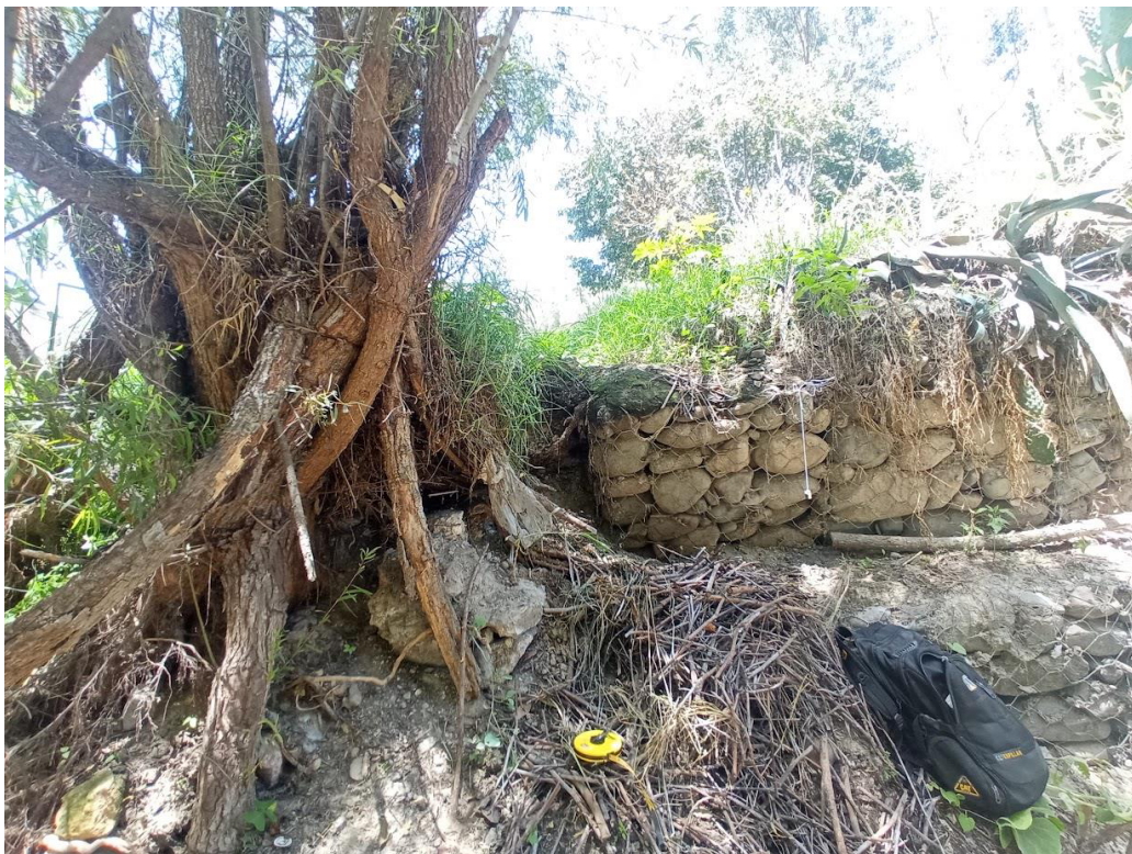
Imagen 7: Se observa la presencia de un árbol, el que ha deteriorado casi completamente el muro entre las progresivas 00+070 y 00+080
