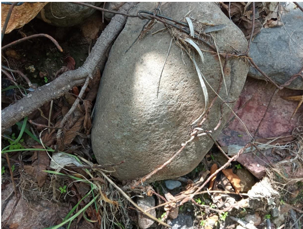
Imagen 27: Se observa la rotura de la malla debido al oxido y deformación del gavión
