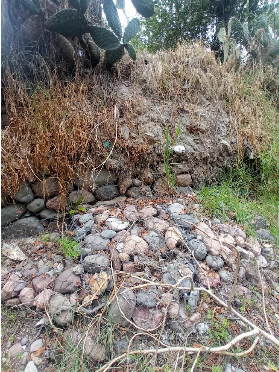
Imagen 13: Se puede observar que los correspondientes al primer nivel se encuentran completamente deformados, con rotura en las mallas y perdida de relleno. Progresiva 00+070 a 00+080
