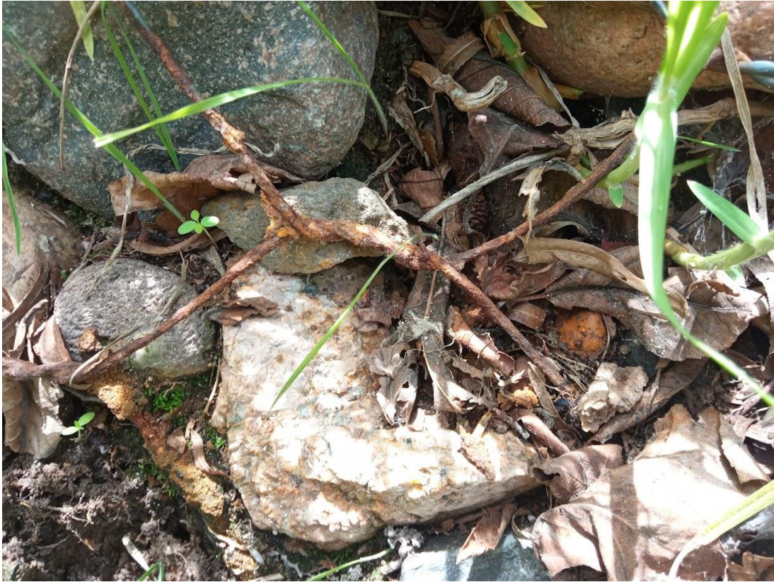
Imagen 28: Grado avanzado de oxidación en las mallas hexagonales de triple torsión
