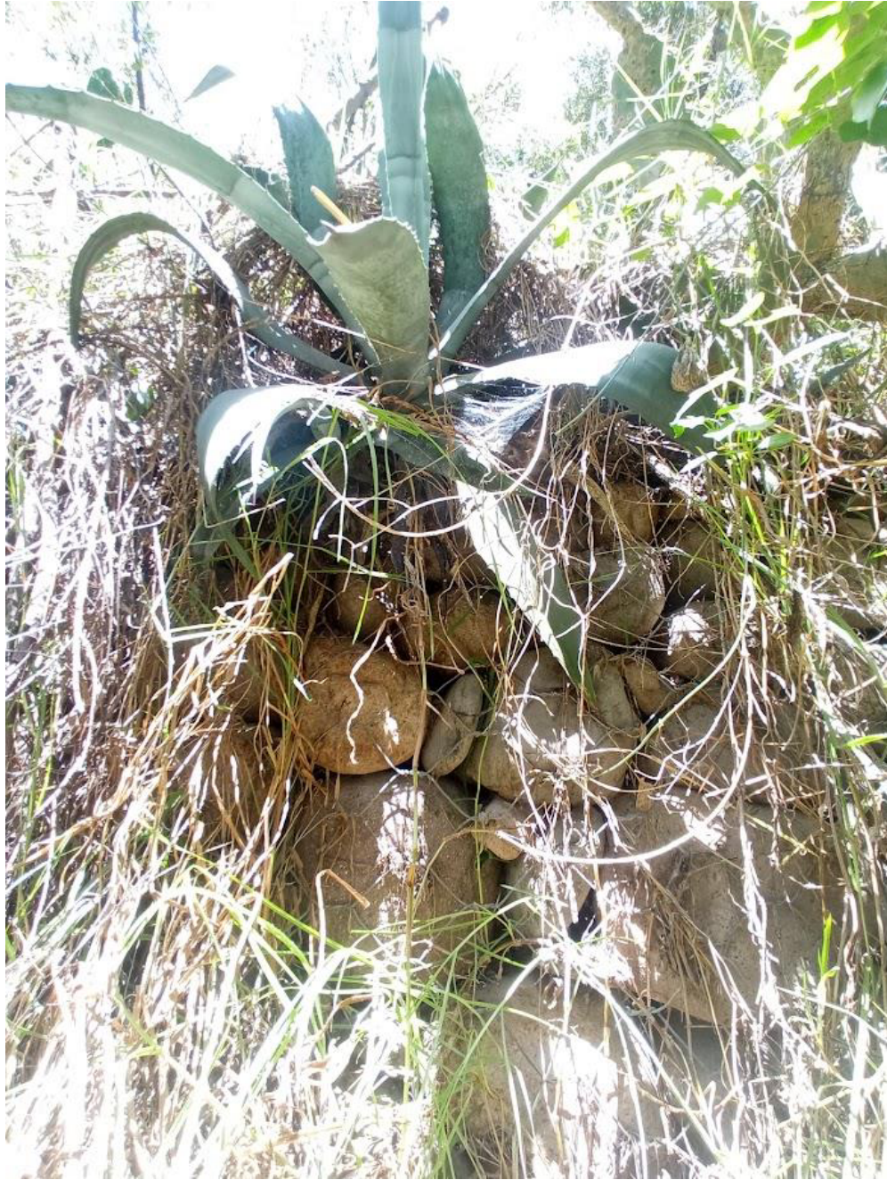
Imagen 14: Se observa el crecimiento de plantas de gran tamaño en el tercer nivel del gavión
