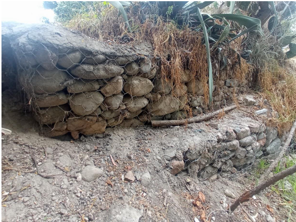
Imagen 9: Se observa que el muro ha sufrido volcamiento, además de la deformación de los gaviones. Progresiva 00+070 a 00+080
