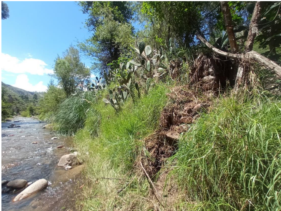
Imagen 16: se observa la presencia de plantas en todos los niveles del muro de gaviones. Progresiva 00+090 a 00+100
