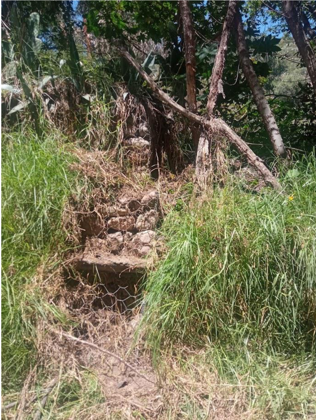
Imagen 17: Se visualiza la parte final del muro de gaviones que limita con una defensa artesanal tipo trinchera elaborada de troncos
