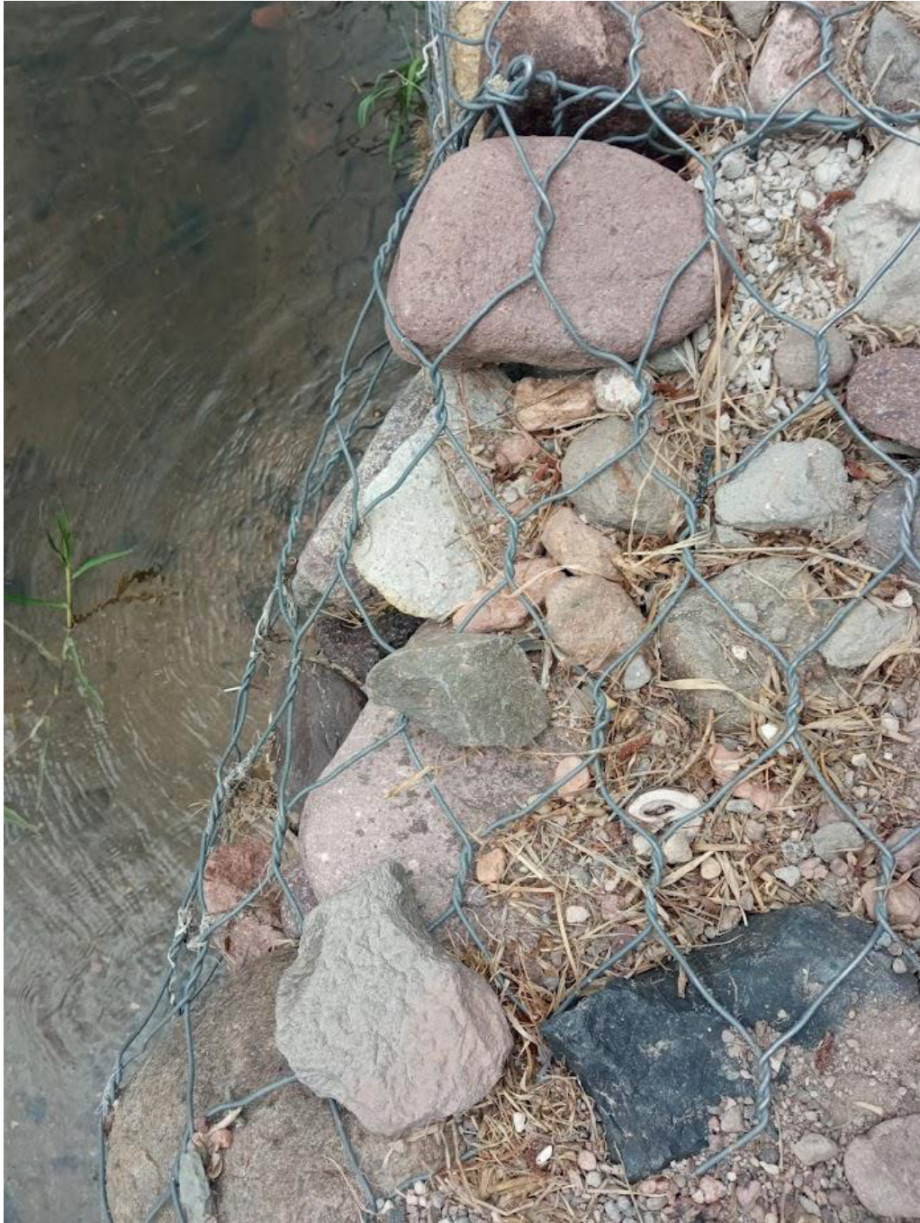
Imagen 23: Presencia de piedras muy pequeñas en el relleno del gavión, lo que ocasiono la deformación del mismo
