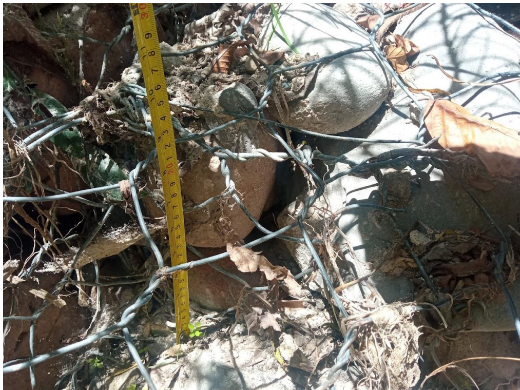
Imagen 22: Se muestra el deterioro y perdida de relleno en los gaviones del primer nivel. Progresiva 00+070 a 00+080
