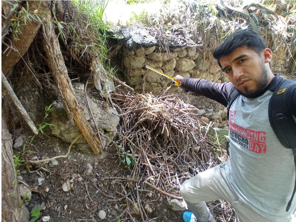
Imagen 6: Mi persona señalando la sección de muro que sufrió volcamiento progresivas 00+070 y 00+080
