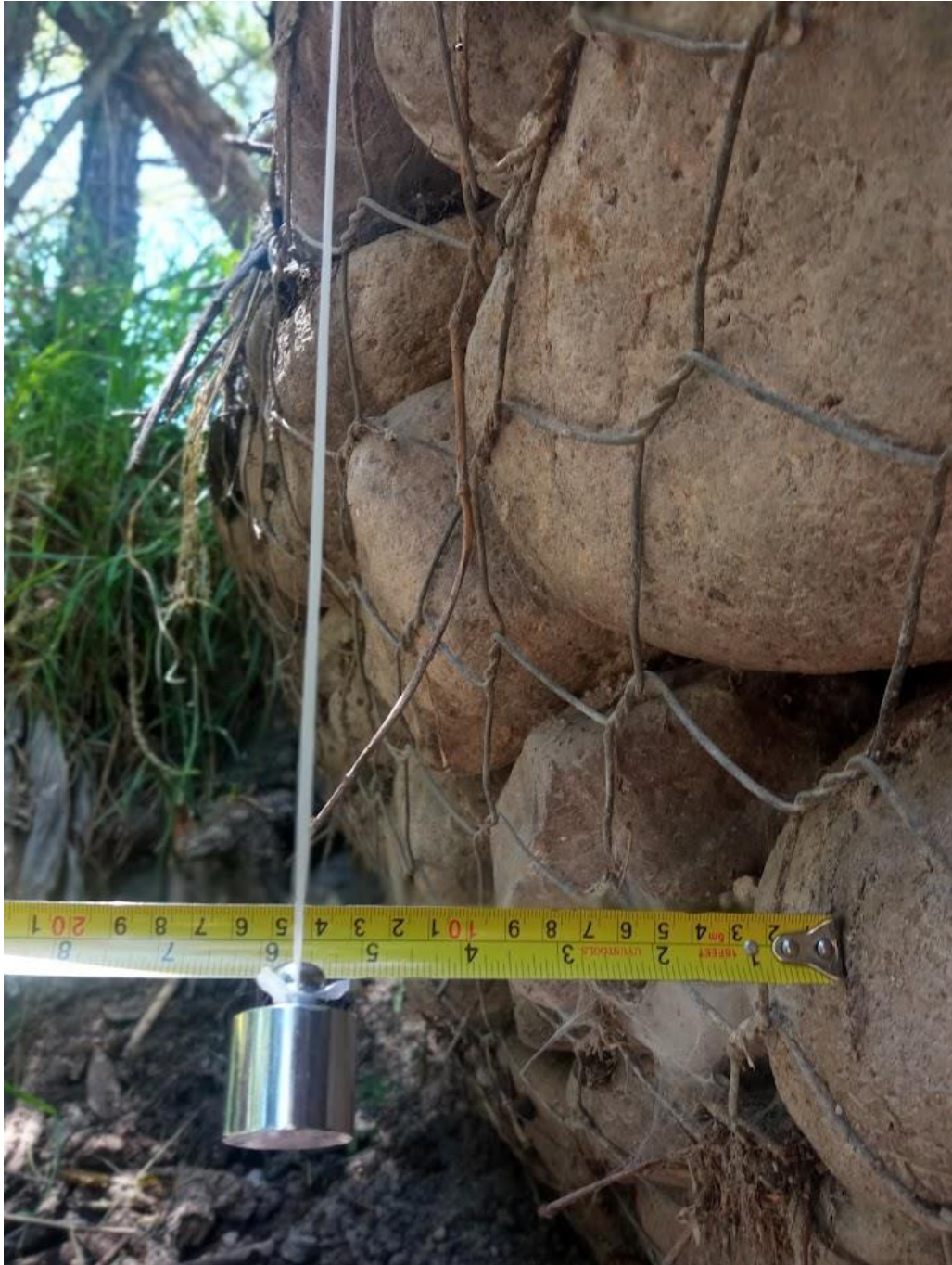
Imagen 10: Se realizo la comprobación de la magnitud del vuelco del muro de gaviones. Progresiva 00+070 a 00+080
