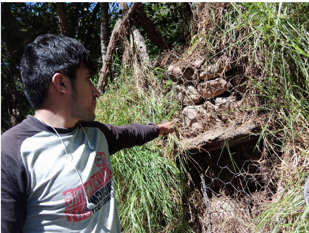
Imagen 31: Se observa el muro de gaviones cubierto completamente por vegetación y con pérdida de relleno en primer nivel. Progresiva 00+090 a00+100
