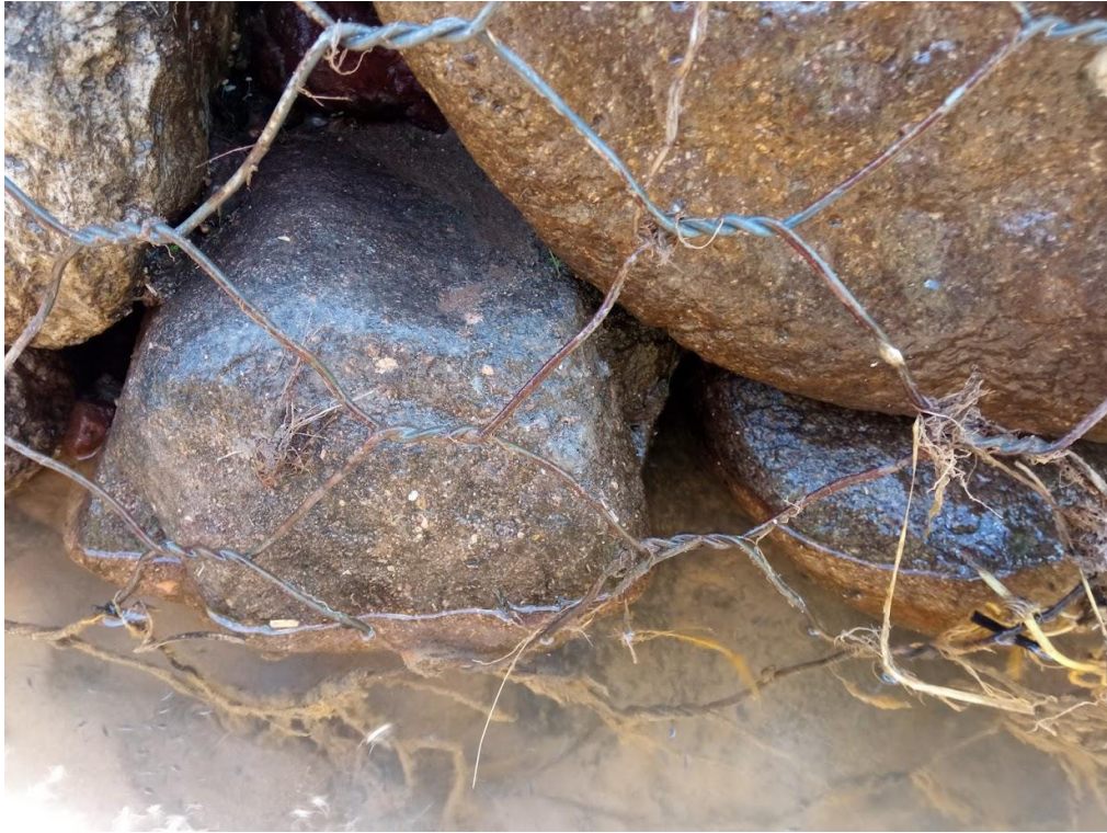
Imagen 26: Presencia de oxido en los alambres de las mallas hexagonales que conforman los gaviones del primer nivel
