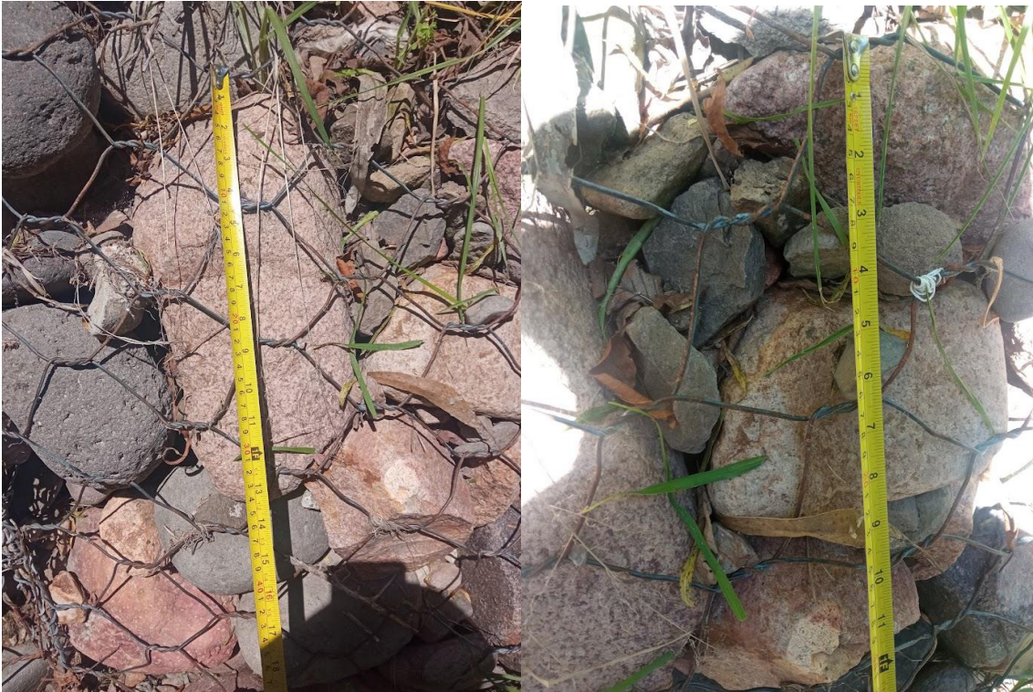
Imagen 21: Se evidencia las medidas inadecuadas de relleno piedras muy grandes y muy pequeñas
