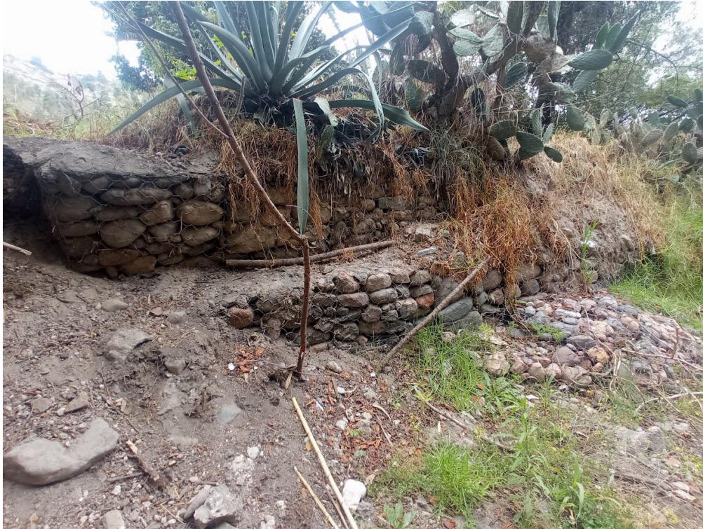
Imagen 11: Se puede apreciar el hundimiento del muro además de la deformación de los gaviones
