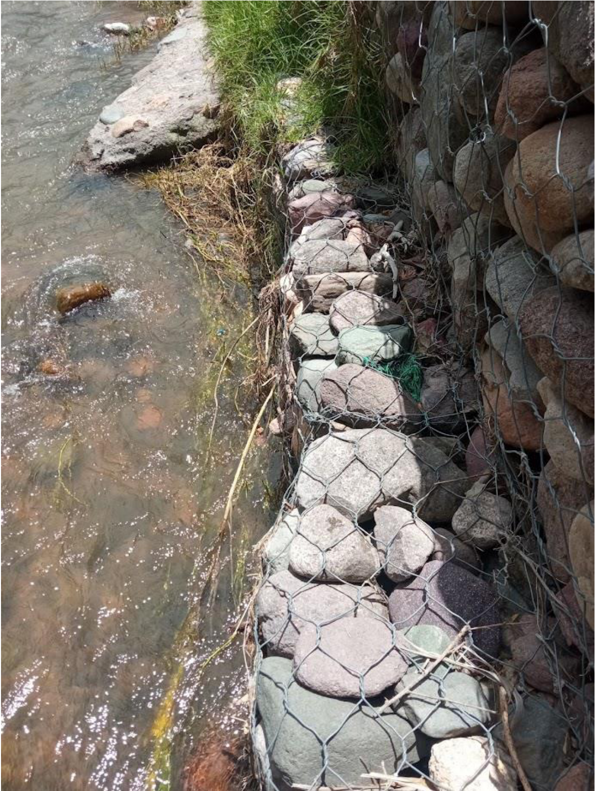
Imagen 25: Deformación en los gaviones del primer nivel. Progresiva 00+040 a 00+050
