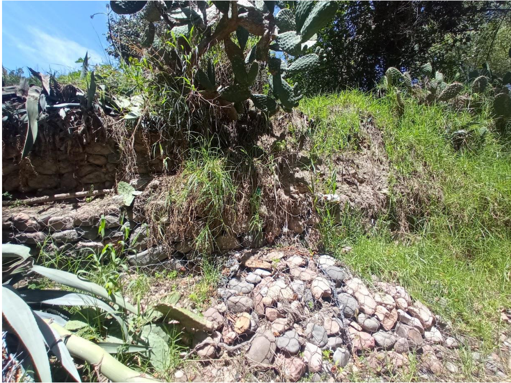
Imagen 30: Se aprecia el grado de deterioro de los gaviones, afectados por la vegetación y otros factores
