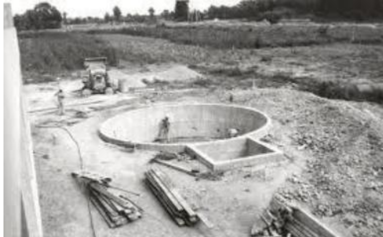
Figura N° 016. Reservorio enterrado Fuente: Ríos J.
