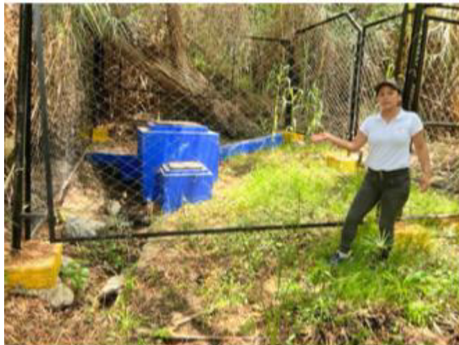
Figura N° 010. Captación de ladera Fuente: Elaboración propia – 2022
