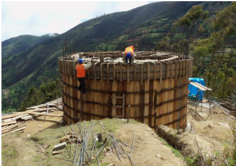
Figura N° 014. Reservorio apoyado de forma circular Fuente: HGD contratistas.
