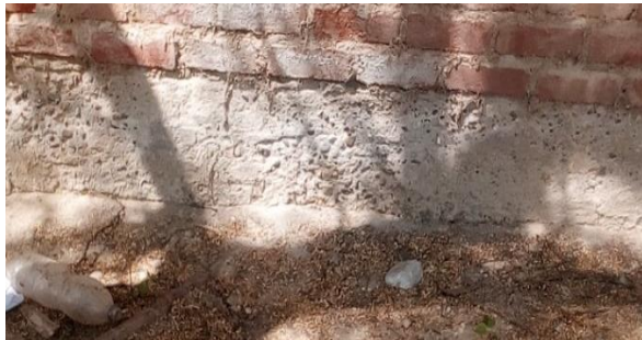
Figura 9 Delaminación en el concreto
