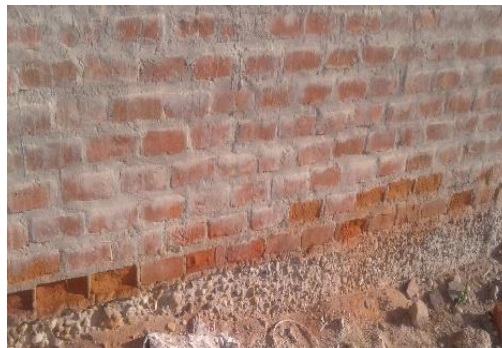
Figura 11 Erosión en muros de albañilería
