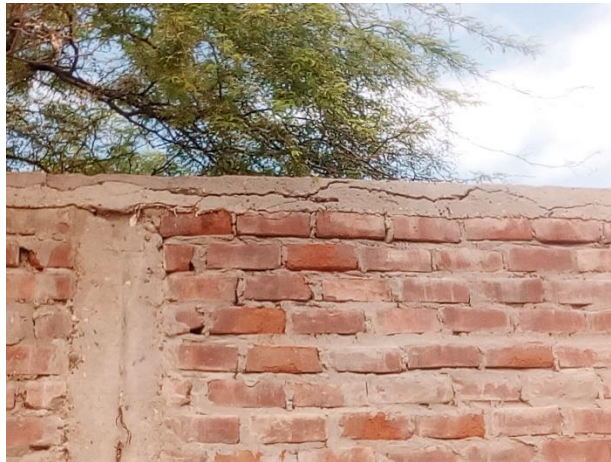
Figura 6 Agrietamiento en vigas
