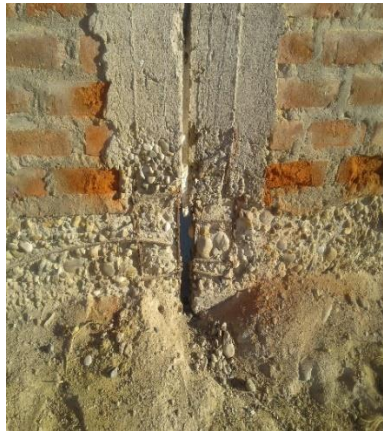
Figura 8 Corrosión del acero
