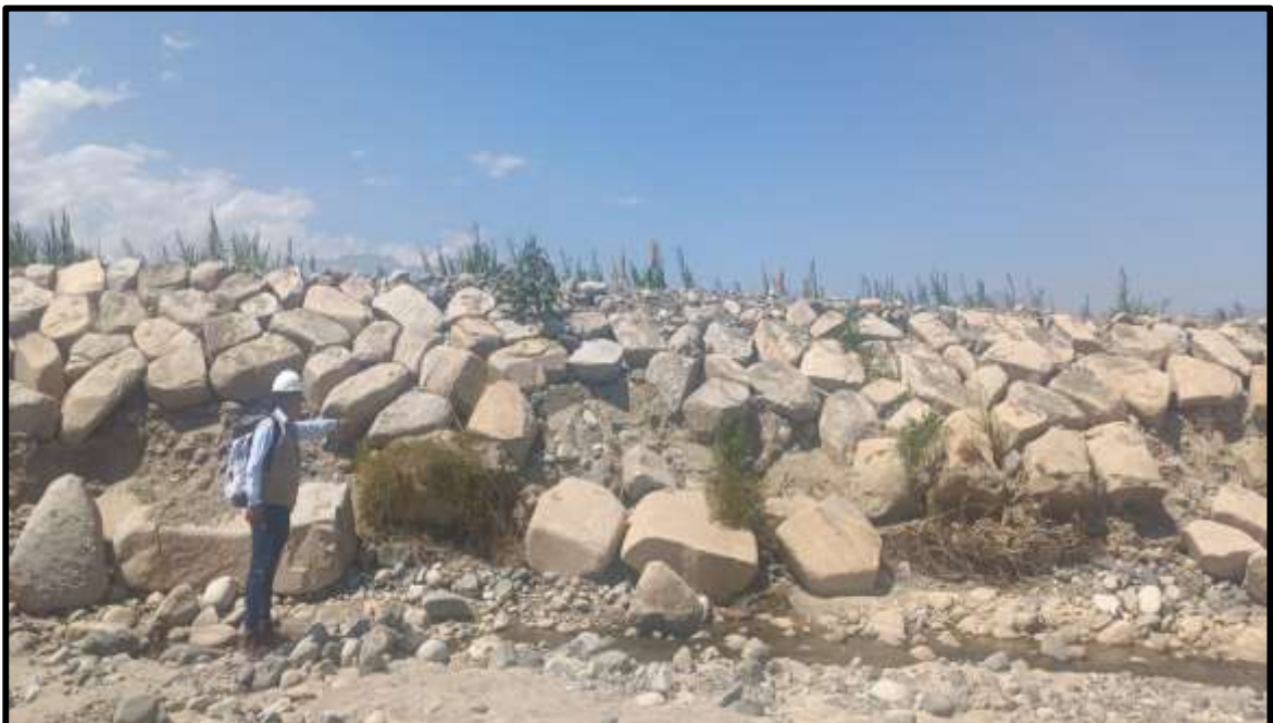
Figura 4: Se observa rocas desprendidas por suelo totalmente socavado, entre la progresiva 0+070 hasta 0+085.
