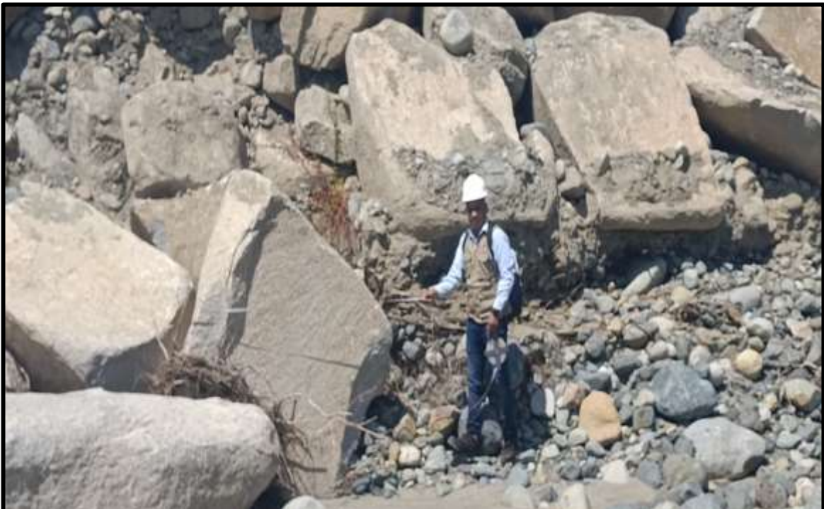
Figura 20: Toma de medida de enrocado desprendida en el tramo 0+090 hasta 0+095
