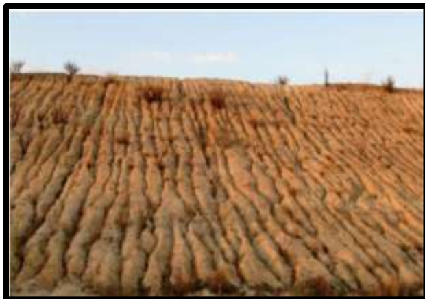
Figura 1. Erosión de talud
