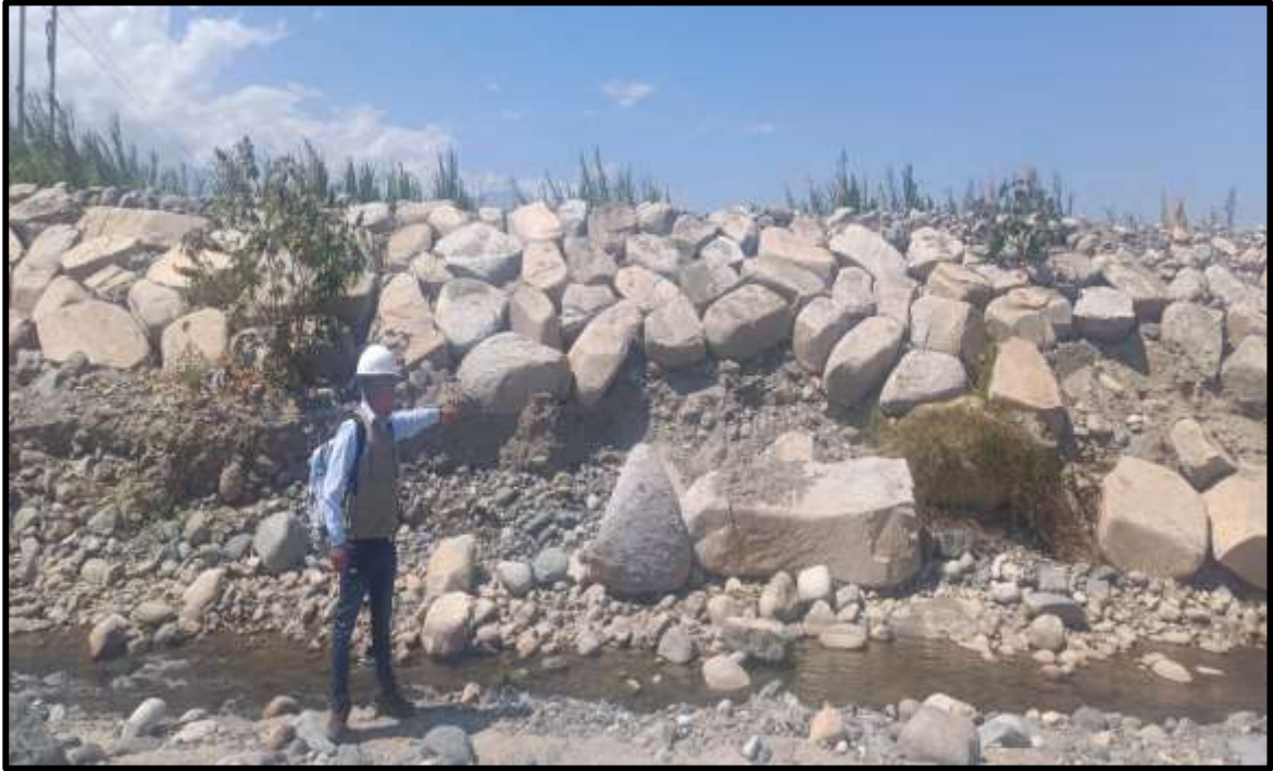
Figura 3: Se observa rocas desprendidas por suelo totalmente socavado, entre la progresiva 0+060 hasta 0+070.
