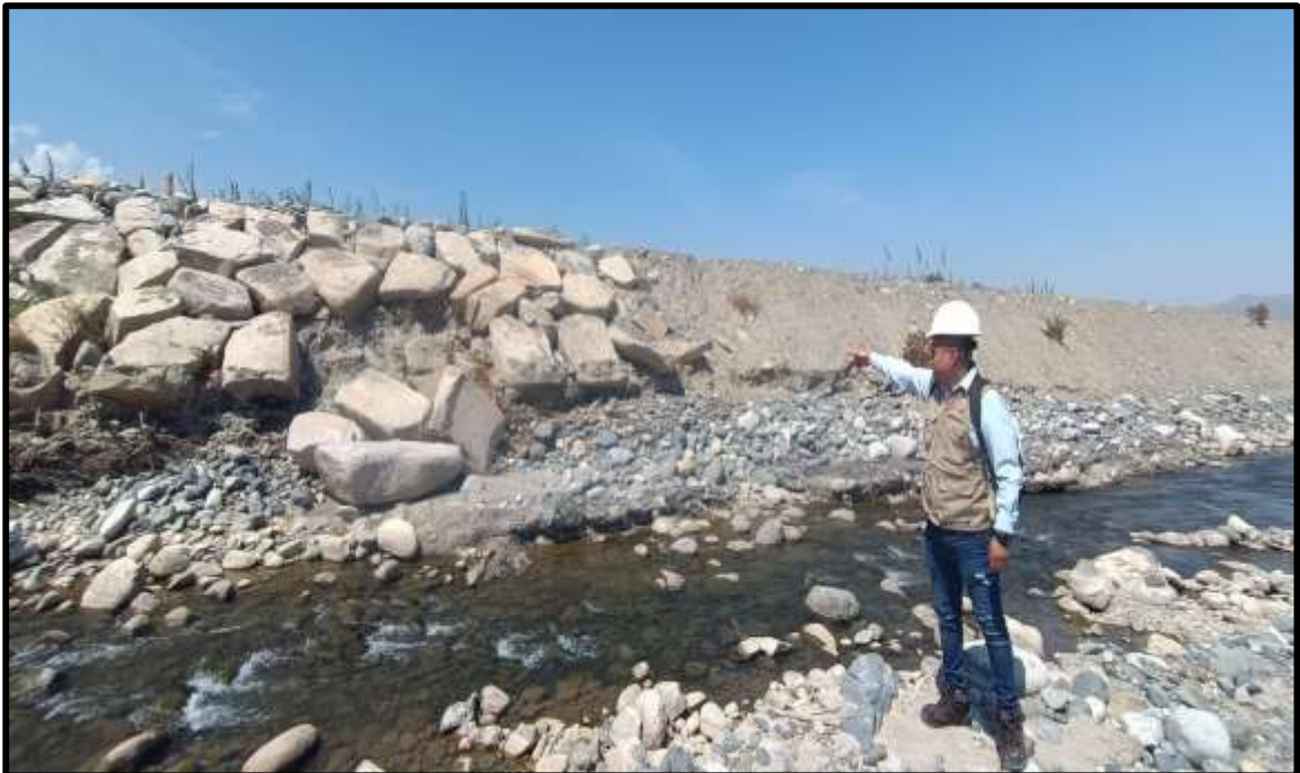
Figura 5: Se observa rocas desprendidas por suelo totalmente socavado, entre la progresiva 0+085 hasta 0+110.
