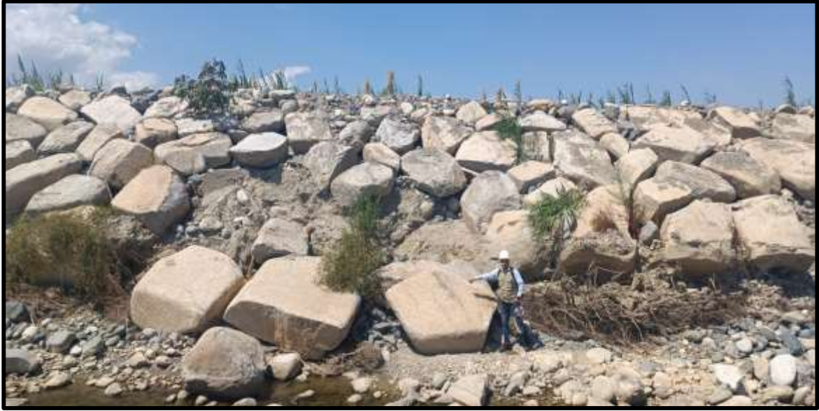
Figura 25: Midiendo enrocado desprendidos entre los tramos 0+080 hasta 0+090.
