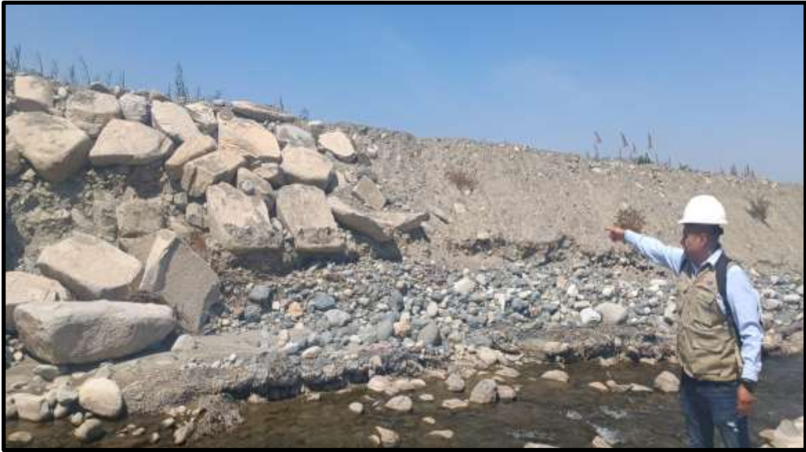
Figura 7: Se observa rocas totalmente inestables por estar sobre una base totalmente socavada ente la progresiva 0+085 hasta 0+110.
