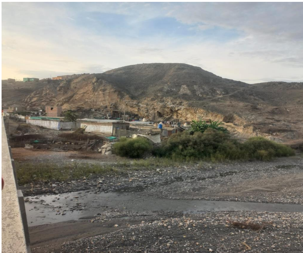
Figura 22: Enrocado lado derecho del puente Santa (Vista desde el puente). Fuente: Elaboración propia
