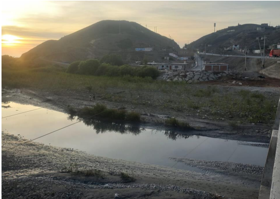
Figura 21: Longitud del enrocado lado izquierdo del puente Santa (Vista desde el puente). Fuente: Elaboración propia
