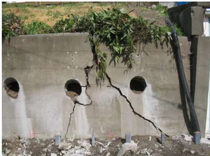
Figura 16 Patologías en Muros de Contención
