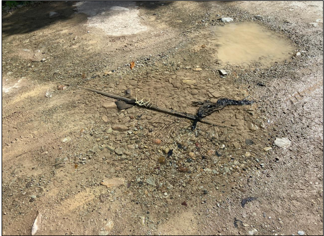
Figura 15: Tubería expuesta en la carretera cerca al enrocado existente
