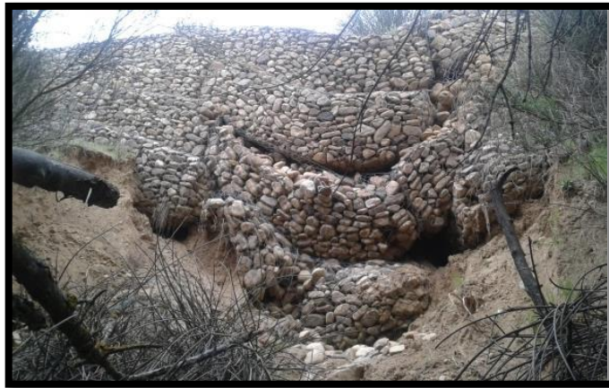
Figura 12: Asentamiento del Muro
