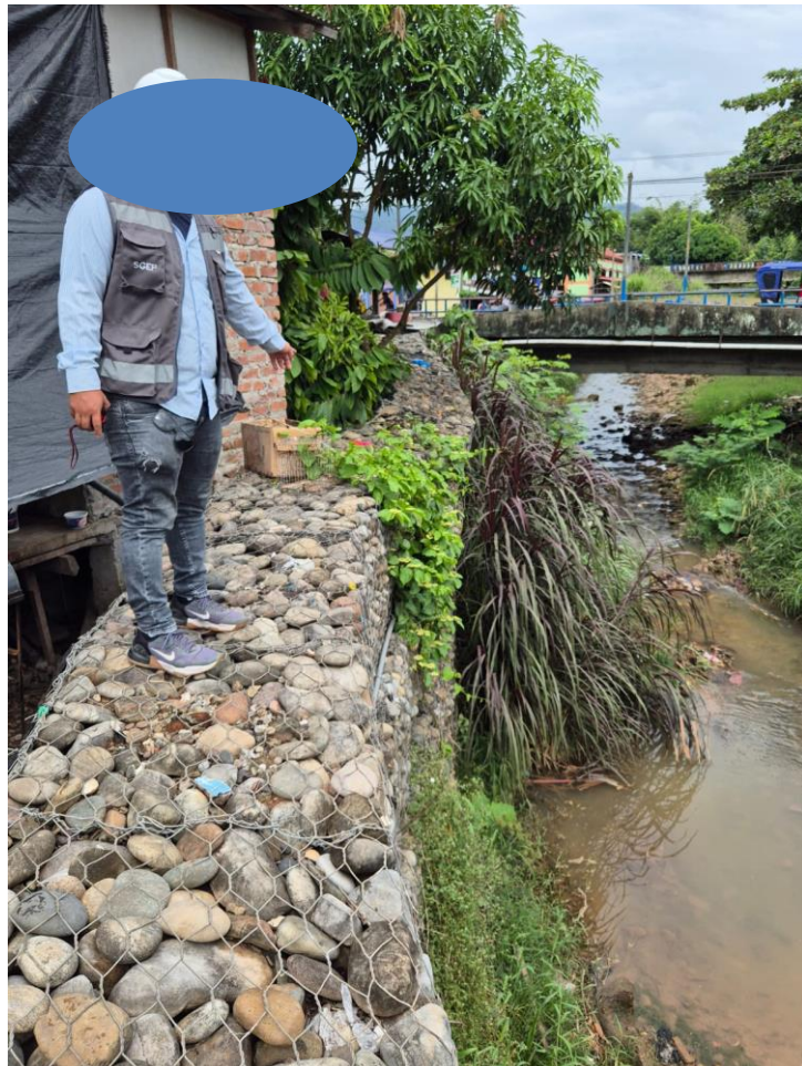
Figura 33: Desplazamiento de Muro de Gavión
