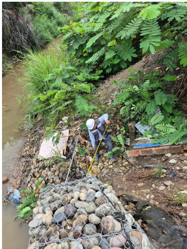
Figura 30: Derrumbe del Muro de Gavión
