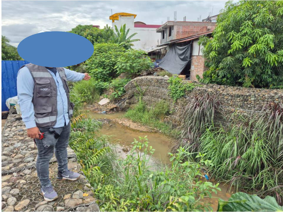
Figura 27: Colapso del Muro de Gavión
