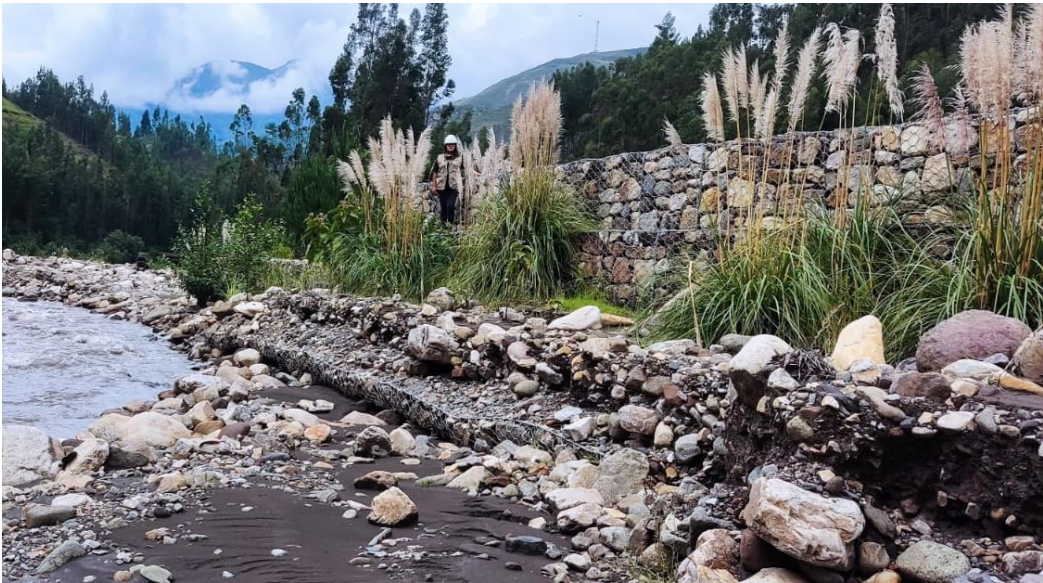
Figura 12. Se observa la presencia de vegetación en el 2 nivel del gavión tipo caja.
