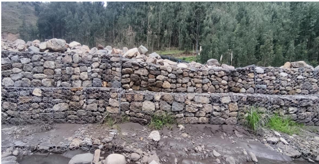
Figura 18. Se observa la socavación del muro de gaviones.
