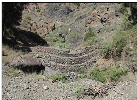
Figura 7. Deslizamiento de muro de gavión.
