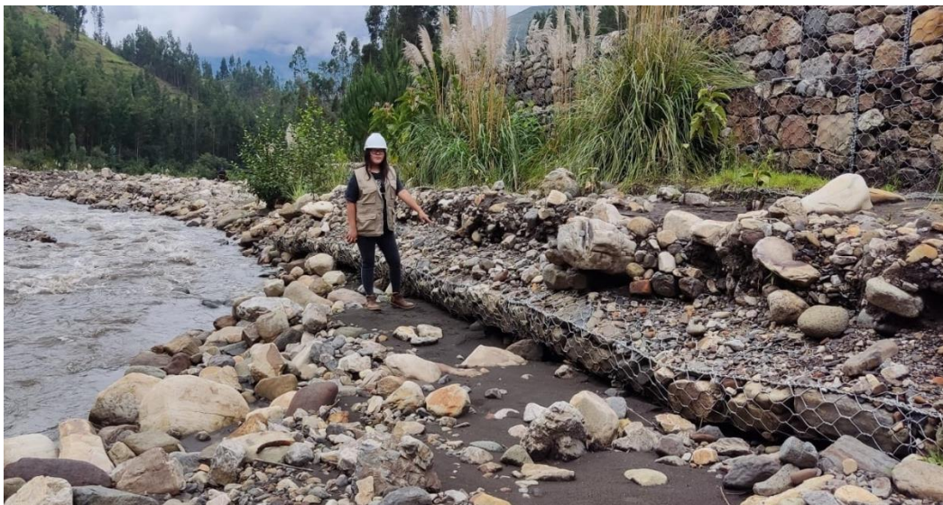
Figura 14. En el tercer bloque del muro se observ3 la malla rota, donde el material de relleno se ha desprendido de su estructura.
