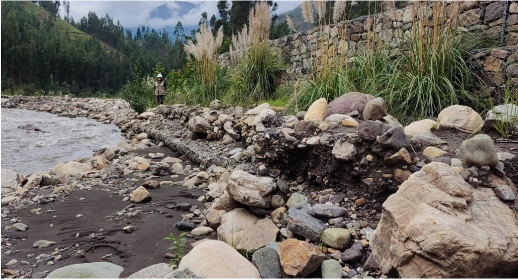
Figura 11. Estado deteriorado en el gavión tipo colchón
