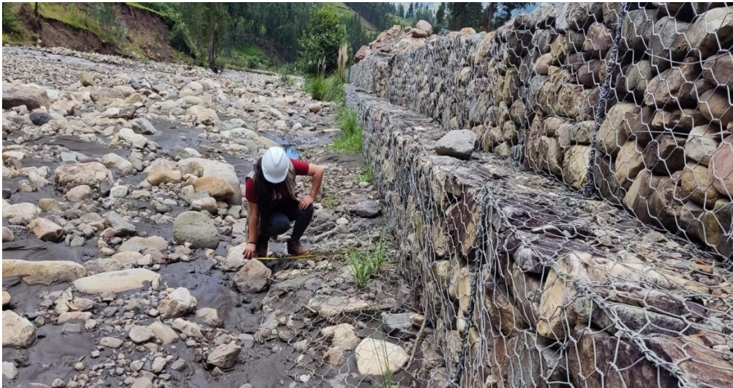
Figura 13. Presencia de sedimento en el gavi3n tipo colch3n
