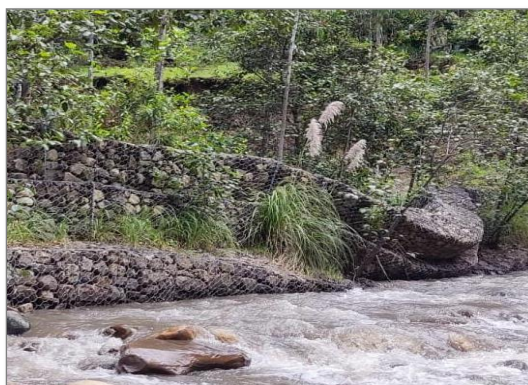
Figura 8. Vuelco o volteo de muro de gavión.
