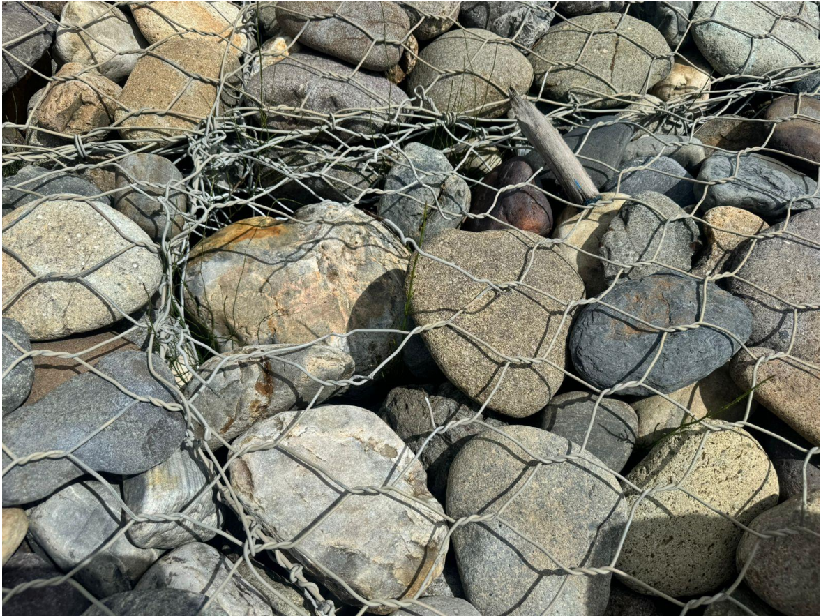
Figura 24. Malla en deformación con abertura grandes
