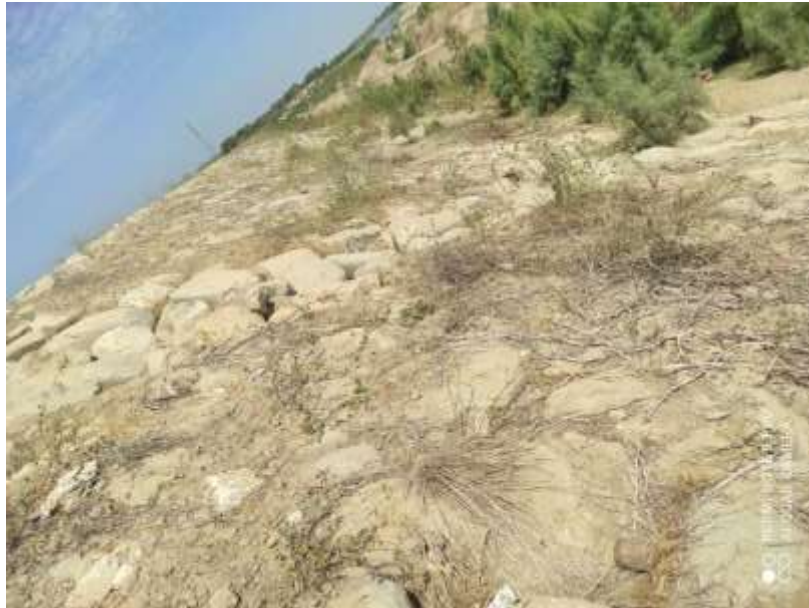
Figura 14: Enrocado -Progresiva 0+600 a 0+650- vegetación y desprendimiento de roca
