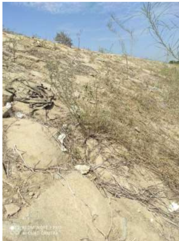
Figura 15: enrocado- Progresiva 0+650 a 0+700- Agrietamiento
