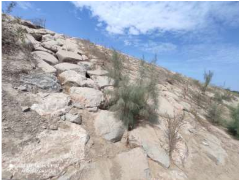
Figura 13: Desprendimiento de rocas en muro de enrocado del centro poblado
