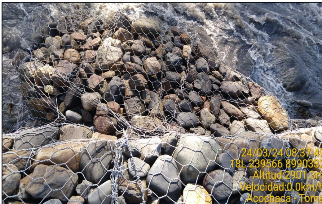
Figura 16: Imagen N° 06: Se observa el arranque de la aleta del segundo nivel escalonado del muro de gaviones, la cual servía de rompe presión del río para desviar el agua en esa curva.
