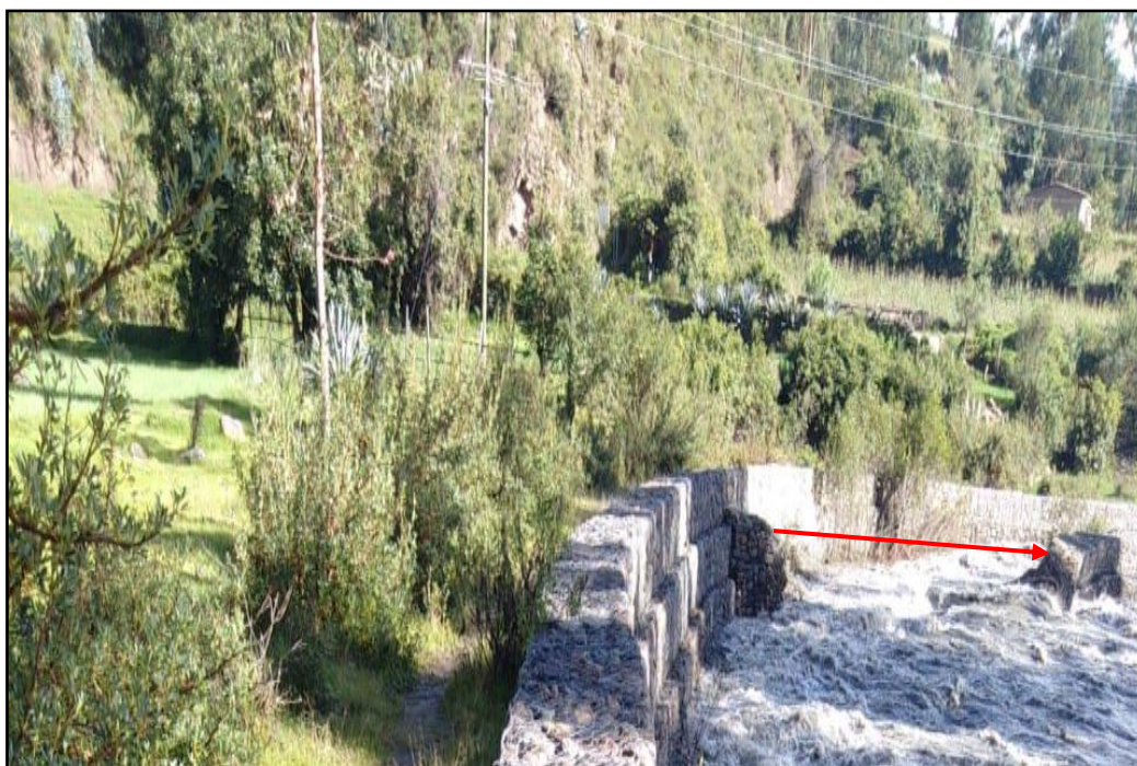
Figura 17: Imagen N a 07: Se observa la aleta arrancada del muro del segundo nivel de gavión por la crecida del río Acochaca.
