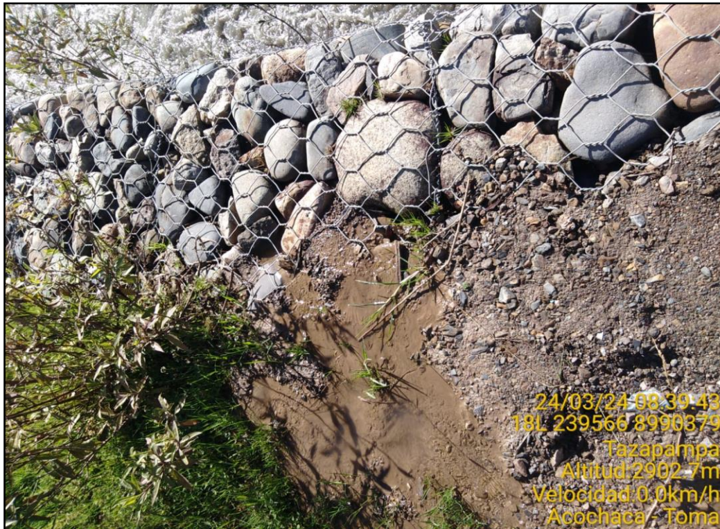
Figura 15: Se observa crecida de vegetación, desmonte y filtración en el último nivel del muro de gavión.
