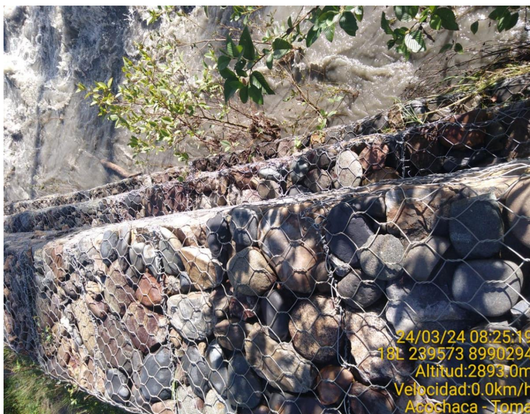
Figura 20: Imagen N o 10: Se aprecia la vista del muro de gavión de tres niveles.
