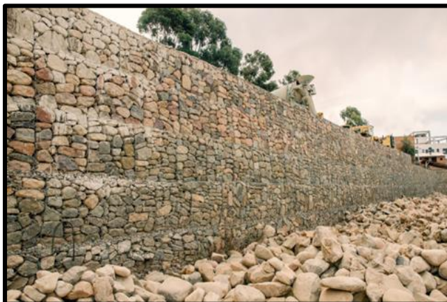
Figura 15: En la imagen podemos visualizar Muro de contención. Fue extraída de Fracassi (17).
