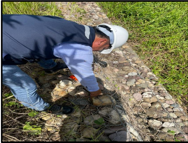
Figura 8: Medición de la rocas empleadas en las hiladas de los muro de gaviones
