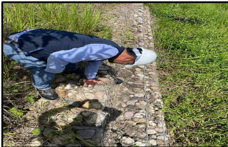
Figura 9: Punto de intervención donde se observa una deficiencia
