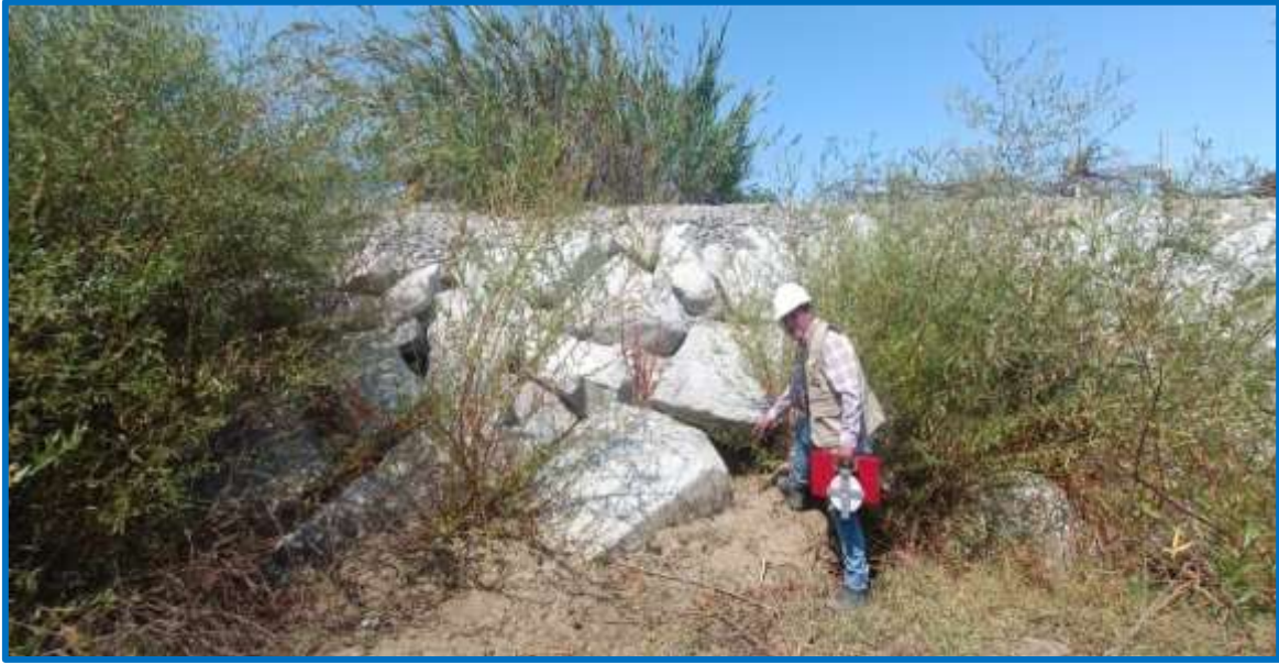
Figura 11. Se muestra suelo totalmente socavado
