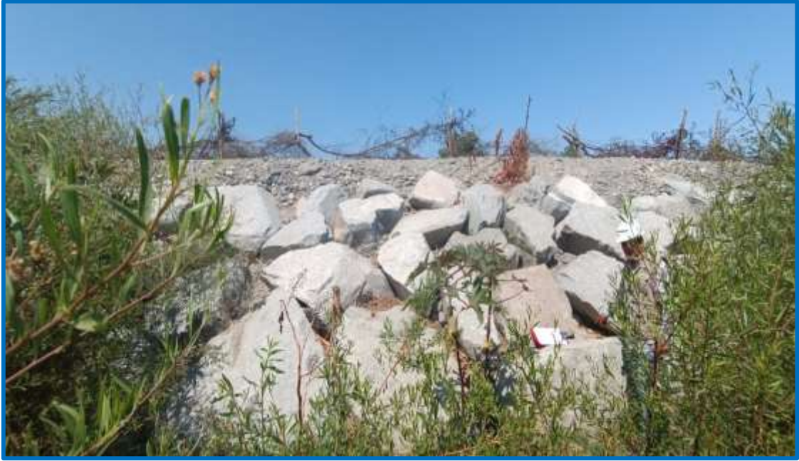
Figura 13. Se muestra presencia de arbustos, así como el talud erosionado
