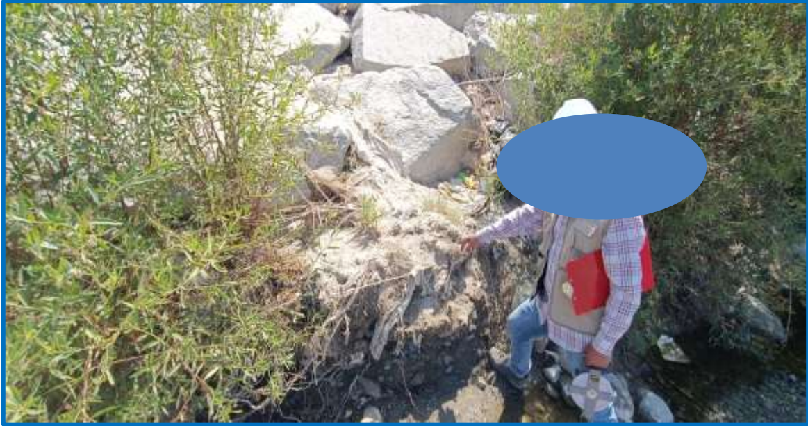
Figura 17. Se observó suelo total socavado desde la progresiva 0+100 hasta 0+190.
