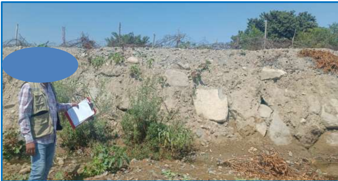
Figura 2. Se muestra erosión de talud desde la progresiva 0+030 hasta 0+070.
