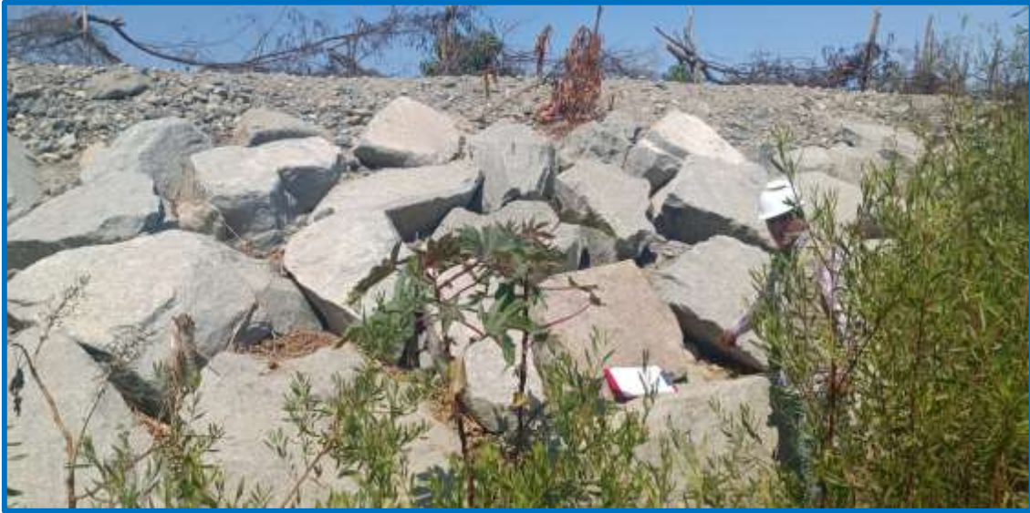
Figura 23. Se observa la presencia de mucho arbusto entre la progresiva 0+120 hasta 0+140
