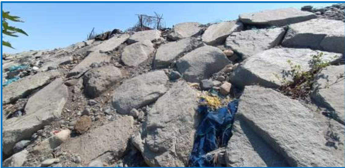
Figura 18. Se observó juntas con grandes espaciamientos desde la progresiva 0+000 hasta 0+100.
