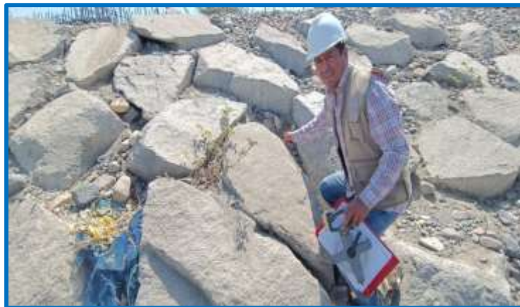
Figura 7. Evaluación de deterioro de juntas
