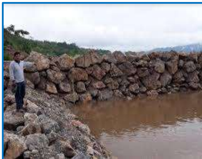
Figura 2. Estabilidad del enrocado
