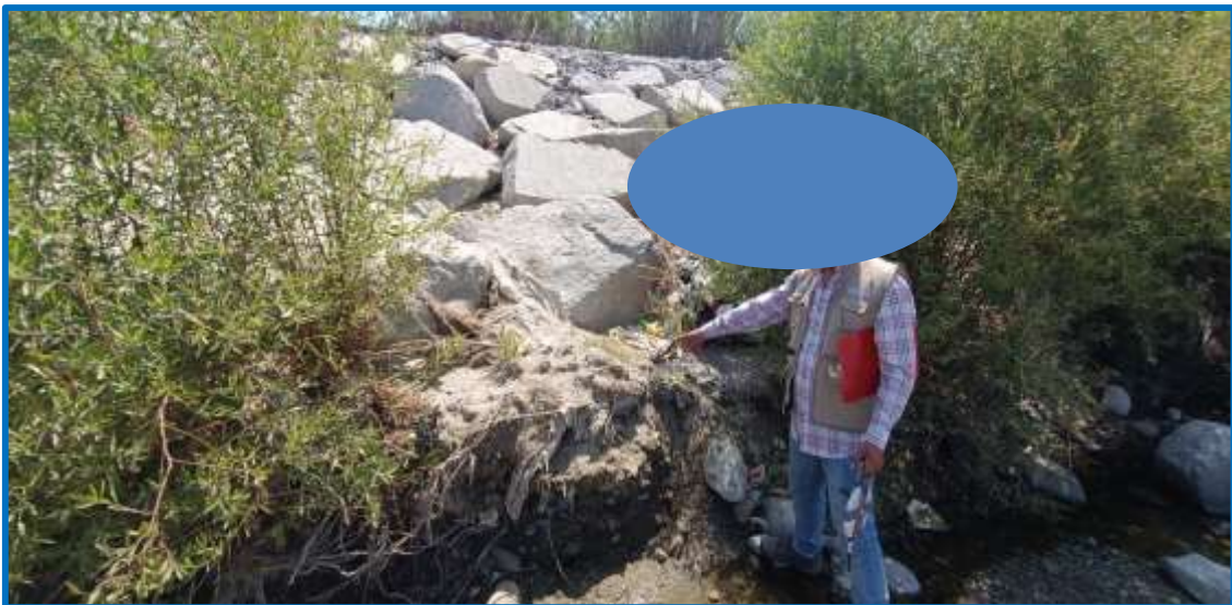
Figura 16. Se observa suelo total socavado desde la progresiva 0+000 hasta 0+100.
