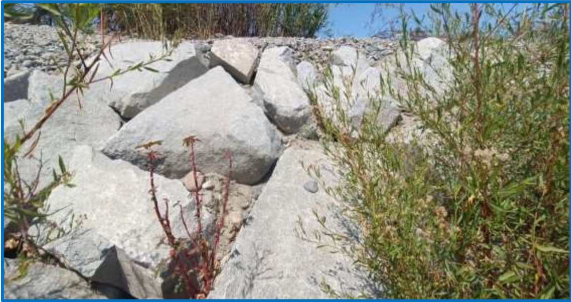
Figura 9. Se muestra enrocado totalmente inestable propenso a sufrir volteo.
