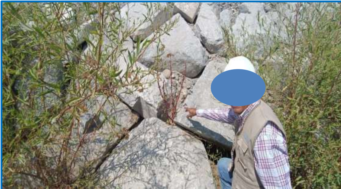
Figura 8. Se muestra enrocado desgastado y mala conexión de roca con roca.
