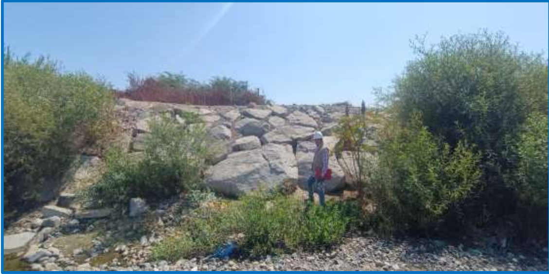
Figura 21. Se observa la presencia de mucho arbusto entre la progresiva 0+050 hasta 0+090
