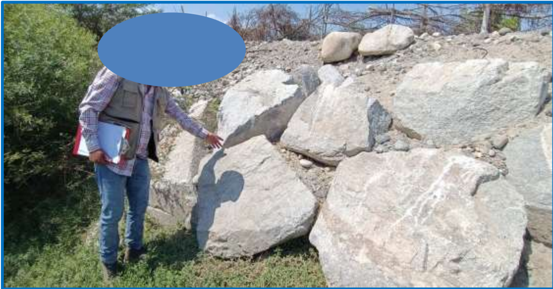
Figura 20. Se observa rocas deslizadas por contar con suelo socavado.
