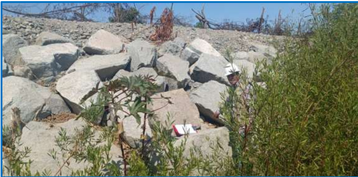
Figura 12. Se muestra la mala conexión de roca con roca la falta de protección de corona
