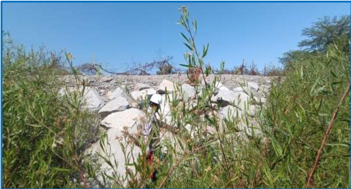
Figura 22. Se observa la presencia de mucho arbusto entre la progresiva 0+100 hasta 0+120
