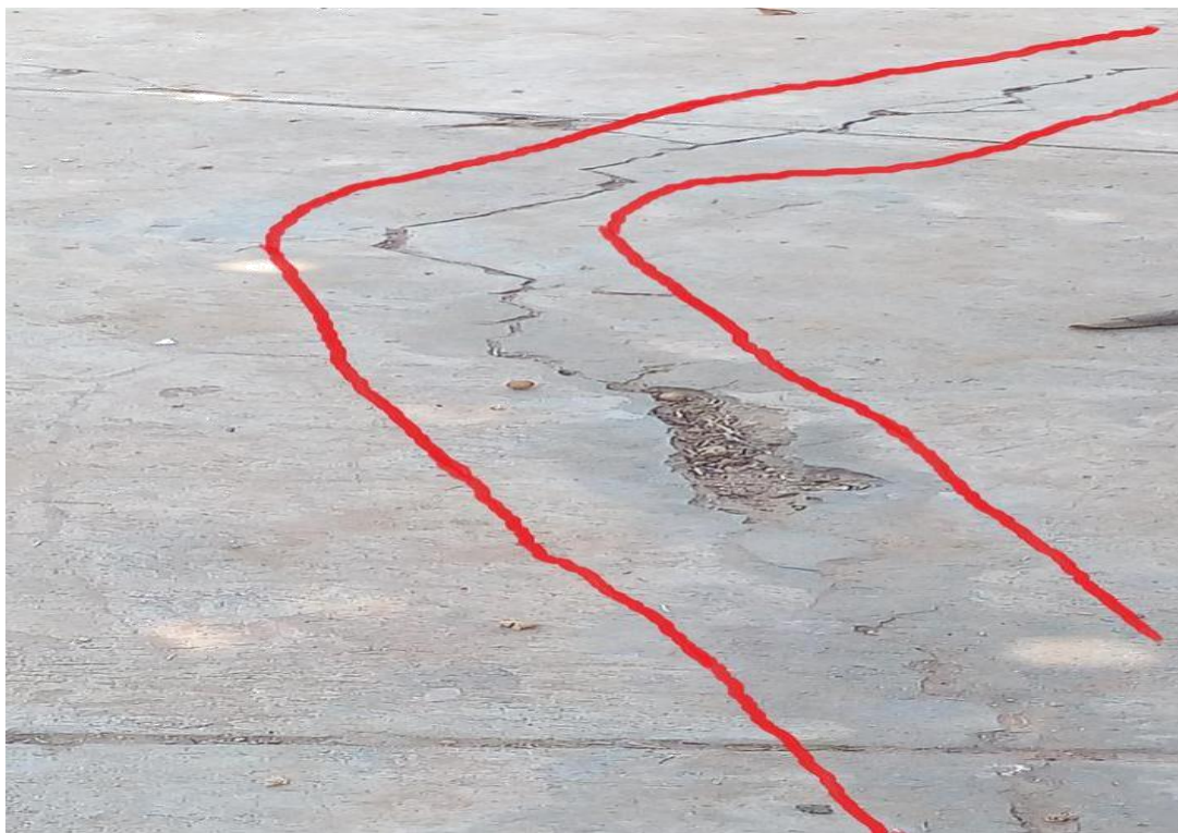
Figura N° 87: Paño del parque de esparcimiento Santa Rosa de Lima, con la patología Grieta Lineal, con severidad media.
