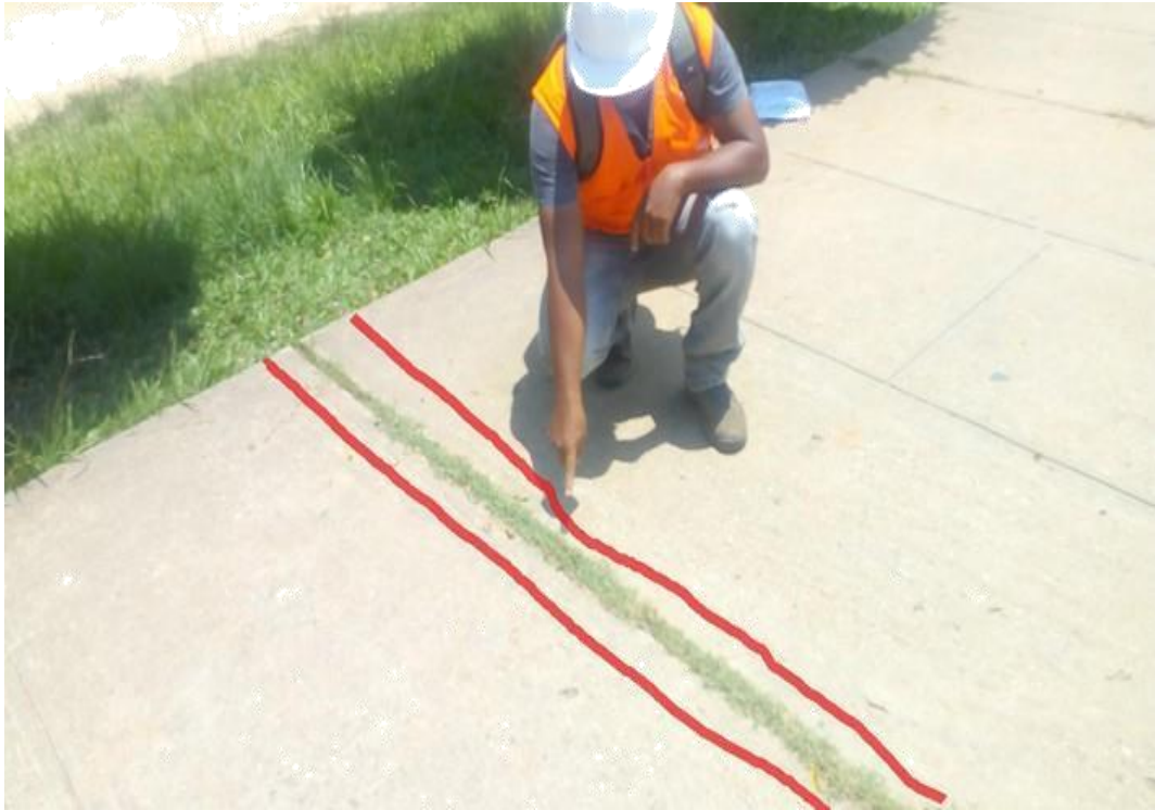
Figura N° 73: Paño de vereda del parque de esparcimiento Siete de Junio, con la patología Daño de Sello de la Junta, con severidad alta.
