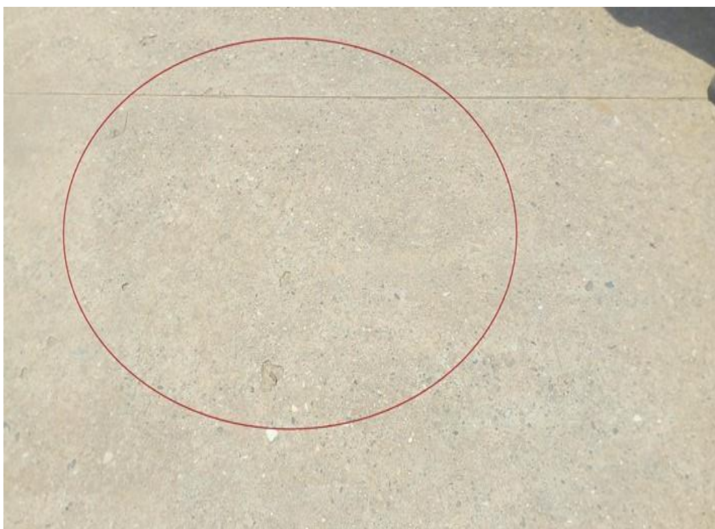
Figura N° 76: Paño de vereda del parque de esparcimiento Siete de Junio, con la patología Pulimento de Agregados, sin severidad media.
