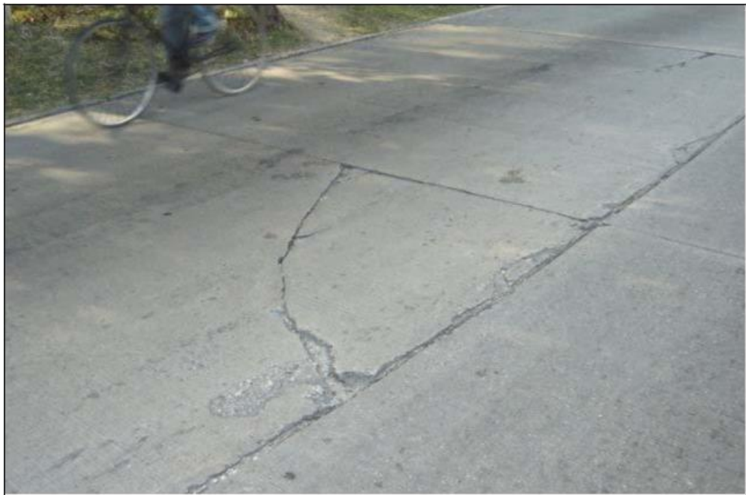
Figura N° 04: Vista típica de una Grieta des esquina.
