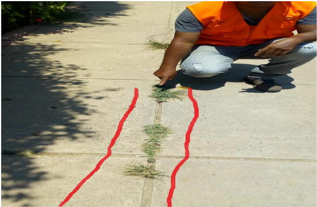
Figura N° 77: Paño de vereda del parque de esparcimiento Roca Fuerte, con la patología Daño de Sello de la Junta, con severidad media.
