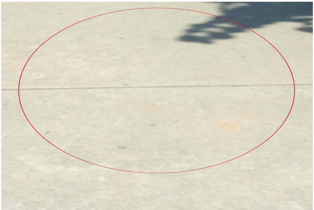
Figura N° 84: Paño del parque de esparcimiento La Chacrita, con la patología Pulimento de Agregados, con severidad media.
