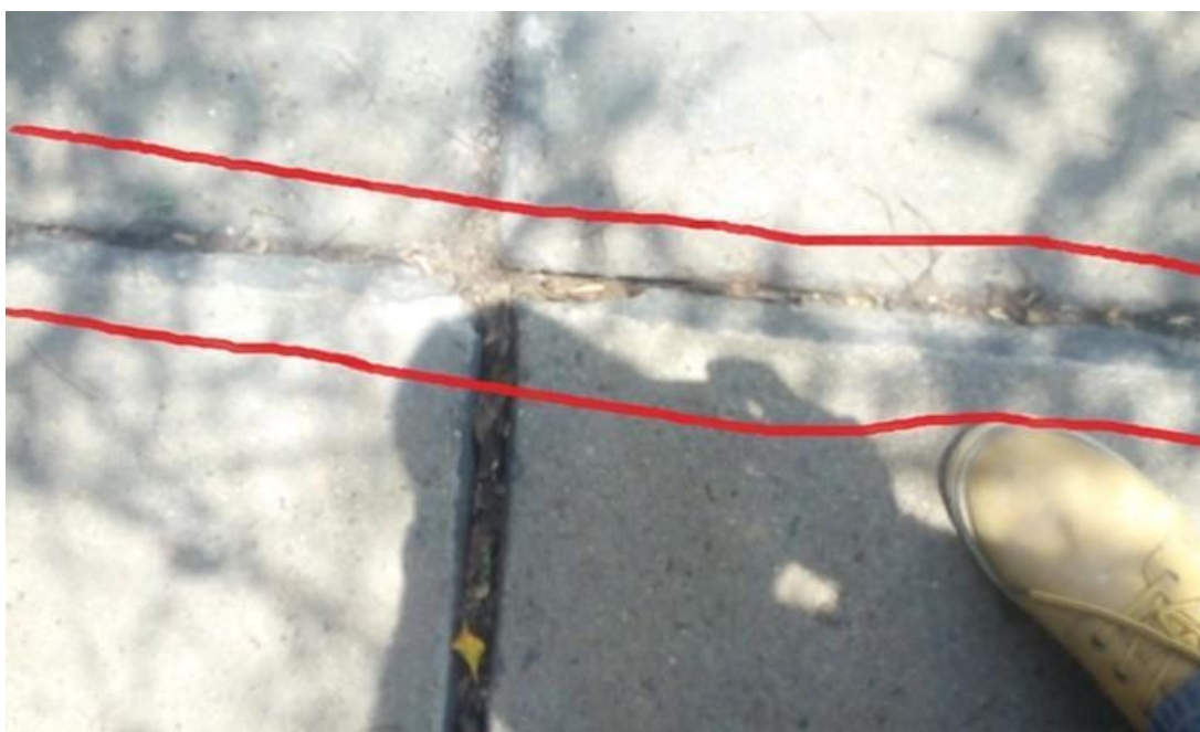
Figura N° 82: Paño del parque de esparcimiento La Chacrita, con la patología Daño del Sello de la Junta, con severidad media.
