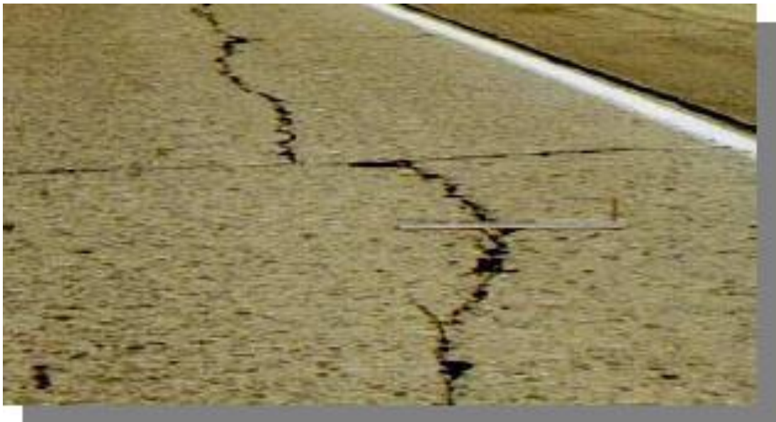
Figura N° 07: Vista típica de una Grieta Longitudinal. .
