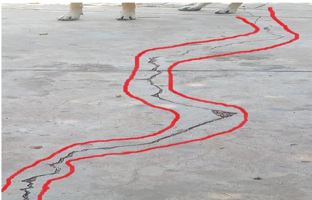
Figura N° 86: Paño del parque de esparcimiento Santa Rosa de Lima, con la patología Grieta Lineal, con severidad media.
