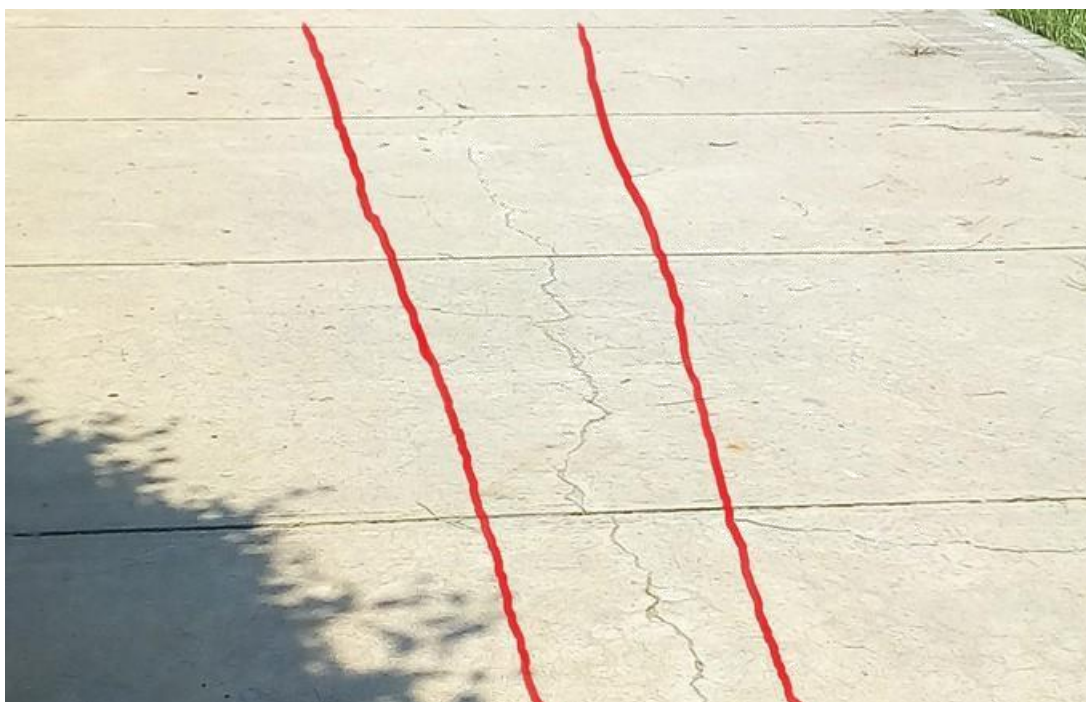
Figura N° 81: Paño del parque de esparcimiento La Chacrita, con la patología Grieta Lineal, con severidad media.
