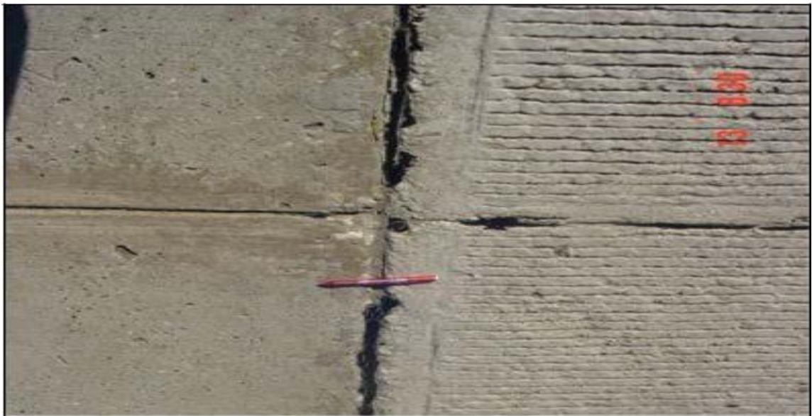
Figura N° 16: Vista típica de un Daño de Sello de la Junta.
