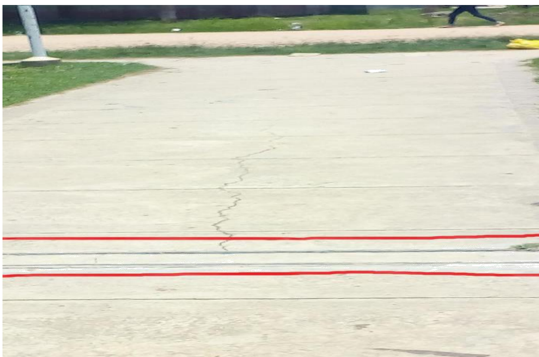
Figura N° 85: Paño del parque de esparcimiento Santa Rosa de Lima, con la patología Daño del Sello de la Junta, con severidad media.
