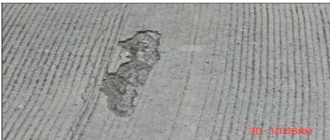
Figura N° 11: Vista típica de un Descascaramiento.
