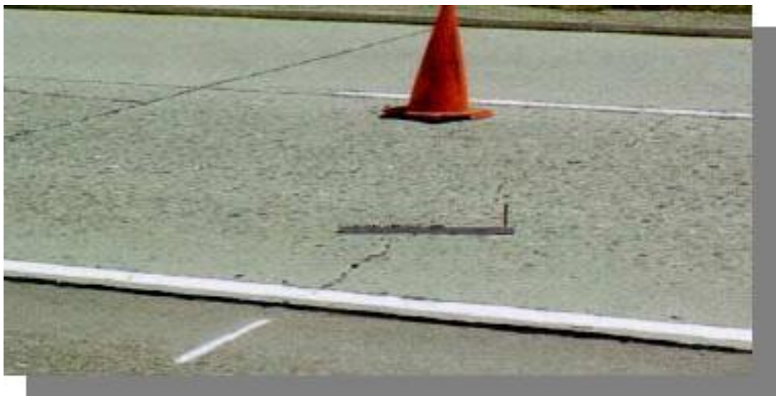
Figura N° 06: Vista típica de una Grieta Diagonal.
