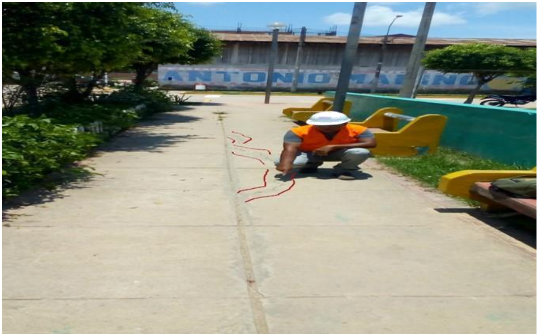
Figura N° 79: Paño de vereda del parque de esparcimiento Roca Fuerte, con la patología Grieta Lineal, con severidad media.
