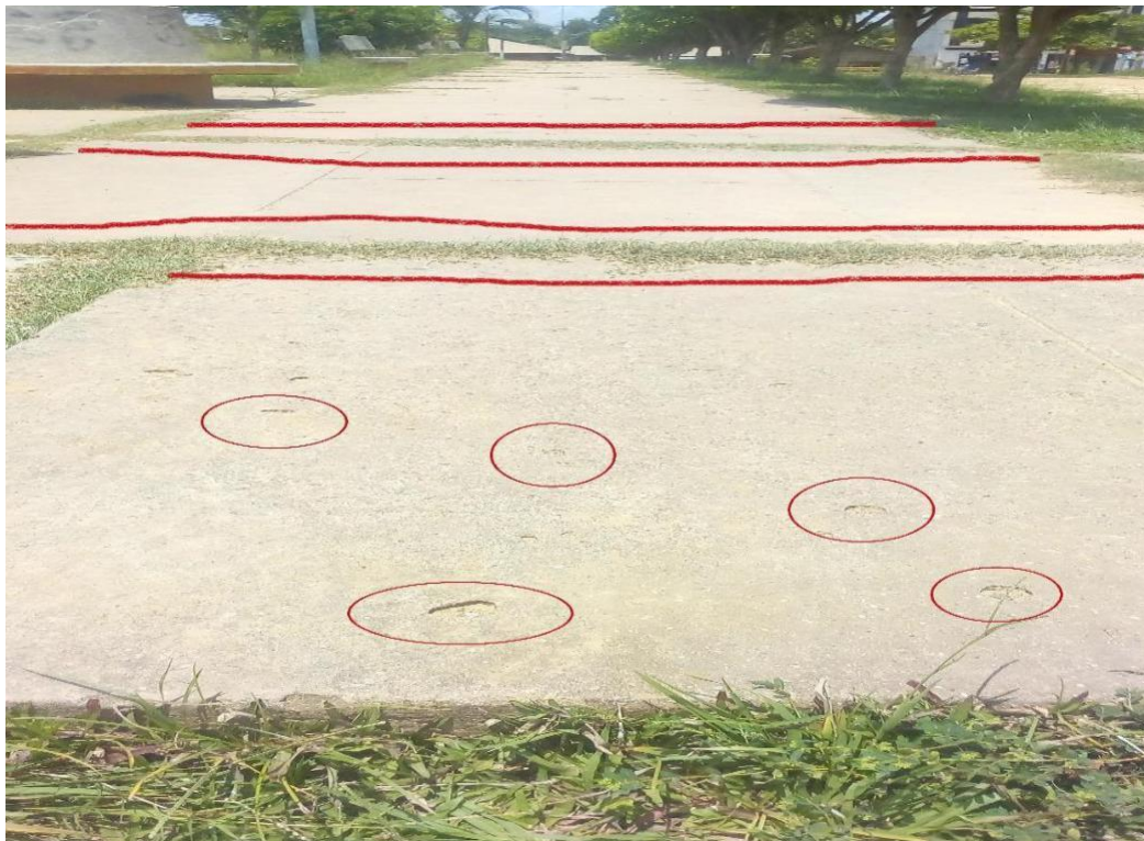
Figura N° 75: Paño de vereda del parque de esparcimiento Siete de Junio, con las patologías Grieta Lineal y Popouts.
