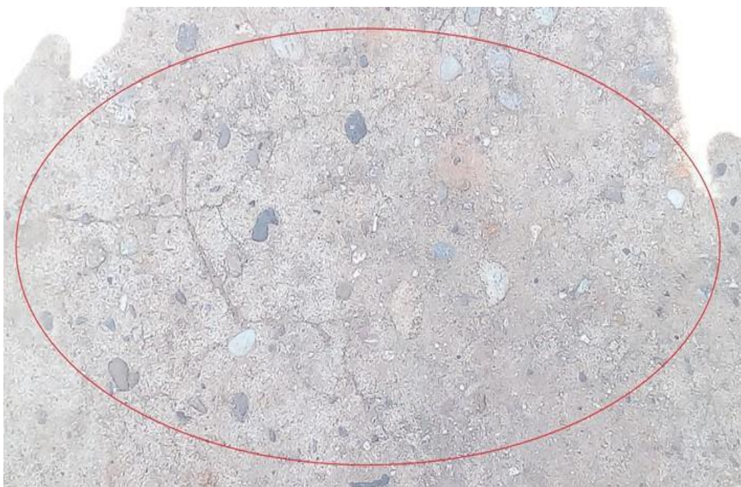
Figura N° 88: Paño del parque de esparcimiento Santa Rosa de Lima, con la patología Pulimento de Agregados, sin severidad.
