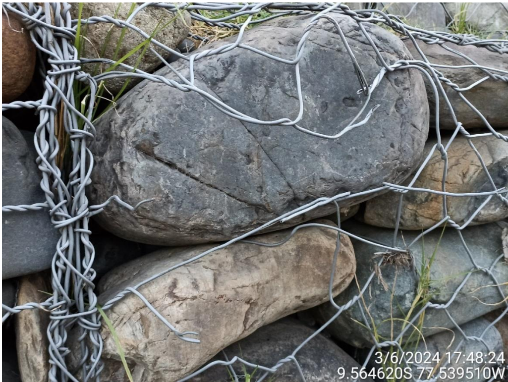
Fotografía 10: Se evidencia rotura de malla en el km 0+060
