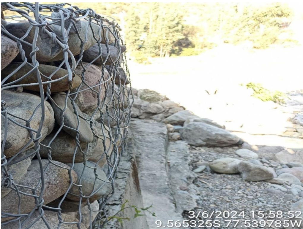
Fotografía 02: La base del muro presenta socavación en el km 0+010
