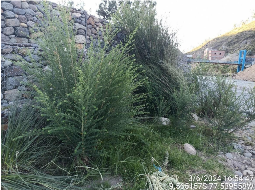
Fotografía 09: Se evidencia presencia de vegetación en el km 0+050
