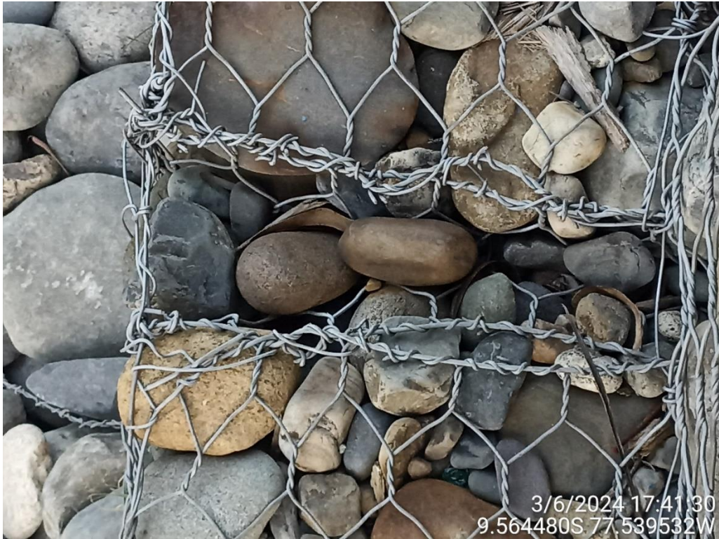
Fotografía 13: Se evidencia separación de los refuerzos de los bordes, km 0+080
