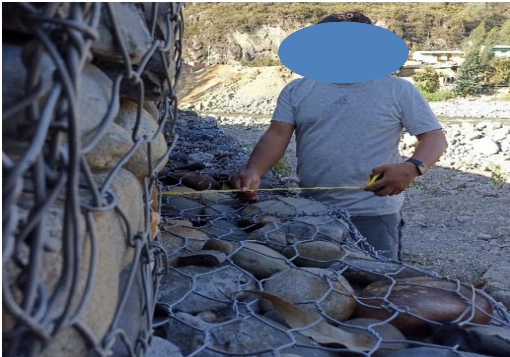
Fotografía 04: Se observa deformación horizontal y vertical en el segundo y tercer nivel del muro, en el km 0+015
