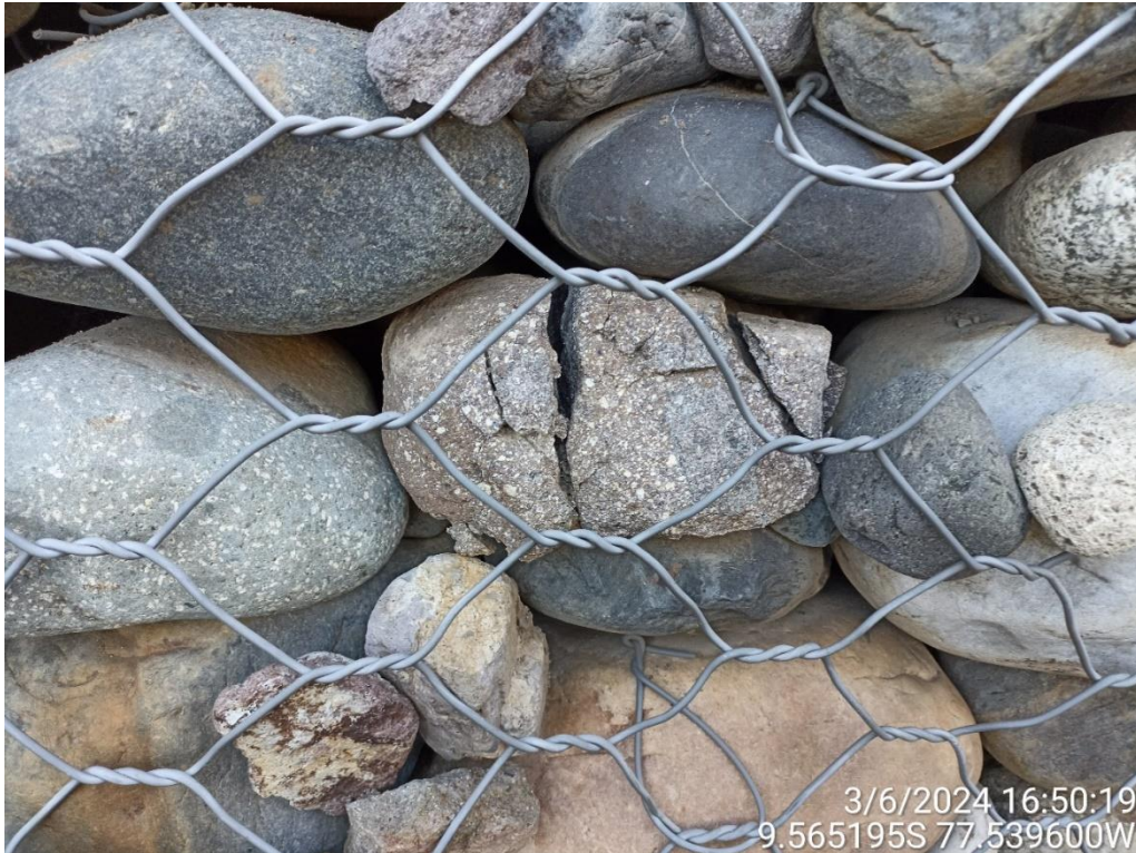
Fotografía 03: Se evidencia rocas de mala calidad, no resisten la compresión, en el km 0+015
