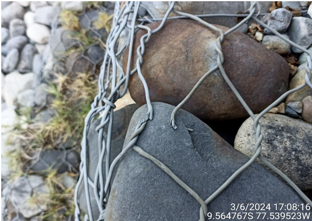
Fotografía 10: Se evidencia rotura de malla en el km 0+100
