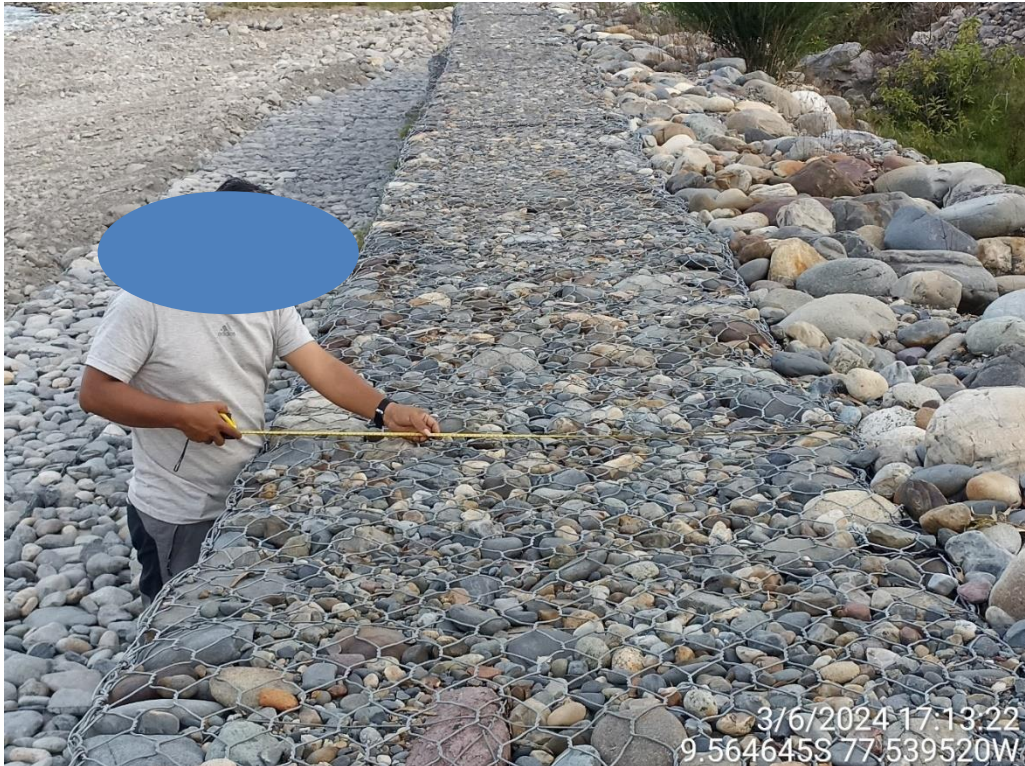
Fotografía 15: Se observa deformación en el tercer nivel del muro, en el km 0+090
