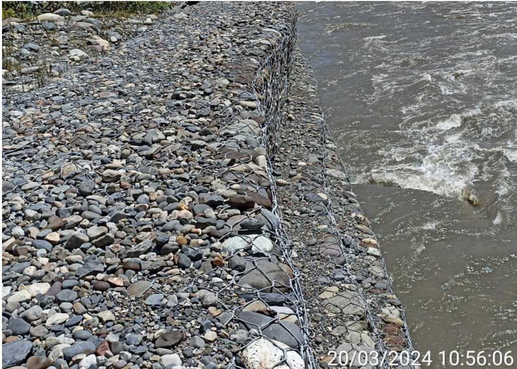
Fotografía 11: Se observa deformación en el tercer nivel del muro, en el km 0+070
