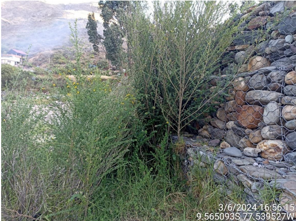
Fotografía 05: Se evidencia presencia de vegetación en el km 0+020
