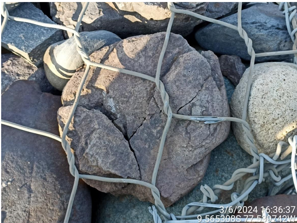
Fotografía 08: Se evidencia rocas de mala calidad, no resisten la compresión, en el km 0+040
