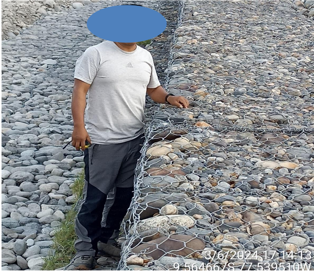
Fotografía 10: Verificando rotura de malla en el km 0+100
