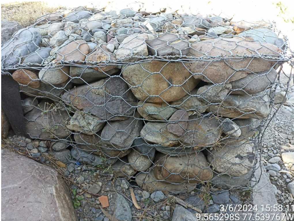
Fotografía 01: Se observa deformación en el tercer nivel del muro, en el km 0+000
